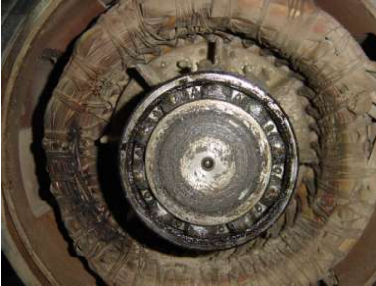
Figura N° 7. Fotografía Falla por rodamiento
