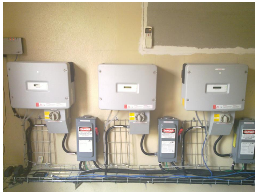
Figura 3.3 Vista de los 3 inversores Sunny Boy A, B y C
