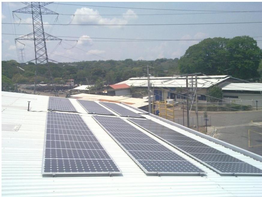
Figura 3.1 Paneles solares sobre el techo de una estructura dentro del ICE barranca
