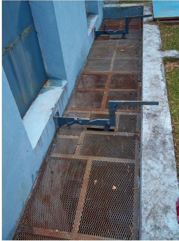
Figura A.39 Válvulas para lavado por de la planta de tratamiento Quebrada Tarbaca. Fuente Elaboración Propia.
