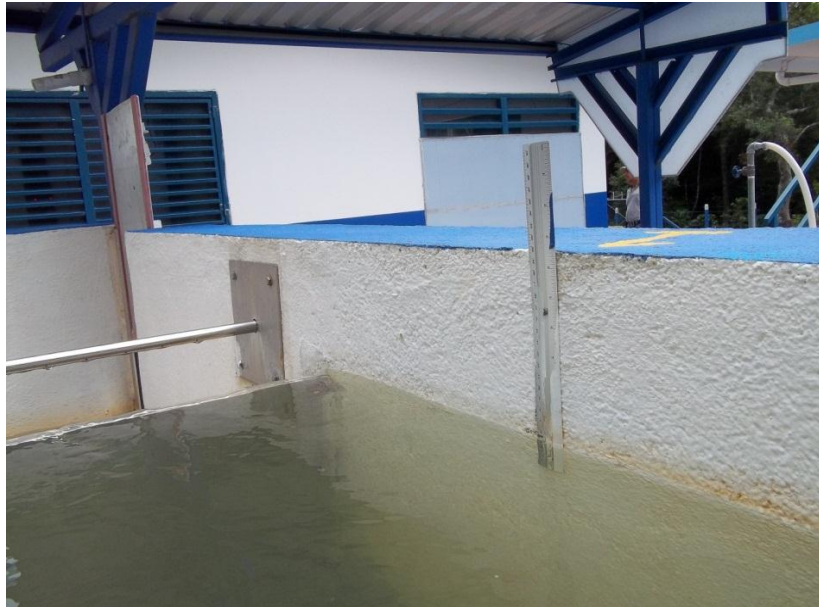
Figura 4.10 Regla colocada en la pared de la cámara de entrada por personeros de AyA. Fuente: Autor
