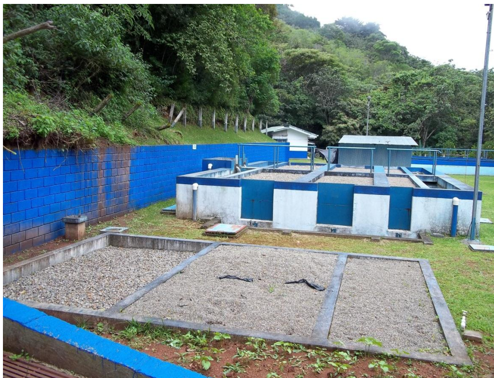
Figura A.6 Planta de tratamiento de Filtración Lenta Quebrada Tarbaca.
