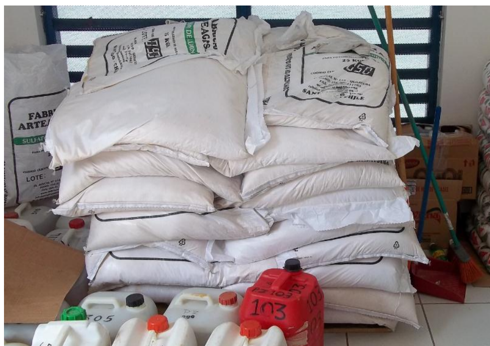
Figura A.19 Almacenamiento de sacos de coagulante en la planta El Tigre. Fuente Elaboración Propia.
