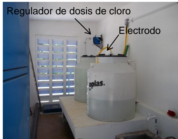
Figura A.31 Sistema de suministro de cloro de la planta El Tigre. Fuente Elaboración Propia.
