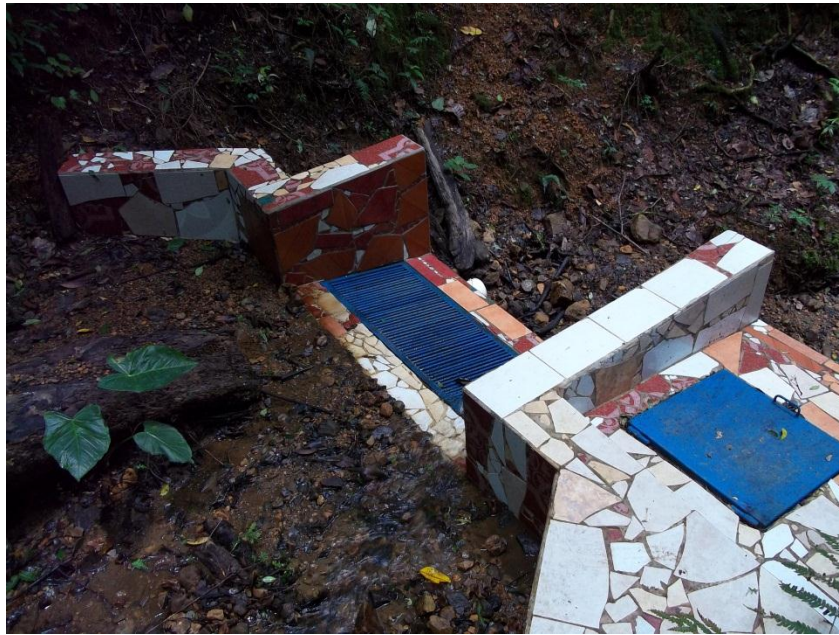
Figura 4.21 Rejillas de captación de agua de la Quebrada Tarbaca Fuente: Autor.
