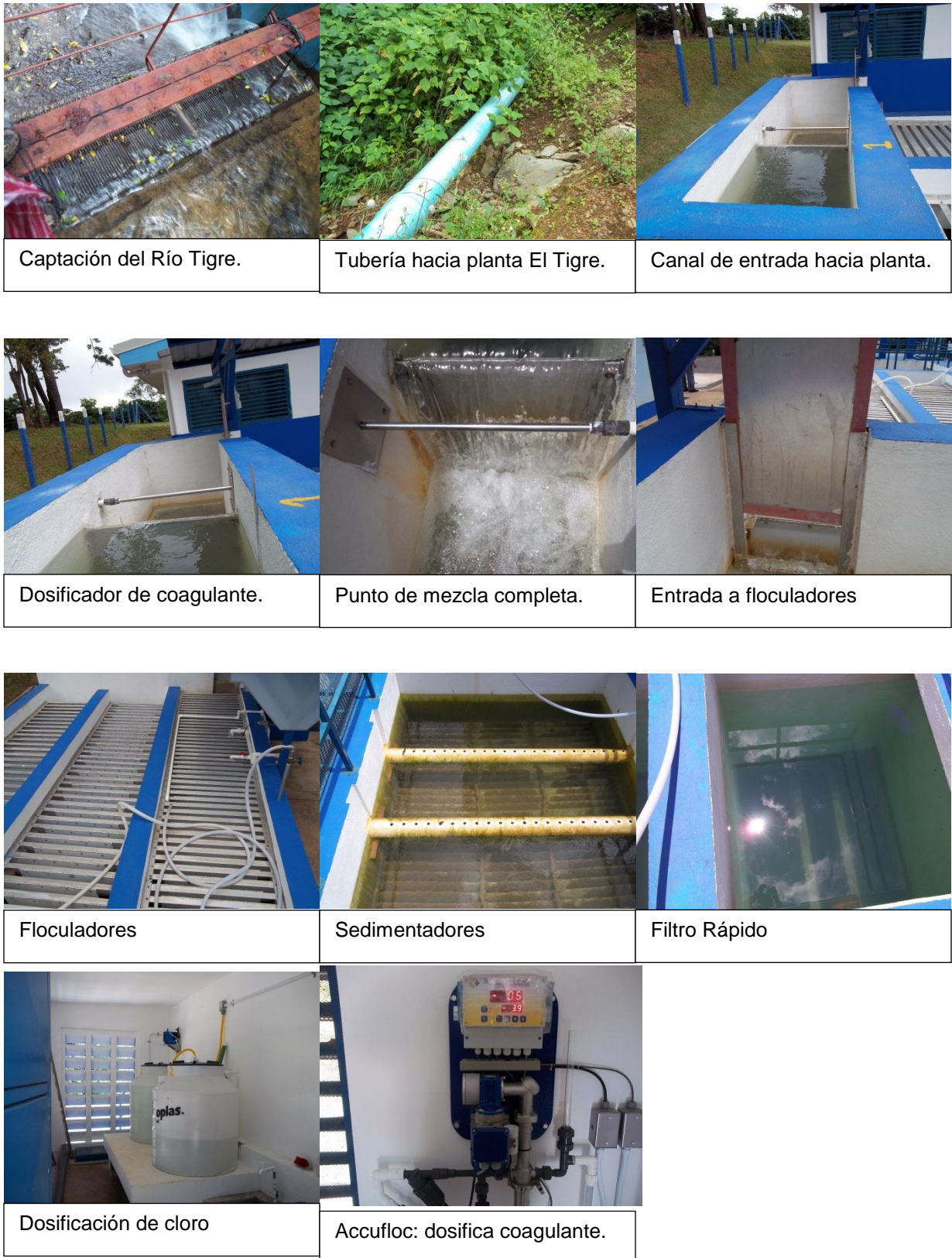
Figura A.9 Descripción Gráfica de los principales procesos unitarios de la Planta de Tratamiento El Tigre. Fuente: Autor.
