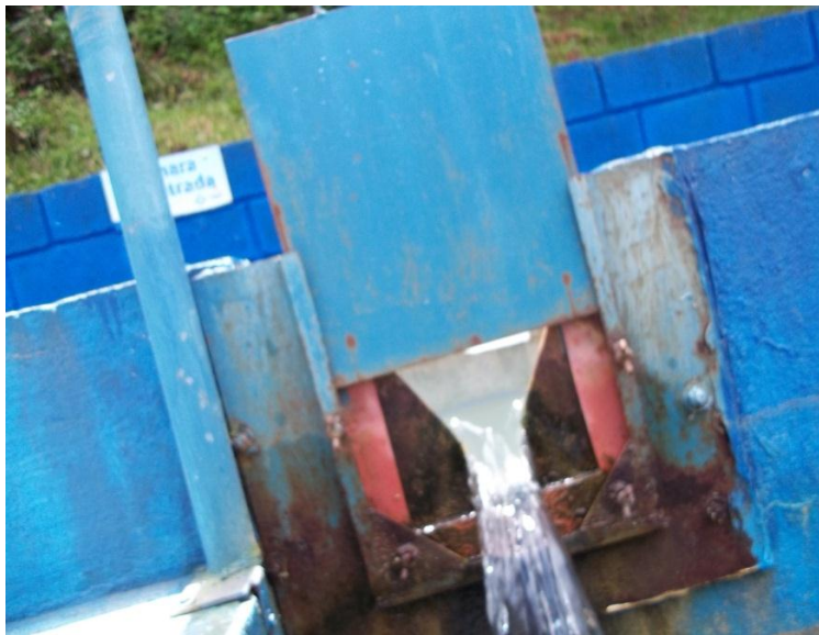
Figura 4.23 Vertederos de la cámara de entrada del Sistema Quebrada Tarbaca. Fuente: Autor.
