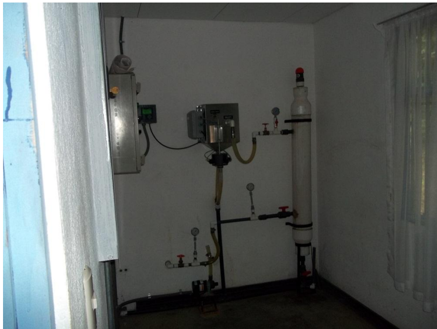
Figura A.42. Sistema automático de control de turbiedad. Fuente Elaboración Propia.
