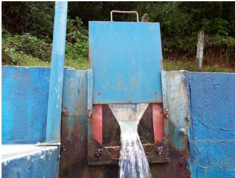
Figura 5.3 Vertedero de cámara de entrada de la Planta Tarbaca. Fuente: Autor.
