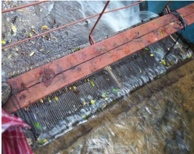
Figura 4.1 Captación de fondo del agua en Río Tigre para el Sistema de Tratamiento. Fuente: Autor.
