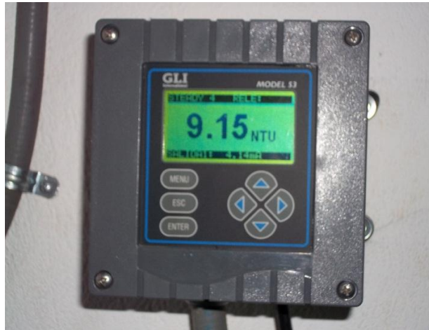
Figura A.43. Lector de turbiedad en Unidades nefelométricas de turbiedad de la planta Quebrada Tarbaca. Fuente Elaboración Propia.
