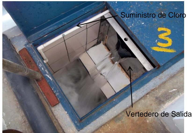
Figura A.30 Cámara de salida. Fuente Elaboración Propia.
