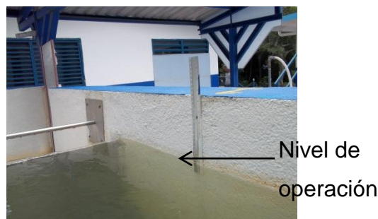
Figura A 33. Ilustración del nivel de operación normal en la planta de tratamiento El Tigre. Fuente Elaboración Propia.
