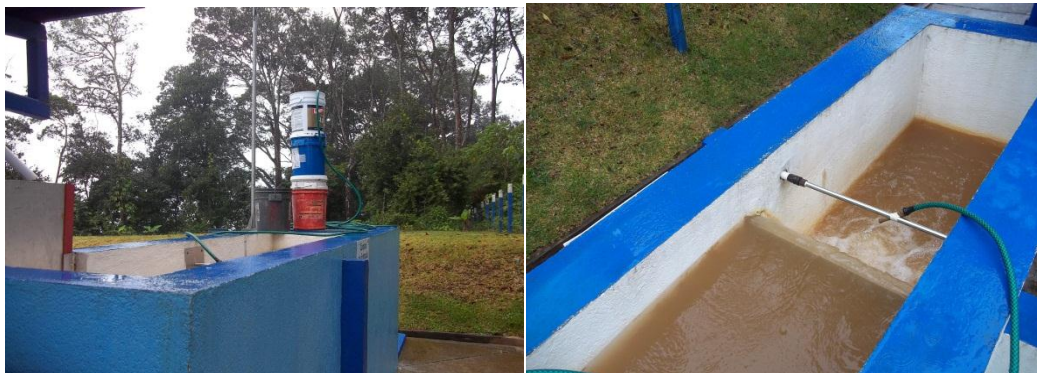
Figura A.35 Dosificación de sulfato de aluminio en caso de no tener electricidad. Fuente Elaboración Propia.
