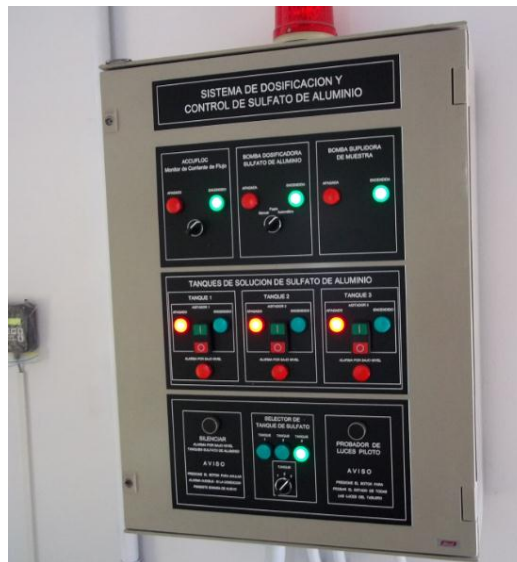
Figura A 21. Panel de control eléctrico para el sistema de dosificación de coagulante. Fuente Elaboración Propia.
