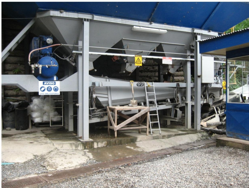
Figura 1.1. Planta de concreto MYPESA, en Tucurrique.
