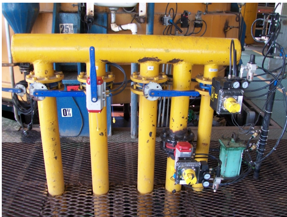
Figura B.4.2. Válvulas Automáticas del Tacho #9.
