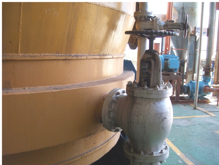
Figura 6.9 Válvula mecánica para alimentar vapor.
