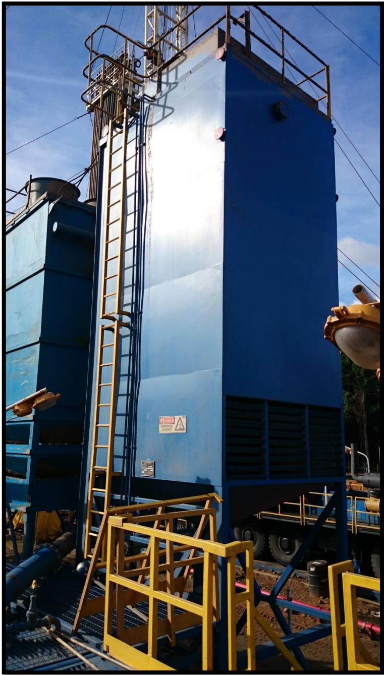
Figura 4.6 Torre de enfriamiento instalada
