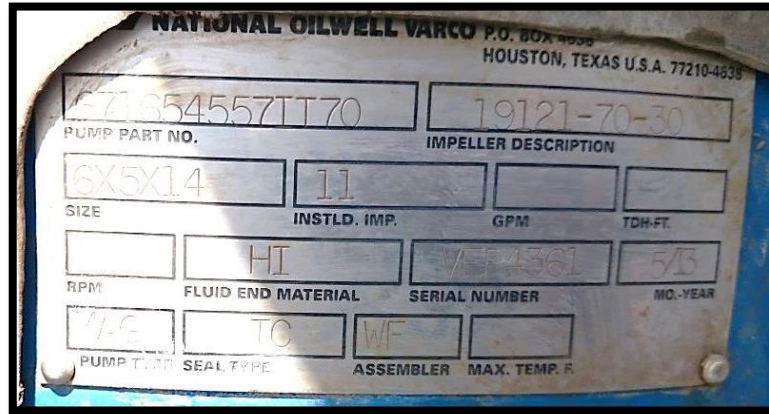
Figura 4.10 Dato de placa de bomba centrífuga Magnum I
