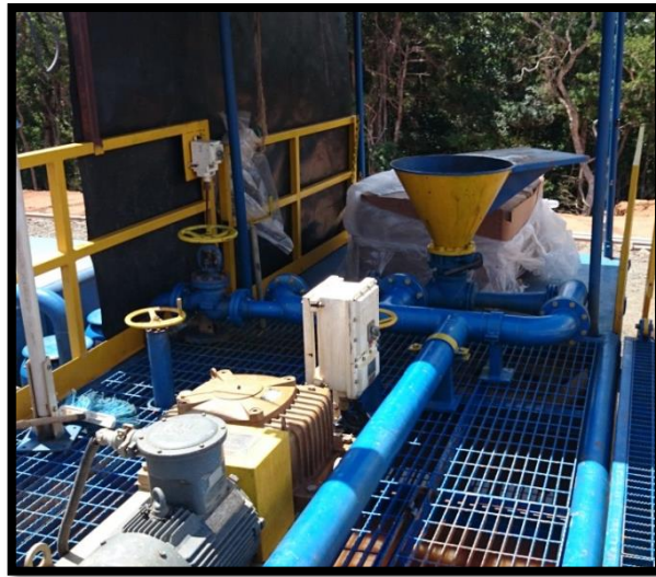
Figura 4.7 Sistema de adición de aditivos
