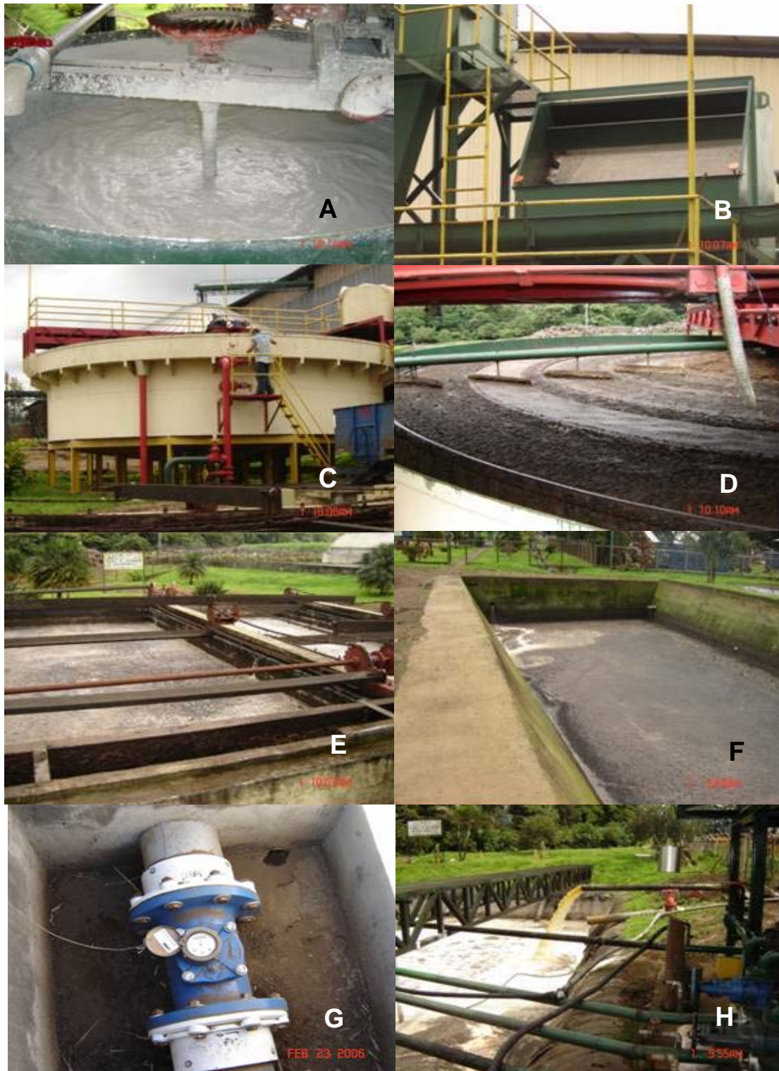
Figura 3. Sistema de Tratamiento de Aguas Residuales de CoopeVictoria. A, Tanque mezclador-dosificador de cal. B, Tamiz. C y D, Clarificador. E, Sedimentador. F, Laguna de lodos. G, Medidor de caudal. H, Laguna anaerobia (salida del agua para riego).
