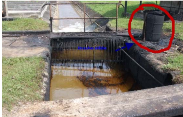
Figura 4. Una de las rejillas y a la par un recipiente para la recolección de sólidos.
