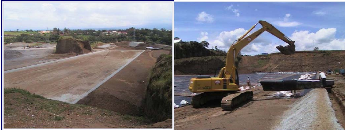
Figura 41. Base conformada para la colocación de la Arcilla con un grosor de 60 cm.
