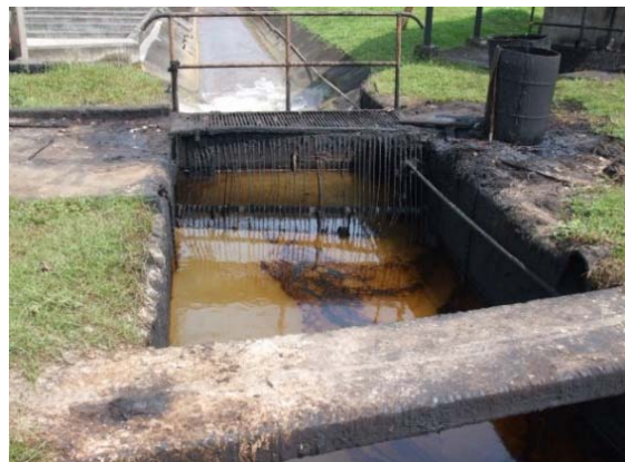
Figura 47. Punto para la dosificación de Coagulante
