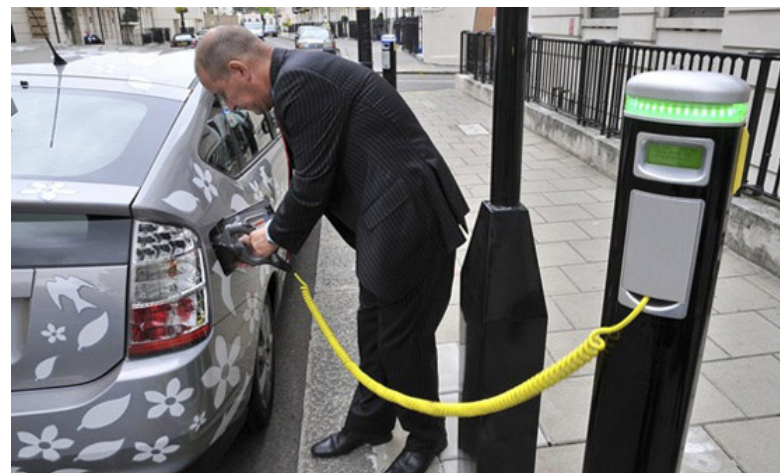
Imagen 17. Estación de servicio de recarga para vehículos eléctricos
