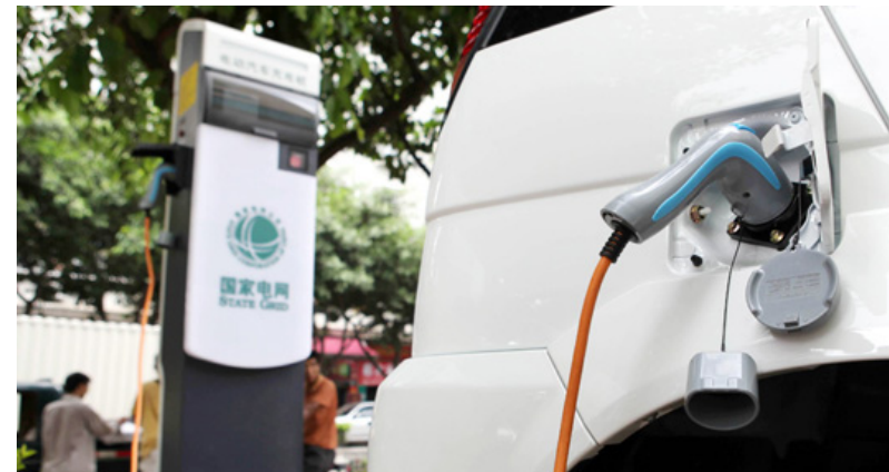
Imagen 12. Estaciones de recarga para vehículos livianos eléctricos (LEVs)
