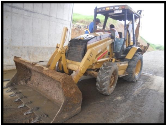
Figura 27. Back Hoe empleados en la actividad de Colocación de Material de Préstamo.
