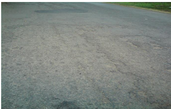
Figura 2. Tratamiento superficial deteriorado Siguiendo con el tema de los tratamientos superficiales bituminosos, se evidenció que el bacheo con mezcla asfáltica es la técnica de mantenimiento más utilizada.
