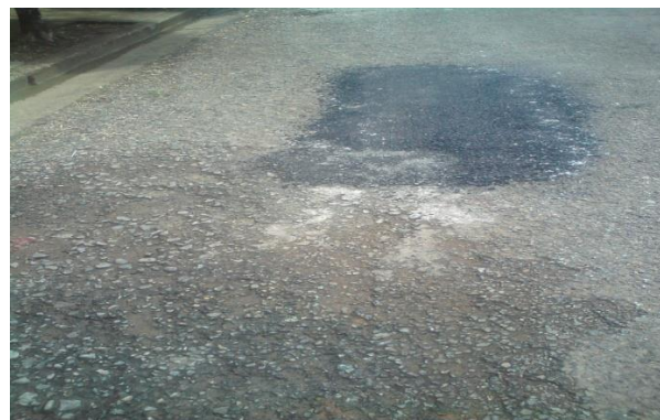
Figura 3. Bacheo realizado el 29 de abril de 2010, el tratamiento en general presenta altas condiciones de deterioro.
