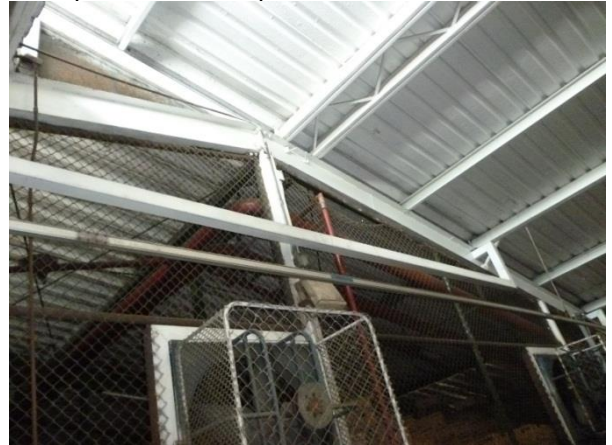
Figura 38. Estructura de Techos que necesita mantenimiento.
