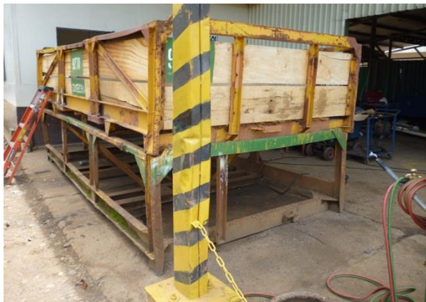
Figura 7. Columna dañada Taller Empacadora.
