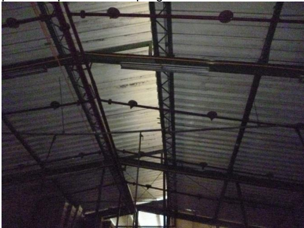
Figura 21. Sistema contra incendios Bodega Cartón
