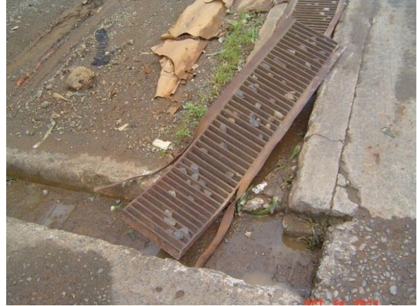
Figura 60. Desagüe Zona de Carga Cajones de Fruta
