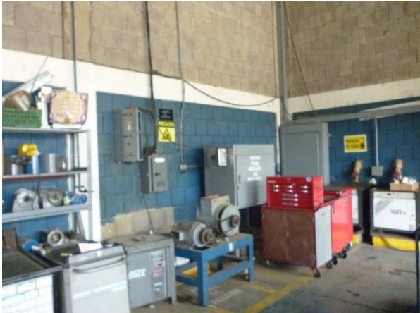
Figura 9. Cuarto de máquinas Taller Empacadora.
