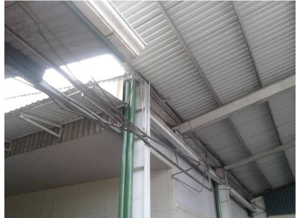
Figura 45. Instalación eléctrica insegura..
