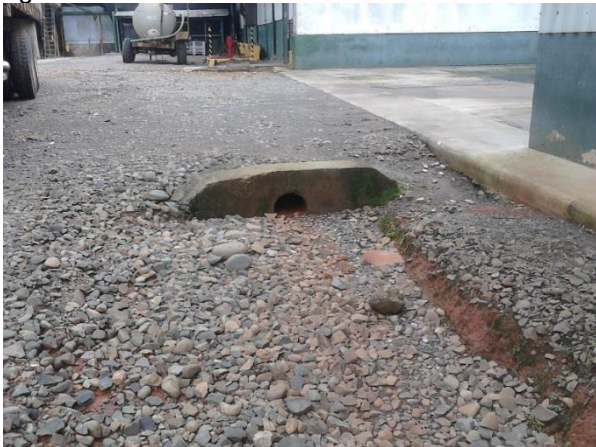
Figura 51. Paso de Alcantarillas Planta Empacadora
