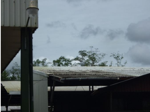
Figura 11. Cubierta de Techos Taller Empacadora, sistema pluvial inadecuado
