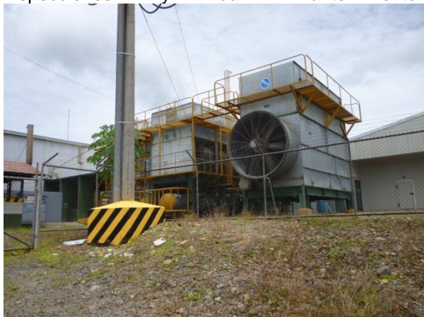
Figura 34. Sistema de refrigeración Aires Forzados
