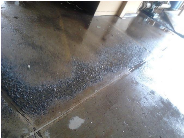
Figura 70. Erosión Superficial en Losas Zona de Descarga de Fruta.
