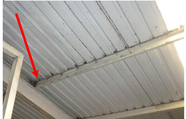
Figura 39. Detalle de larguero con problemas de Infiltración.
