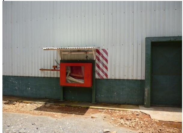
Figura 22. Sistema contra incendios exterior Bodega Cartón
