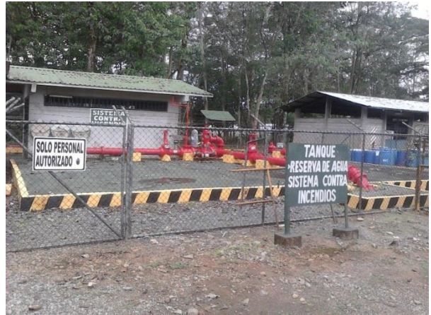
Figura 50. Sistema Contra Incendios Planta Empacadora
