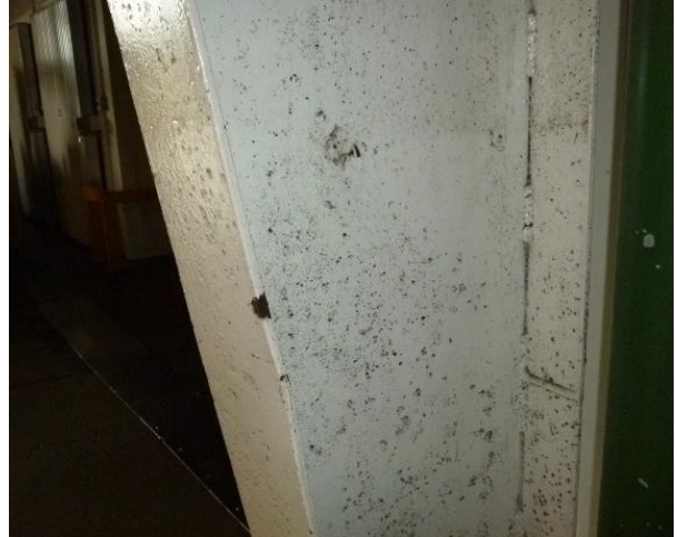
Figura 42. Columna deteriorada Zona de Paletizado
