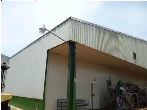
Figura 31. Iluminación Externa Aires Forzados
