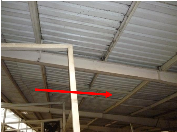
Figura 37. Detalle de larguero Planta Empacadora.
