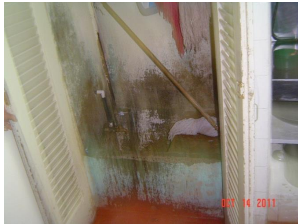
Figura 72. Pileta en armario
