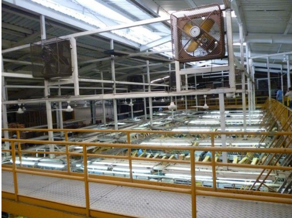
Figura 40. Detalle estructura de Ventilación Planta Empacadora
