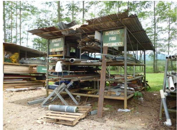
Figura 13. Cubierta de Techos Taller Empacadora, sistema pluvial inadecuado
