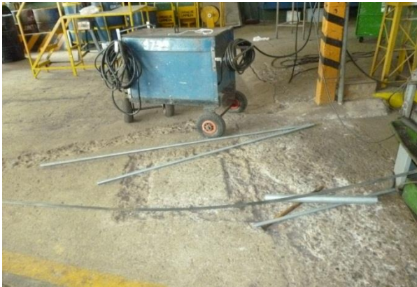
Figura 12. Losa de concreto dañada Taller Empacadora.
