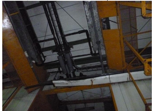
Figura 46. Instalación eléctrica Cuarto Fríos
