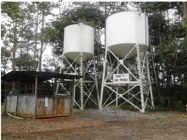
Figura 48. Tanques Agua potable Empacadora
