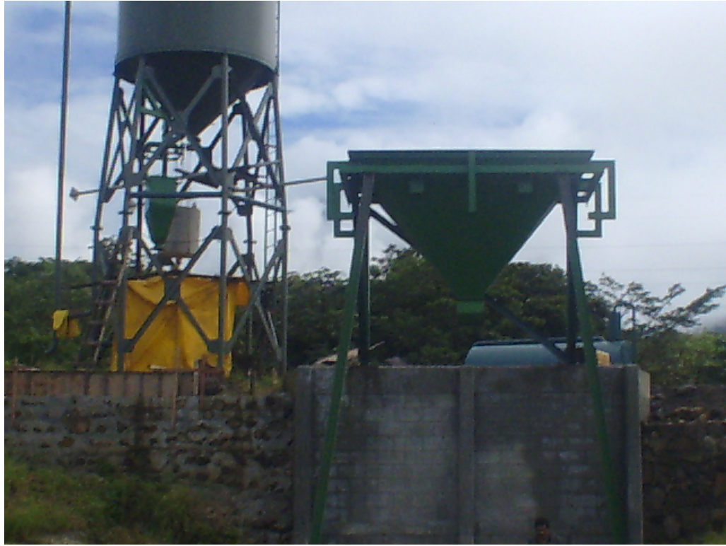
Figura 17: Conjunto mecánico final , fabricado, donde se puede observar tolva de agregados, tanque de agua, tanque de cemento y silo principal del cemento.
