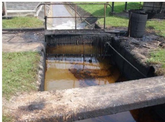
Figura 47. Punto para la dosificación de Coagulante
