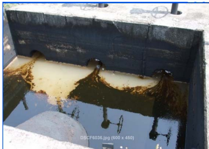
Figura 9. Cámara de preseparación
