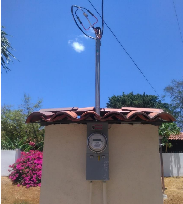
Figura 53. Medidor en entrada principal
