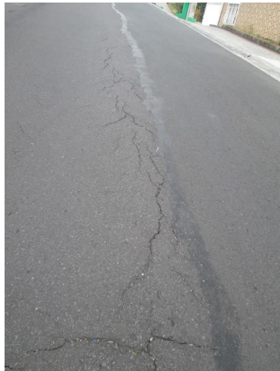
Imagen 5. Agrietamiento longitudinal en la vía de José María Zeledón. Fuente: Propia.
