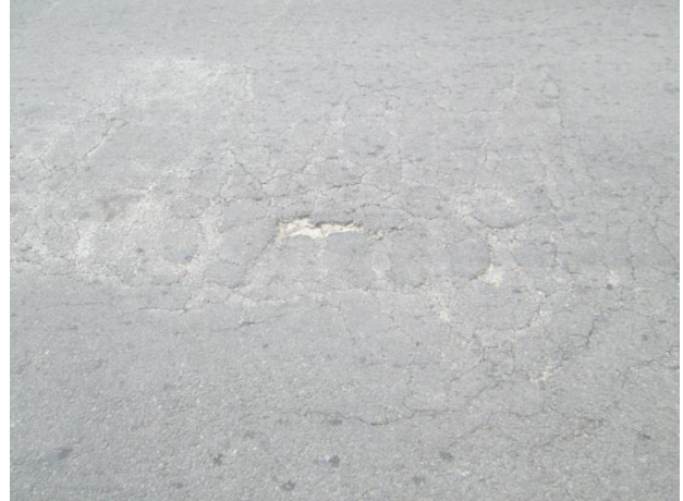
Imagen 4. Desprendimiento que ocasiona huecos de gravedad media-alta. Fuente: Propia.
