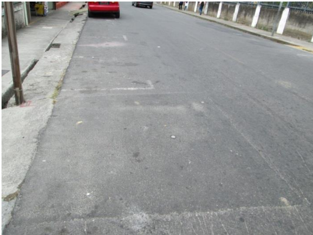
Imagen 3. Bacheos con mediana afectación al conductor cercanías de la iglesia católica de Curridabat centro. Fuente: Propia.
