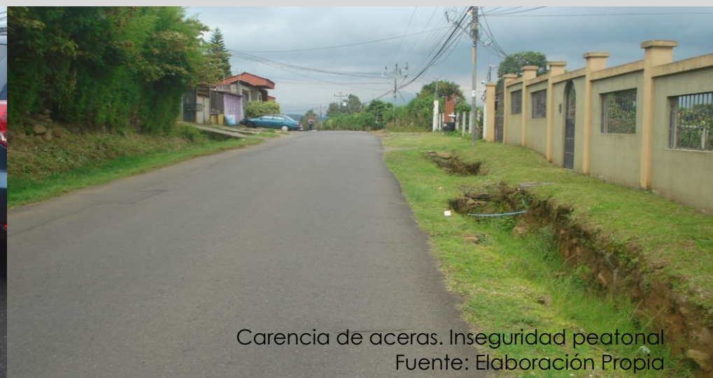
Aceras en mal estado en el casco central Fuente: Elaboración Propia
