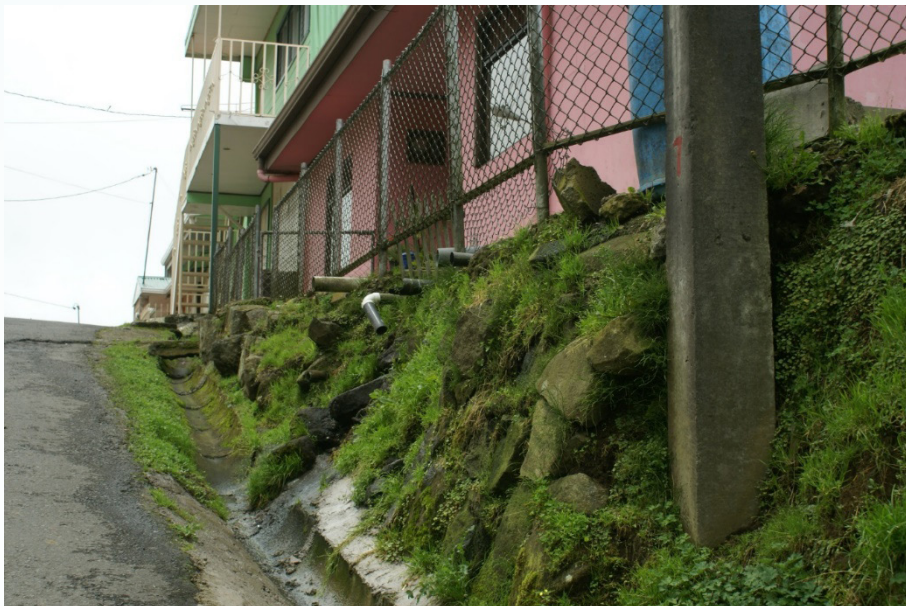
Figura 5.1. Descarga de agua residual gris a sistema de recolección agua lluvia.
