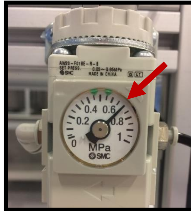
Figura 6. Manómetro de aire comprimido.
