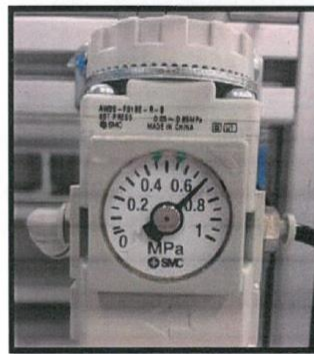
Figura 1. Manómetro de aire comprimido
