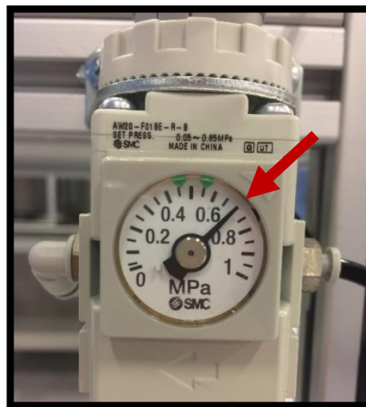
Figura 1. Manómetro de aire comprimido.
