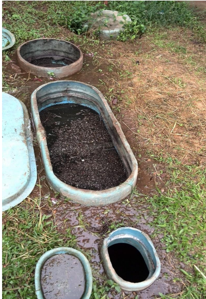
Fotografía 5. Vista en Planta del Sistema de Tratamiento de Casa
