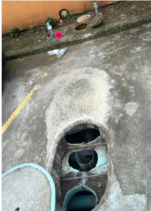
Fotografía 1. Vista en planta del Sistema de Tratamiento de Apartamentos.
