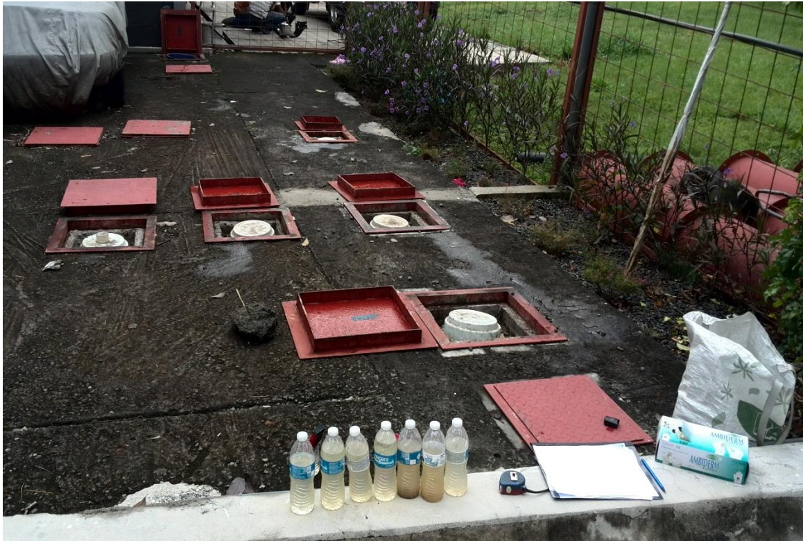
Fotografía 3. Vista en planta del Sistema de Tratamiento de Condominios.
