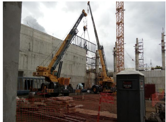
Figura 13. Grúas encargada del montaje de la armadura de techo colocando estructuras secundarias.
