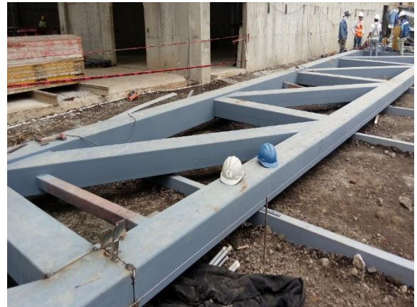
Figura 12. Alineado, soldado y preparación de la cercha principal antes de su montaje.
