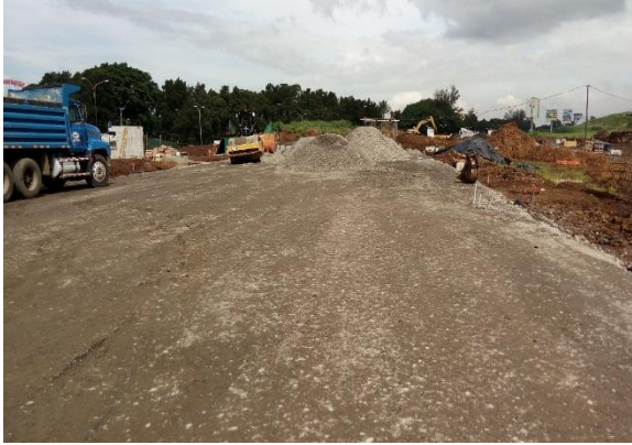
Figura 9. Terreno lastreado con subbase en parqueos y su acabado con conformadora y compactadora.
