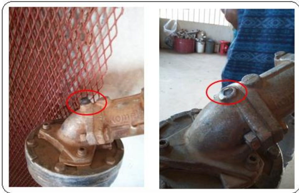
Fotografía 6. Desgaste del tapón donde se coloca el manómetro Fuente: Elaboración propia, 2017
