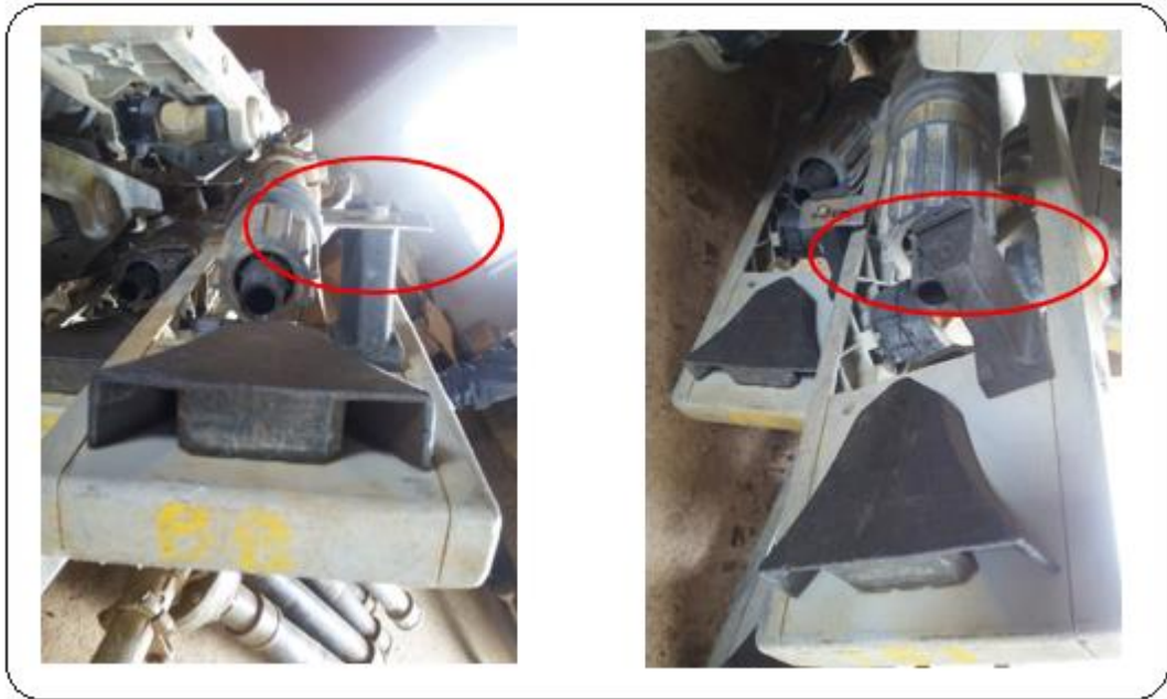
Fotografía 5. Faltante de la cuchilla rompe chorros Fuente: Elaboración propia, 2017
