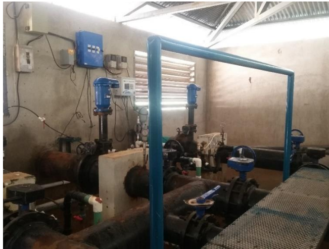
Fotografía 3. Cuarto de cloración Fuente: Elaboración propia, 2017
