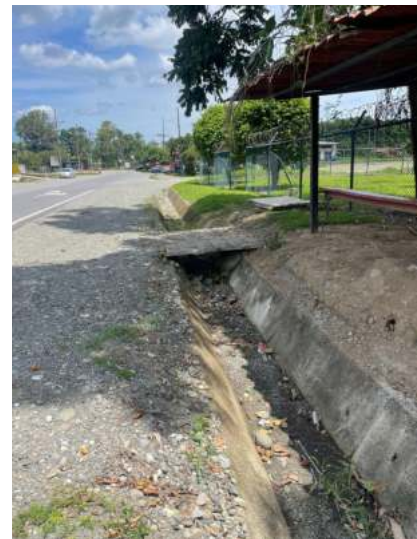
Figura 3.35 Imagen propia de alcantarillado pluvial
