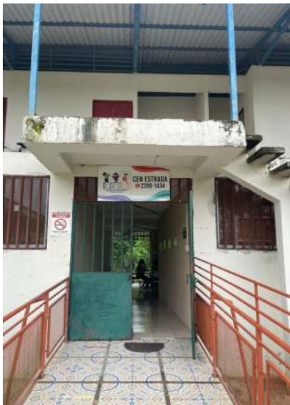
Figura 3.51 Imagen propia de daños estructurales en el CEN
