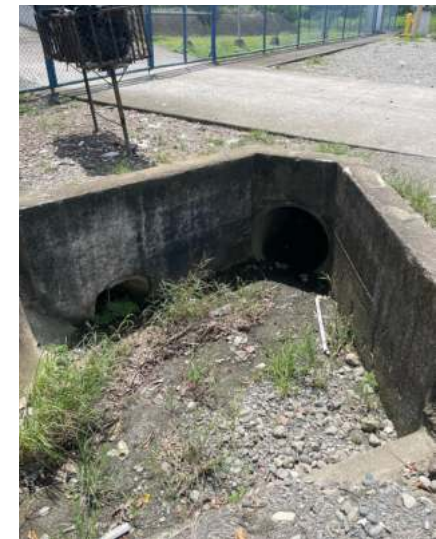
Figura 3.36 Imagen propia de drenaje pluvial
