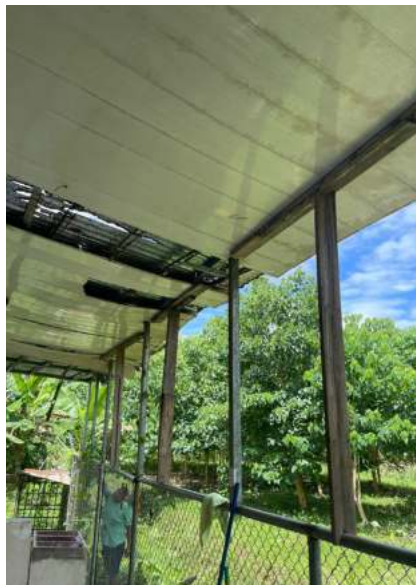
Figura 3.52 Imagen propia de daños por humedad en el CEN
