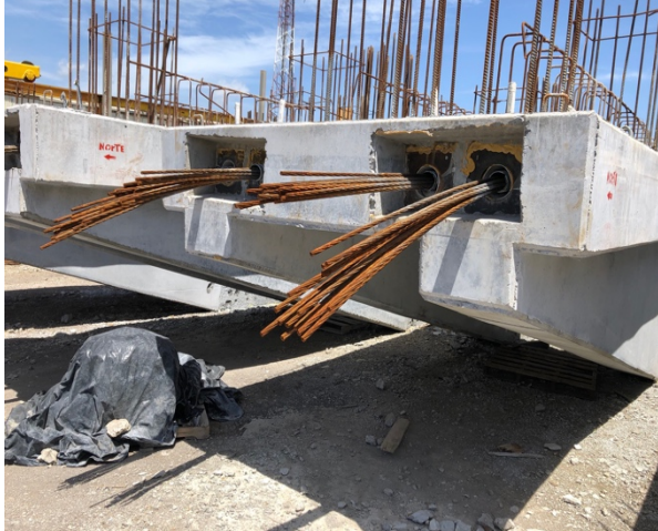
Fotografía 7. Presencia de óxido de hierro en los torones de los dinteles.
