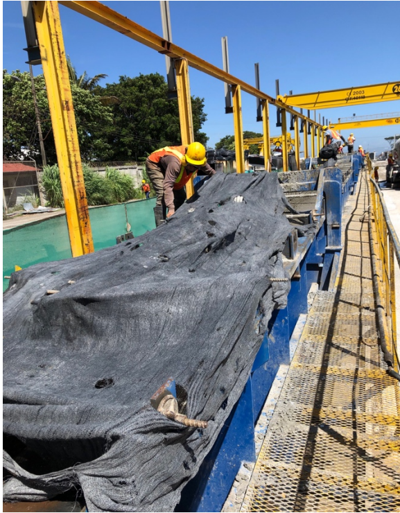
Fotografía 17. Protección de la viga con un Sarán (con huecos), a medio día.
