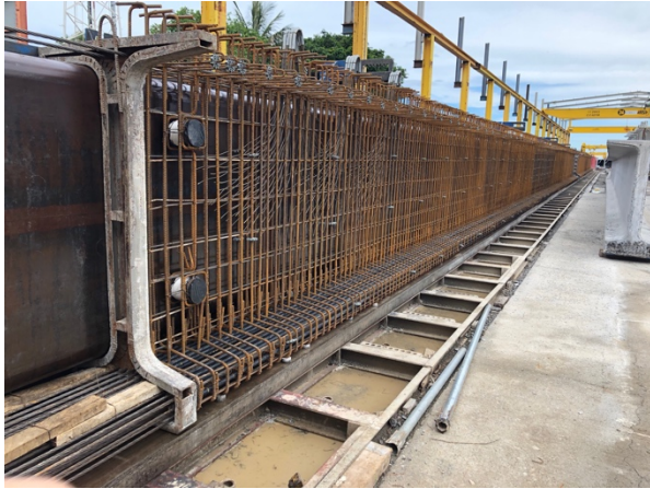
Fotografía 11. Montaje de viga en un encofrado limpio y acero con oxidación.
