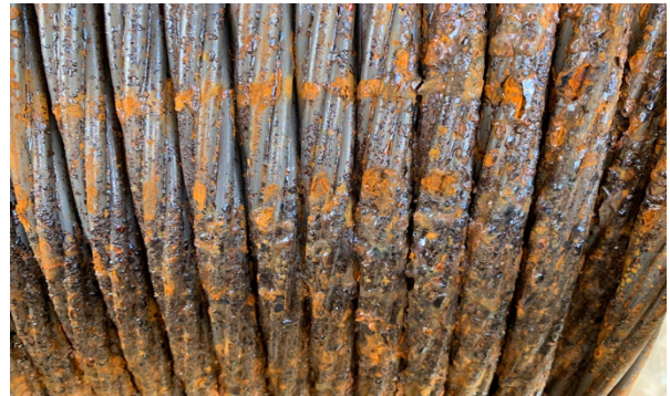
Fotografía 19. Acero de presfuerzo con oxidación.
