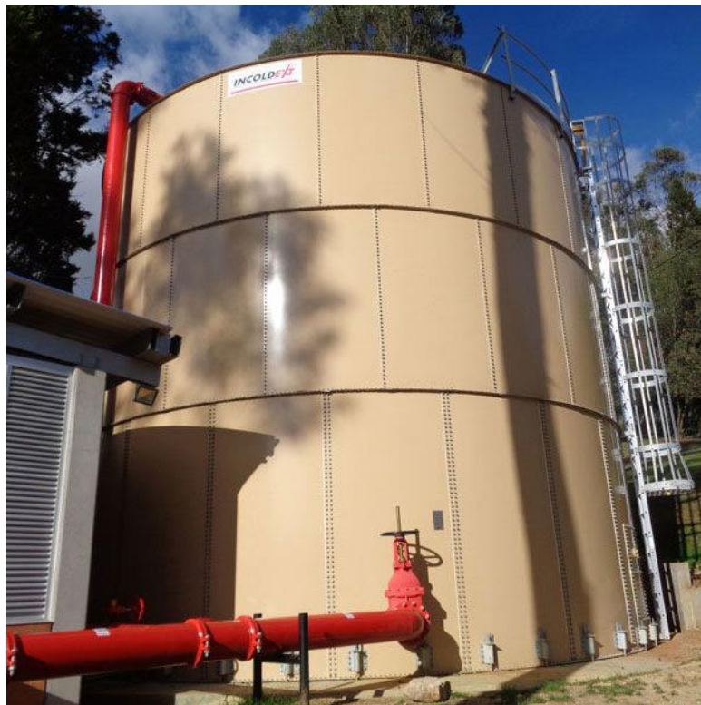
Figura 23. Ejemplo de tanque contra incendios de acero atornillado.
