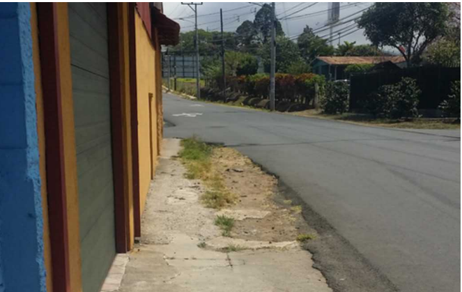
Imagen C2.31 Segmento 53, sedimentos y desprendimiento del pavimento
