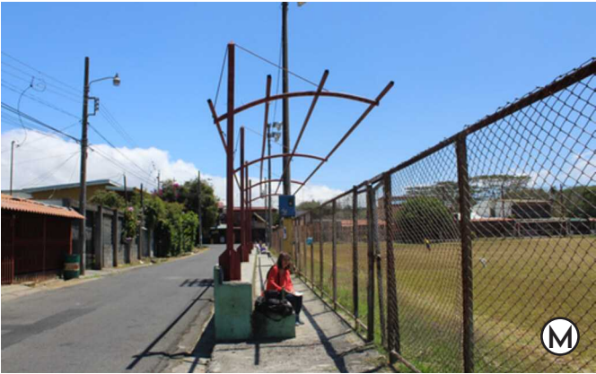
Imagen C2.57 Graderías en mal estado, sector norte
