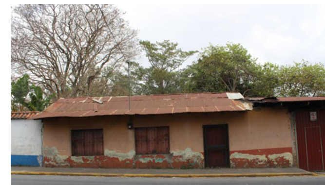
Imagen C2.16 Casa de adobe en mal estado
