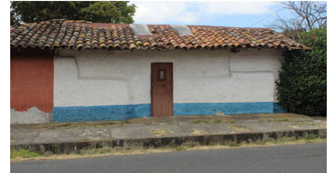
Imagen C2.5 Casa de adobe en estado de deterioro, presenta reparaciones en madera y zinc
