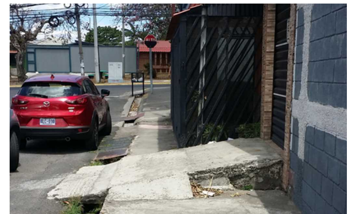
Imagen C2.28 Segmento 31, pendiente transversal inadecuada
