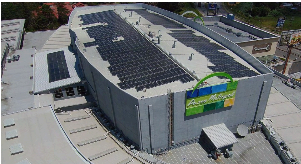
Figura 133: Paneles fotovoltaicos. Fuente: SUNSHINE.
