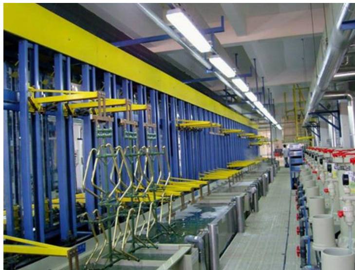
Figura 3.9 Línea de galvanoplastia con estructuras en voladizo [26].
