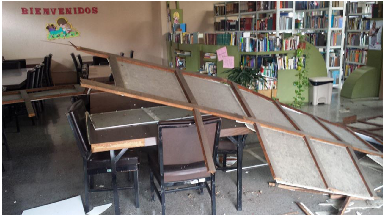
Imagen 14. Caída de estructura de Cielo raso 01 de Octubre 2015. Fuente: Noticias de Occidente.
