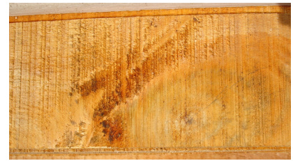
Rajaduras y grietas por cabeza en madera seca de jául
