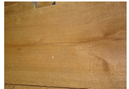
Grietas en madera seca, asociado a la presencia de medula
