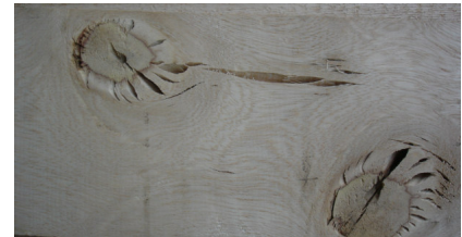
Presencia rajaduras y grietas asociadas a nudos en madera seca
