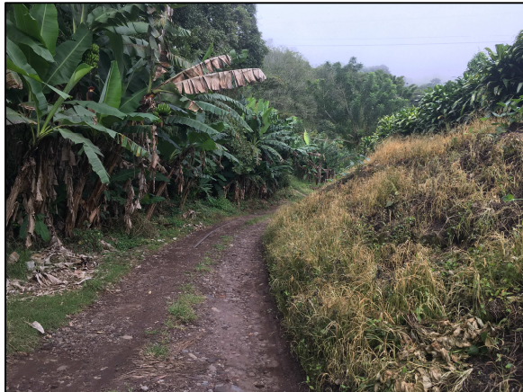
Figura 27. Punto 8. Derrumbe invadiendo derecho de vía.
