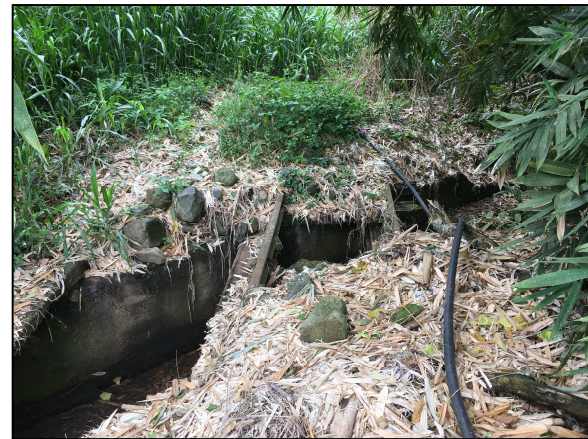
Figura 42. Punto 27. Requerimiento de alcantarillas.
