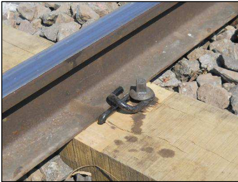
Figura 7. Fijaciones a durmientes de madera.
