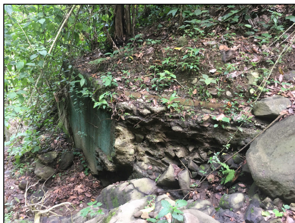
Figura 66. Punto 113. Bastión Margen Derecha de puente destrizado por un deslizamiento.
