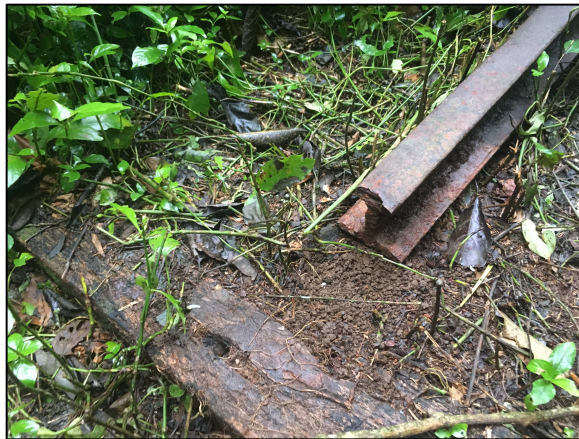
Figura 77. Durmientes de madera, en mal estado.
