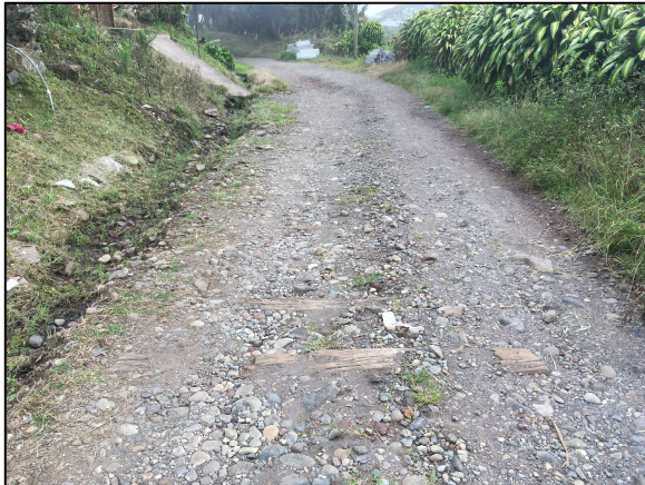
Figura 88. Deterioro de traviesas por tránsito vehicular.
