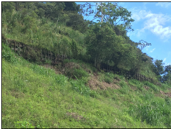
Figura 31. Punto 12. Fin de derrumbe y necesidad de muro de contención.
