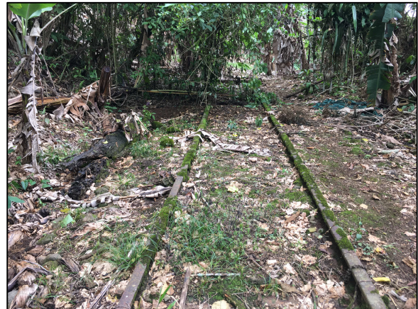
Figura 48. Estado de rieles en zonas donde se permitía su visibilidad.
