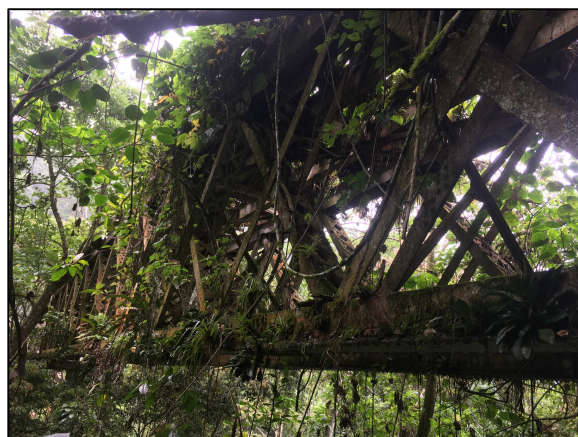
Figura 60. Estado actual de Puente sobre Río Chiz. Tramo que no se derrumbó de la estructura.
