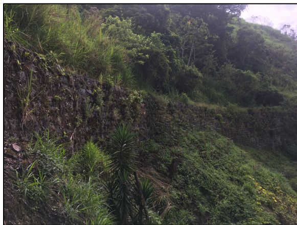
Figura 53. Punto 52. Muro de contención a base de rocas sobrepuestas. No cuenta con material de pega ni acero entre bloques.
