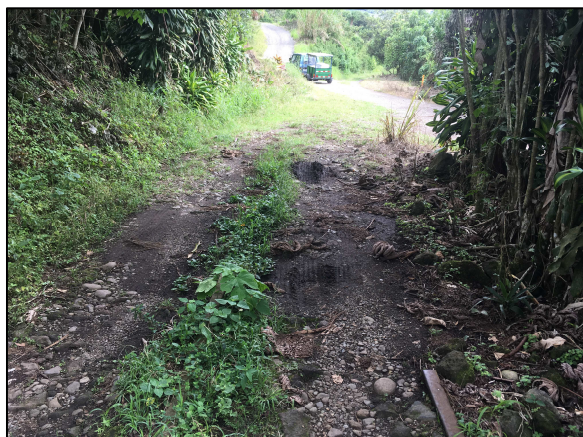
Figura 33. Punto 15. Intersección de camino con vía férrea. No se cuenta con rieles ni balasto.
