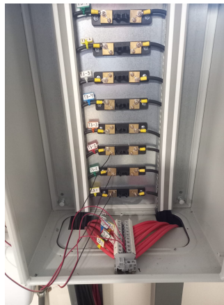
Figura 5.10: Resistencias Shunt en arreglos de paneles fotovoltaicos en el SESLab
