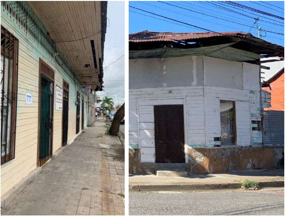
Figuras 113 y 114 Inmuebles de arquitectura vernácula en deterioro. Autoría propia
