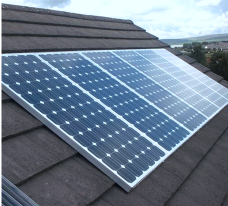
Figura 5-51. Fotografía de ejemplo de paneles solares instalados sobre cubiertas.
