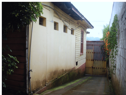
Figura 4-5. Fotografía del acceso al parqueo, costado oeste de la casa, sector con daños físicos mayores.
