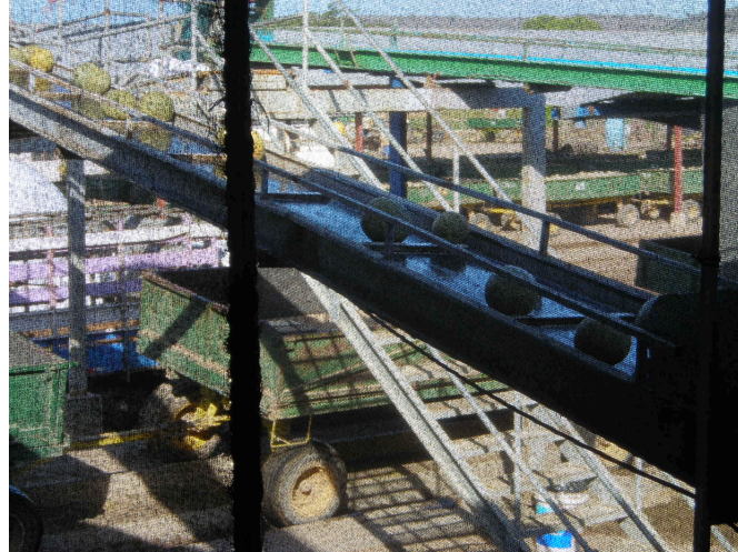
Figura 27. Banda transportadora con fruta de descarte, melón ( C. melo ) variedad Cantaloupe. Planta empacadora de la Finca Melones de Costa Rica 1. Bagaces, Guanacaste. Temporada 2005-2006.
