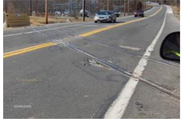
Figura 20. Falla de alta severidad en cruce de línea férrea. Fuente: (MOPT, 2016).
