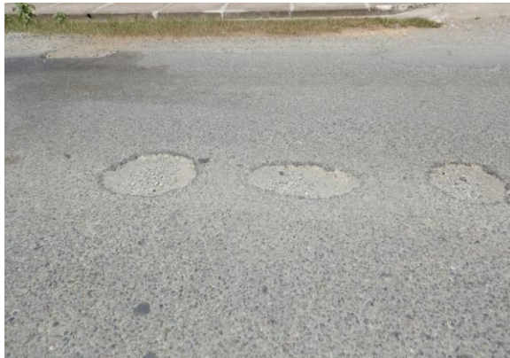
Desgaste superficial y baches de alta severidad.
