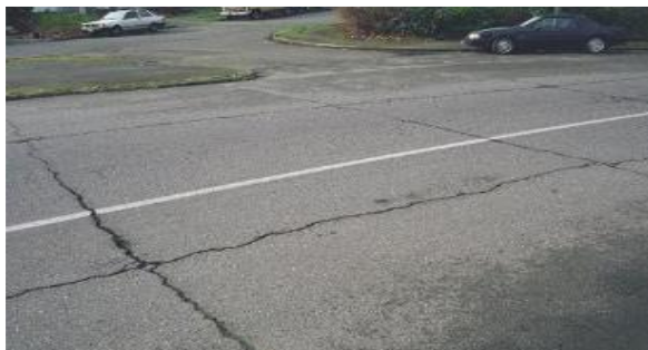
Figura 5. Grieta por reflexión de juntas de severidad media. Fuente: (MOPT, 2016).
