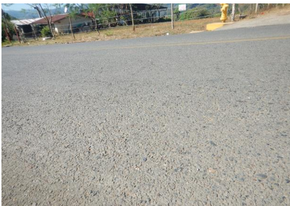
Desgaste superficial de alta severidad.
