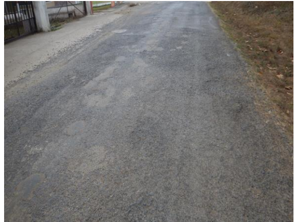
Desprendimiento de agregados.
