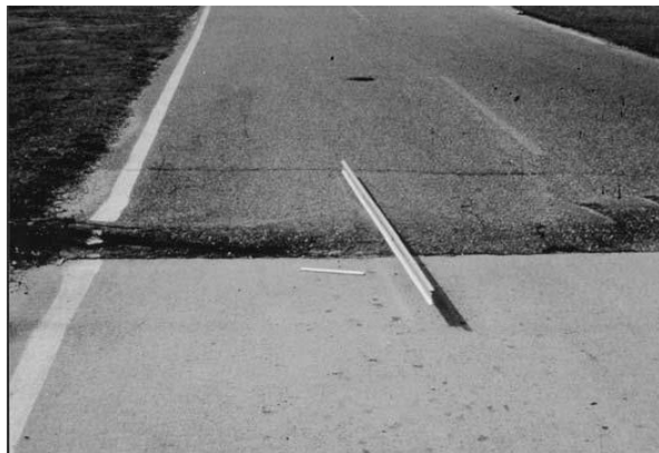
Figura 12. Desplazamiento de alta severidad. Fuente: (American Society for Testing and Materials, 2018).
