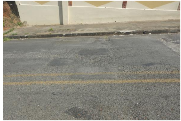
Parches de mediana severidad.
