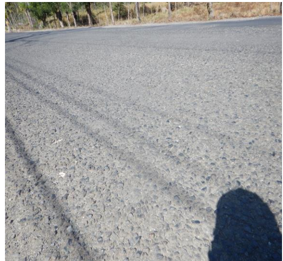
Desprendimiento de agregados.
