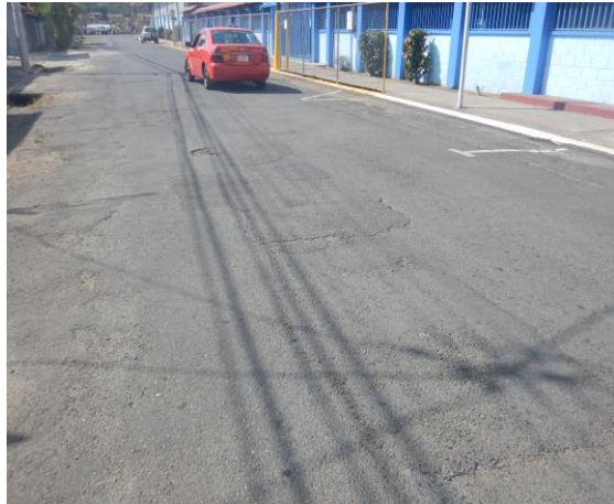
Parches de alta severidad.
