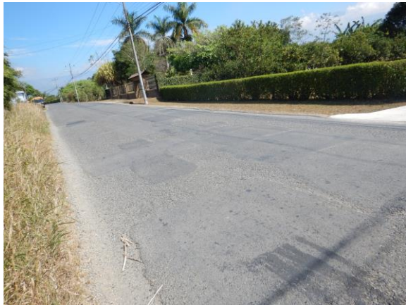
Parches de mediana severidad.
