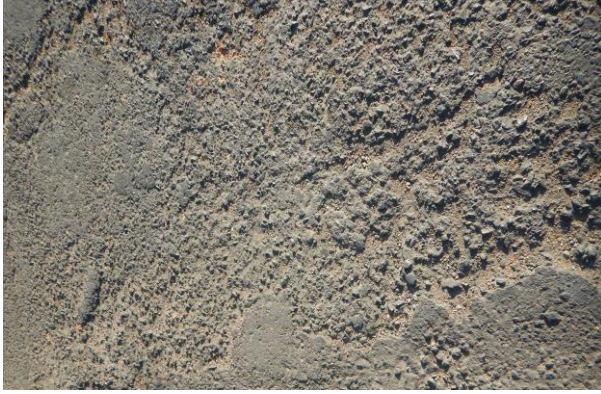
Desprendimiento de agregados de alta severidad.
