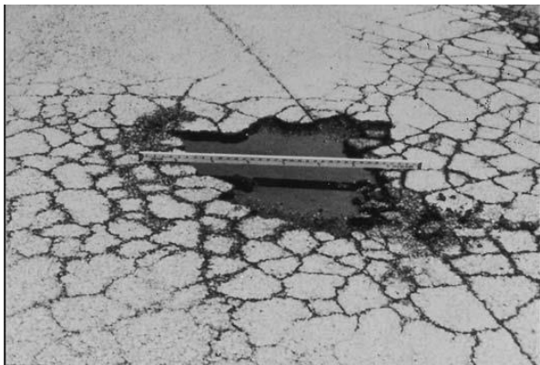
Figura 19. Baches de alta severidad. Fuente: (American Society for Testing and Materials, 2018).
