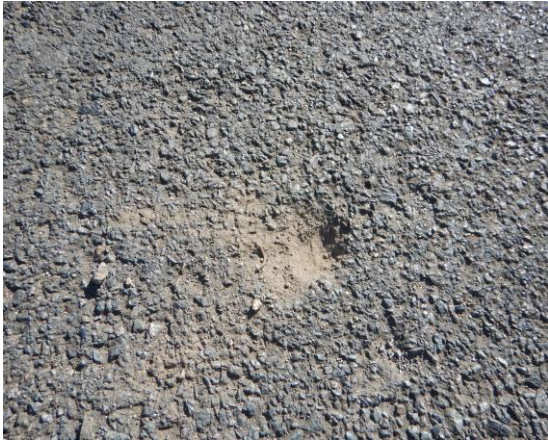
Desprendimiento de agregados.
