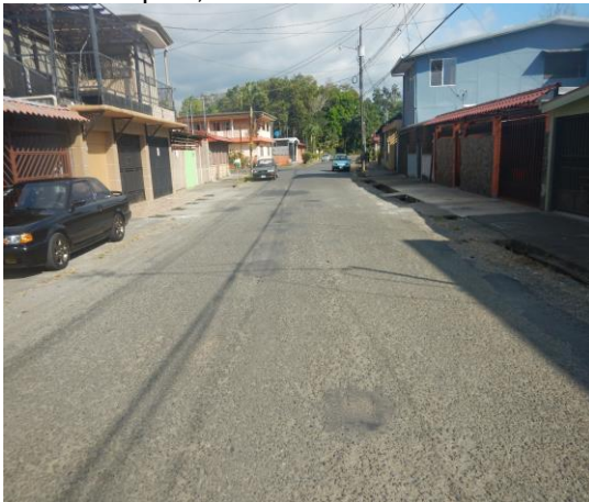
Desprendimiento de agregados de alta severidad.
