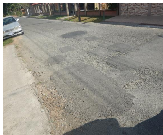
Parches de mediana severidad.
