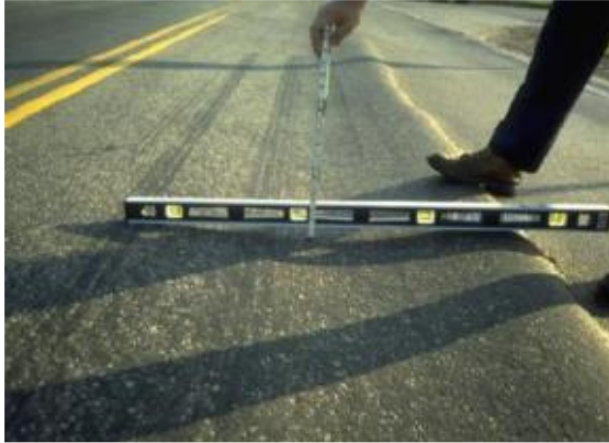
Figura 11. Ahuellamiento de alta severidad. Fuente: (MOPT, 2016).
