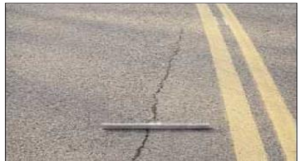
Figura 6. Grieta longitudinal de mediana severidad. Fuente: (MOPT, 2016).
