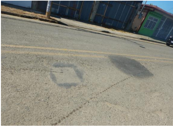
Desprendimiento de agregados de alta severidad.
