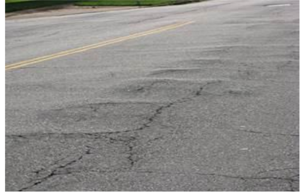
Figura 9. Corrugación de alta severidad. Fuente: (MOPT, 2016).
