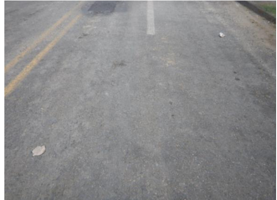
Desprendimiento de agregados de alta severidad.
