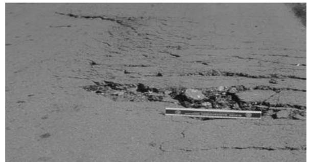
Figura 7. Grieta parabólica de alta severidad. Fuente: (MOPT, 2016).
