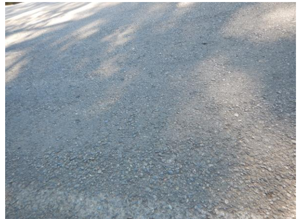
Figura 226. Desgaste superficial del pavimento en el TH=1. Fuente: Elaboración propia.
