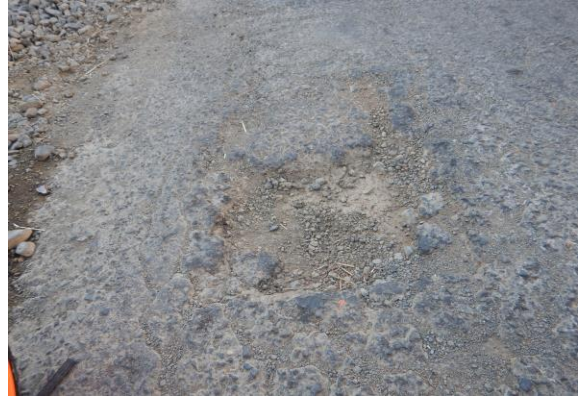
Bache de alta severidad.
