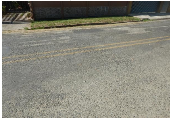
Desprendimiento de agregados de alta severidad.
