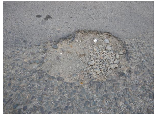
Bache de alta severidad.
