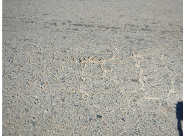
Desgaste superficial y CL de alta severidad, propician la aparición de baches.
