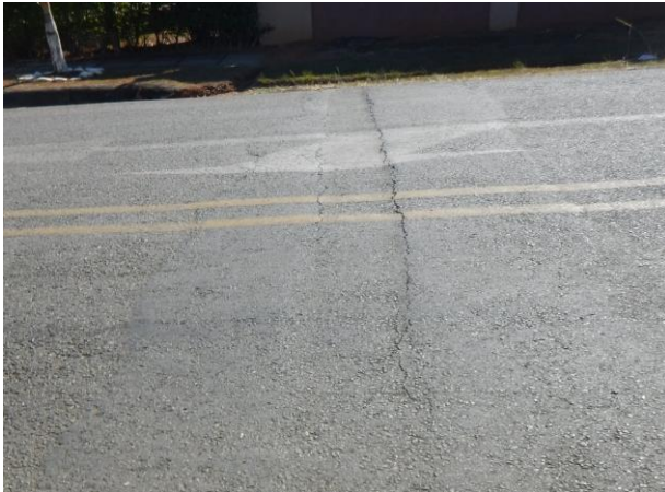
Grieta transversal de alta severidad.
