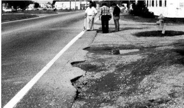
Figura 4. Grietas de borde de alta severidad. Fuente: (American Society for Testing and Materials, 2018).
