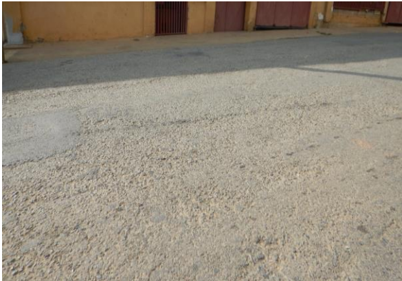
Desprendimiento de agregados.
