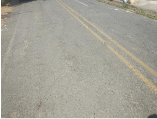
Desprendimiento de agregados de alta severidad.
