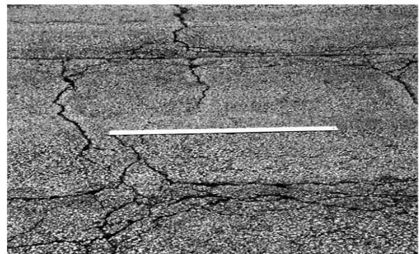
Figura 3. Grietas en bloque de baja severidad. Fuente: (American Society for Testing and Materials, 2018).
