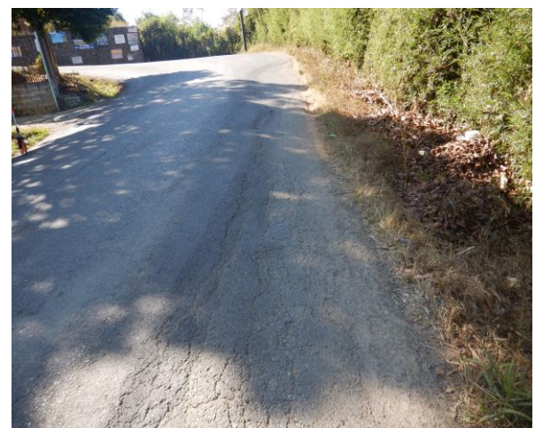
Hundimiento y CL de alta severidad.
