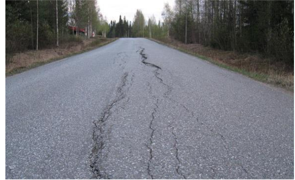
Figura 13. Falla de alta severidad asociada a hinchamiento. Fuente: (MOPT, 2016).
