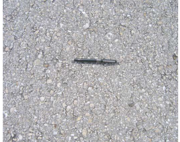
Figura 16. Peladura por intemperismo de baja severidad.
