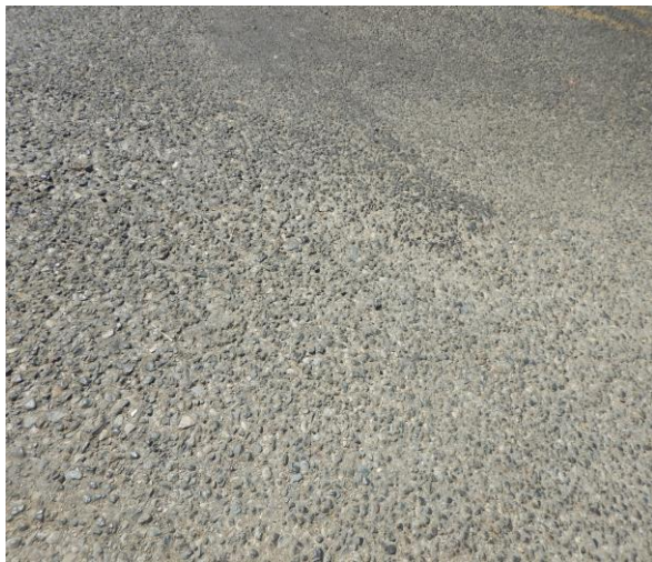
Figura 228. Desgaste superficial del pavimento presente en las rutas Barrio Hospital y Barrio Las Américas. Fuente: Elaboración propia.
