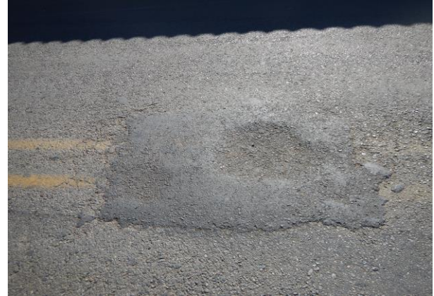
Parche de mediana severidad.
