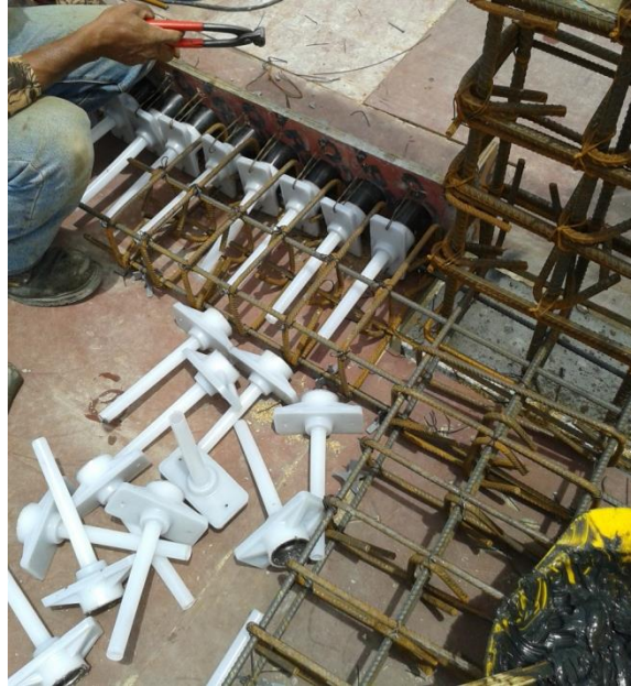
Apéndice D 15. Colocación de formador de cajas en formaleta perimetral para anclaje de tensado. Fuente: Imagen propia.
