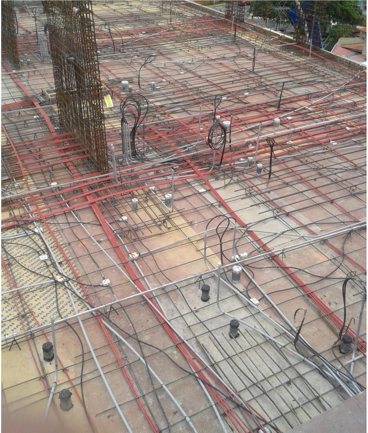
Apéndice D 14. Cables alineados y asegurados con amarras de alambre.
