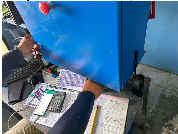
Figura 93. Controles de la planta de concreto premezclado
