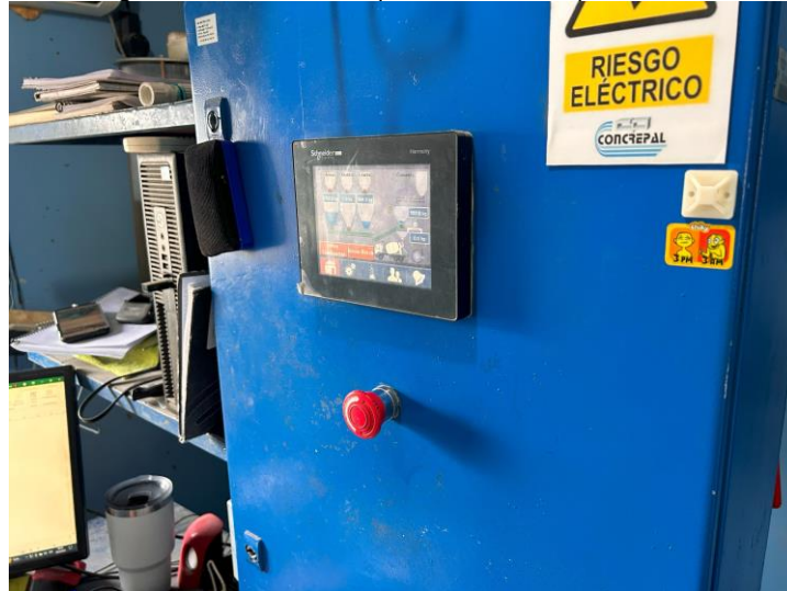
Figura 92. Controles de la planta de concreto premezclado
