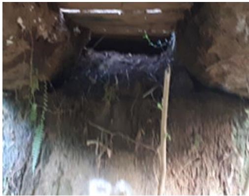
Figura 62. El área de apoyo entre las vigas y el bastión se encuentra con acumulación de sedimentos. Fuente: Elaboración propia.
