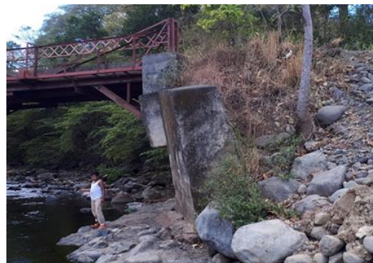
Figura 126. Se observa el bastión 2 y su aletón aguas abajo con una inclinación muy notable. Fuente: Elaboración propia.
