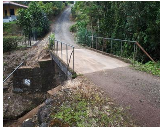
Figura 81. Falta de señalización y guarda vías. Fuente: Elaboración propia.
