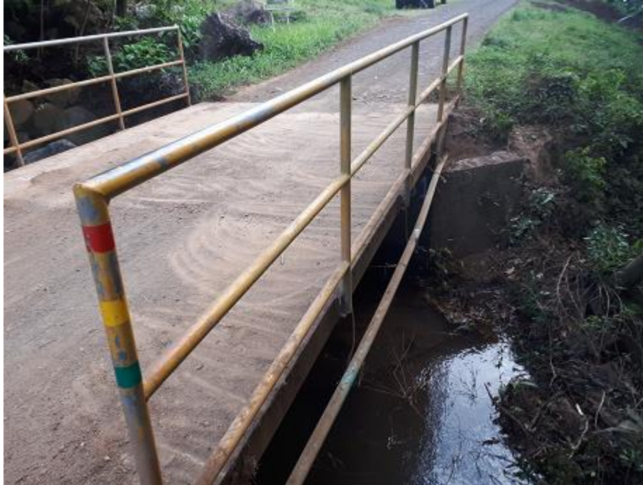
Figura 4. Barandas no cumplen requerimientos de seguridad vial para impacto de vehículos en el puente Cabuyo.
