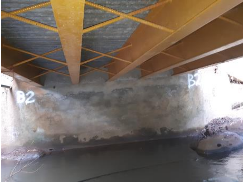
Figura 10. Cuerpo del bastión con existencia de humedad y eflorescencia.
