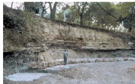
Figura 30. Ejemplo de erosión de márgenes. Fuente: (Ministerio de Fomento, 2012).
