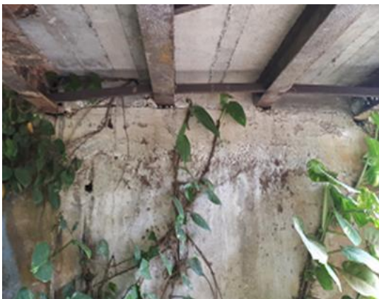
Figura 85. Junta de construcción entre bastión y superestructura que permite filtración de agua. Fuente: Elaboración propia.
