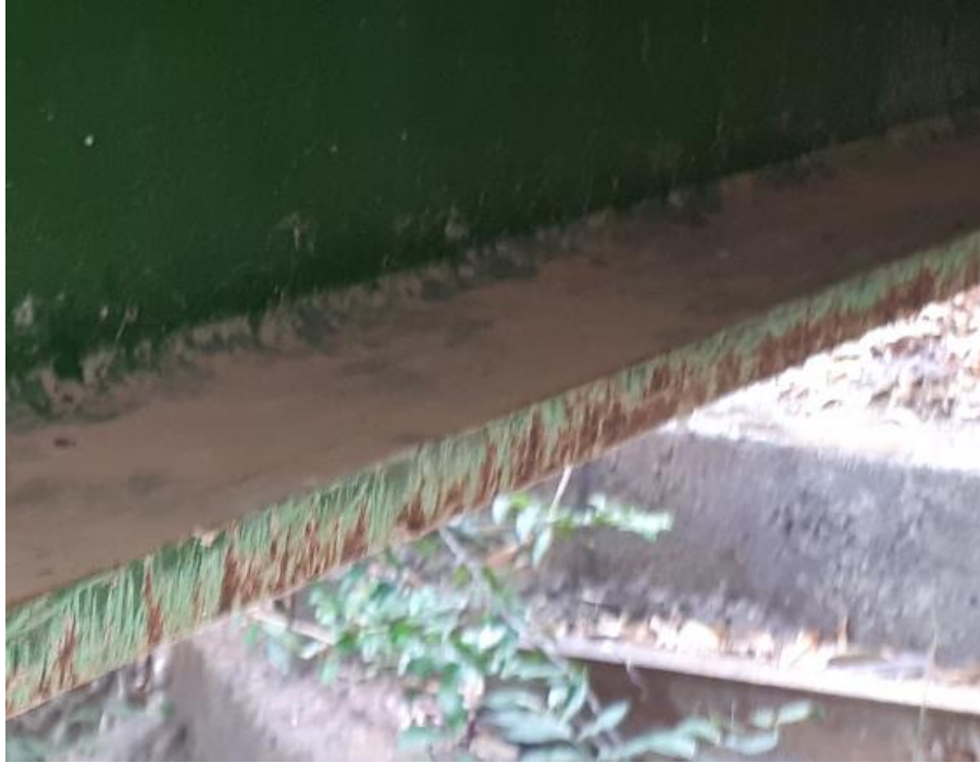
Figura 6. Se visualiza inicios de oxidación en todos los elementos de la superestructura metálica.
