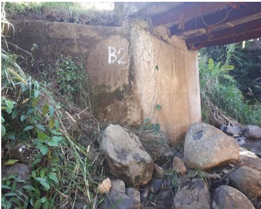
Figura 11. Piedras de gran tamaño obstruyendo la entrada de flujo de agua al puente.
