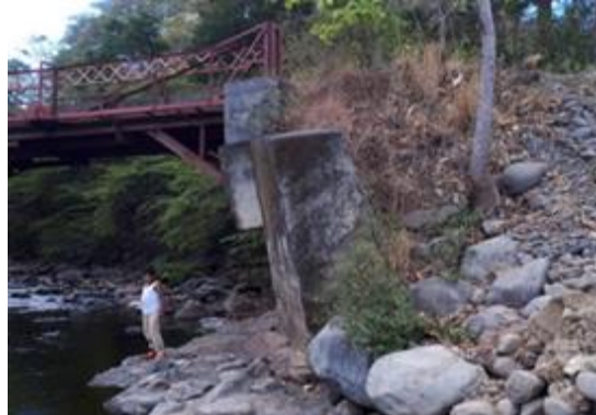
Figura 147. Bastión 2 con una inclinación considerable. Fuente: Elaboración propia.
