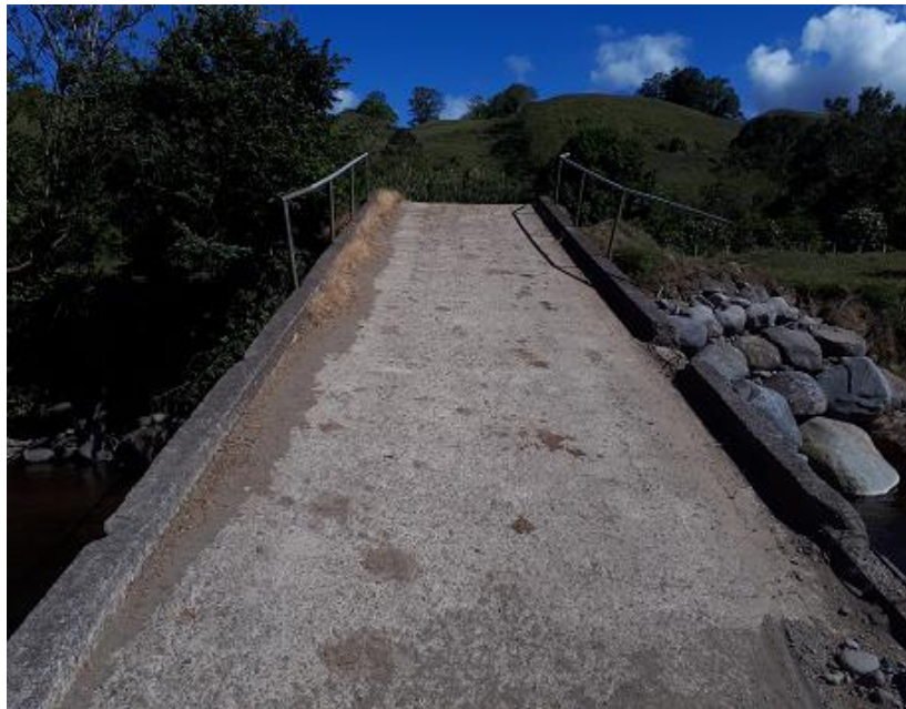
Figura 4. Se observa el faltante de baranda metálica y bordillos con daños que exponen el acero de refuerzo en el puente San Pedro.
