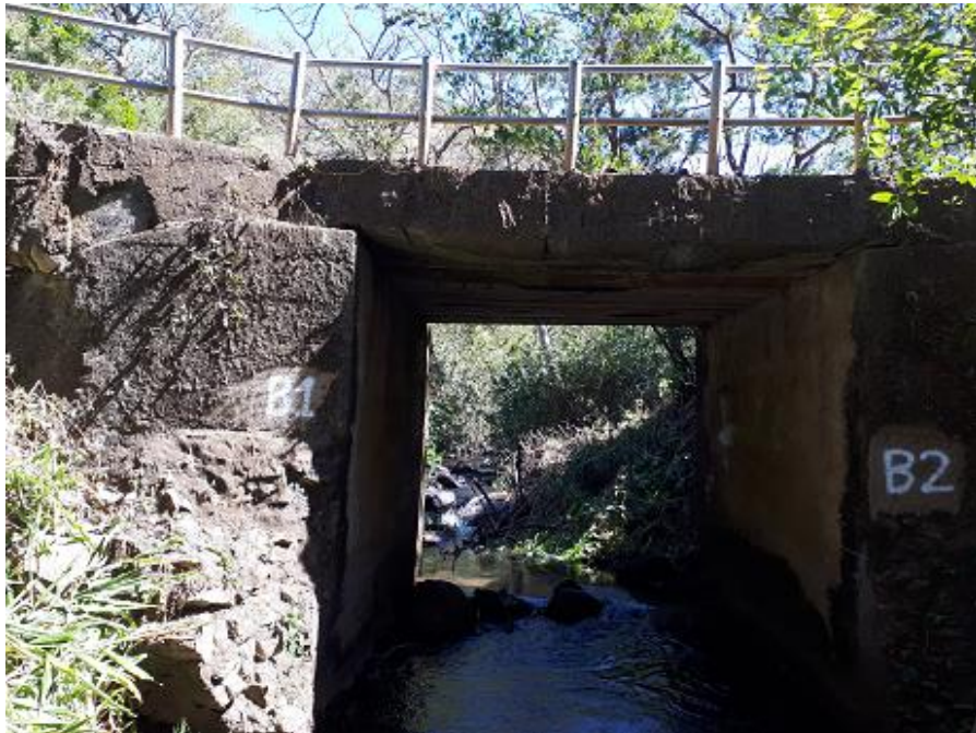
Figura 11. Bastión 1 con inclinación notable.
