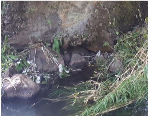
Figura 119. Principio de socavación en bastión 2. Fuente: Elaboración propia
