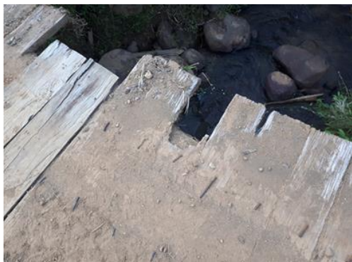
Figura 63. Elementos de piso de tablonces de madera dura dañados en sus extremos. Fuente: Elaboración propia.
