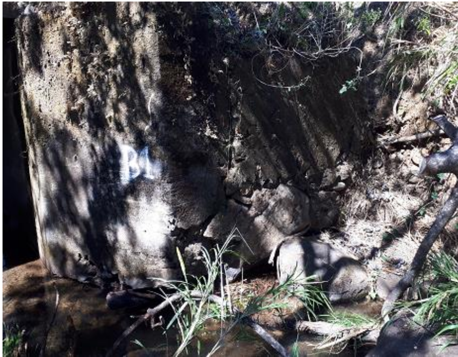
Figura 7. Principio de socavación en aletón.
