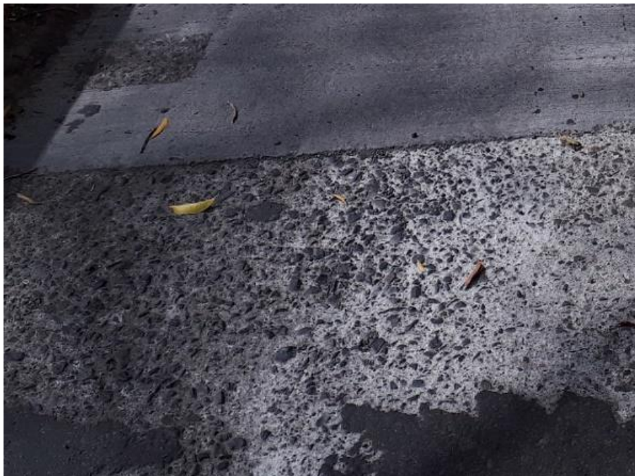
Figura 7. Se observa desgaste con exposición de agregado en el piso de la calzada.
