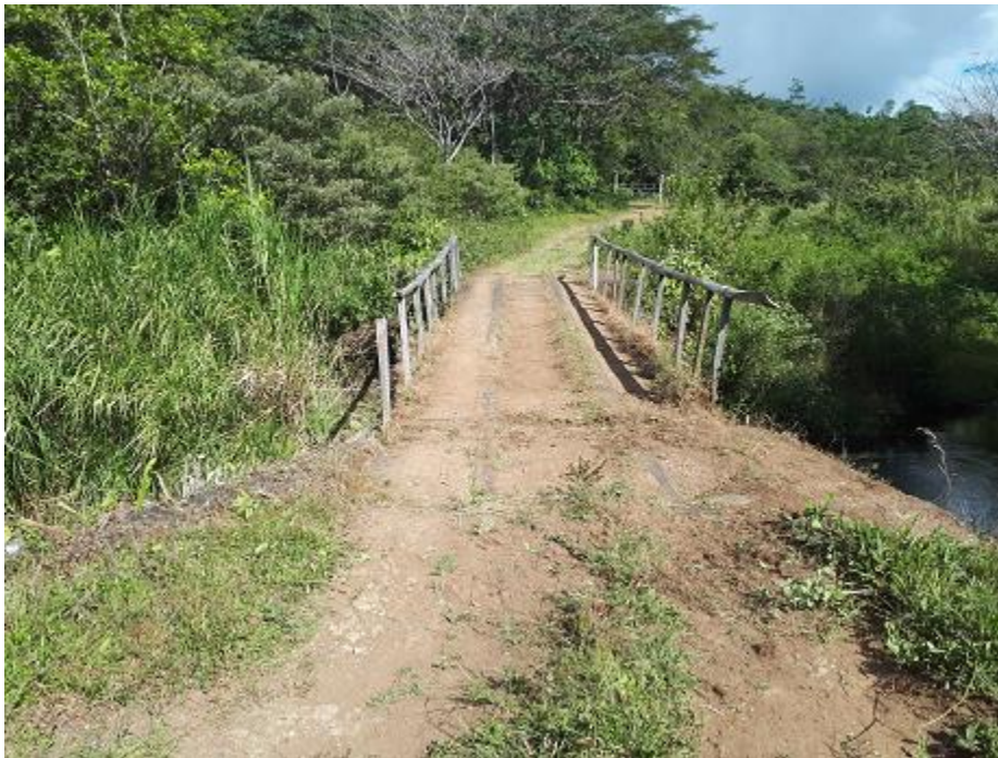
Figura 5. Señalización vertical y guarda vías inexistentes.
