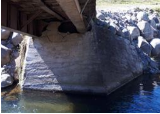
Figura 145. Vista del bastión 1 destruido por el desbordamiento del río Chiquito. Fuente: Elaboración propia.
