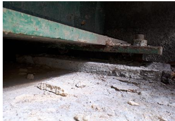
Figura 113. Placas de asiento de los apoyos con inicio de corrosión. Fuente: Elaboración propia.
