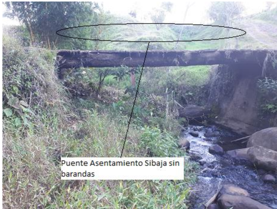
Figura 4. Barandas inexistentes en el puente Asentamiento Sibaja.
