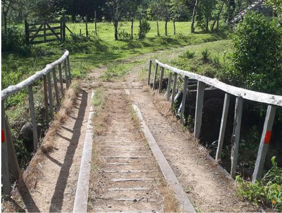
Figura 4. Barandas de madera en mal estado puente Pedro Soto.
