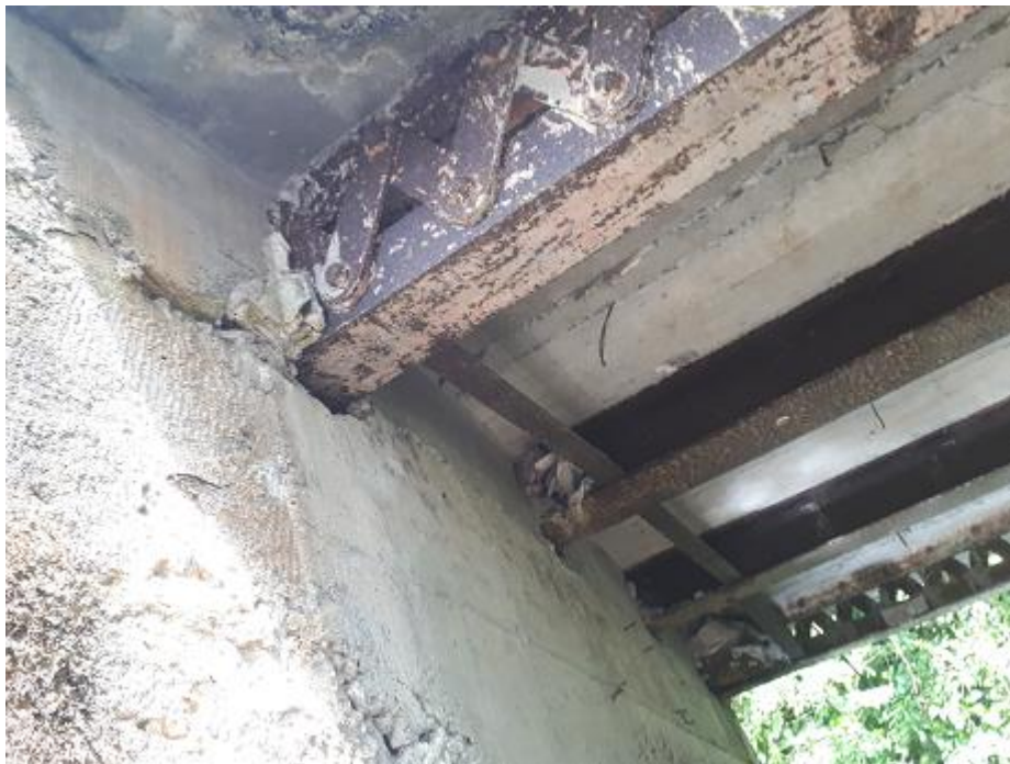
Figura 11. Sistema de arriostre oxidado y nidos de piedra en bastión.
