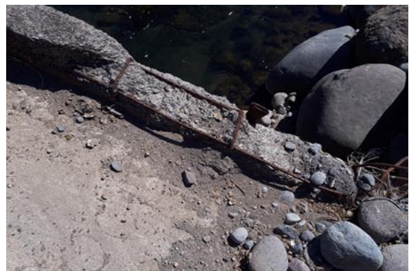
Figura 135. Se observa acero expuesto muy oxidado y con corrosión en los bordillos de la losa de concreto.
