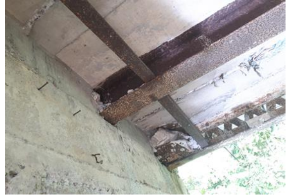
Figura 80. Oxidación y corrosión de la superestructura. Fuente: Elaboración propia.
