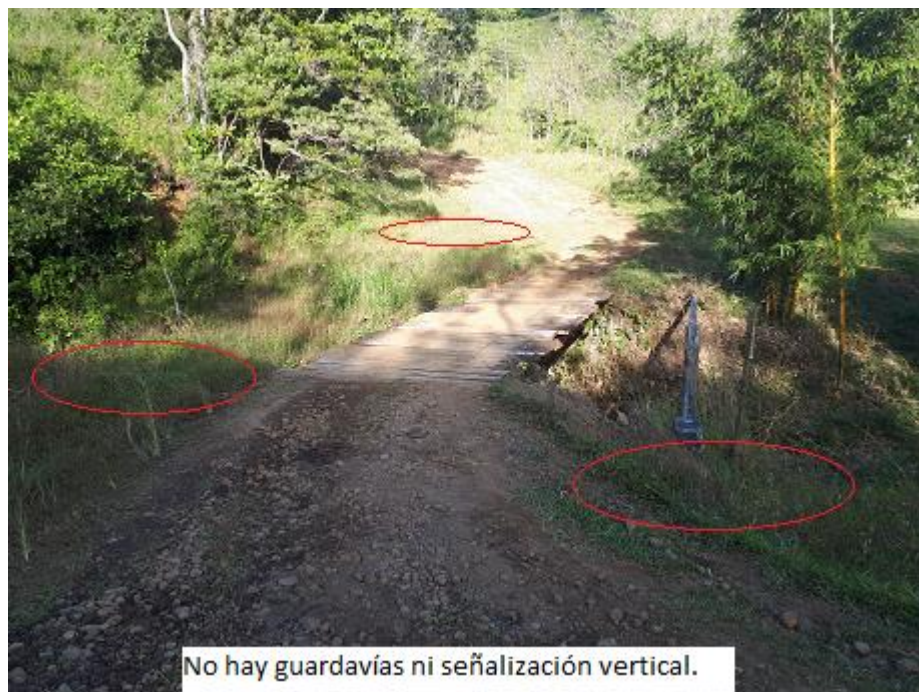
Figura 5. Señalización vertical y guardavías inexistentes.
