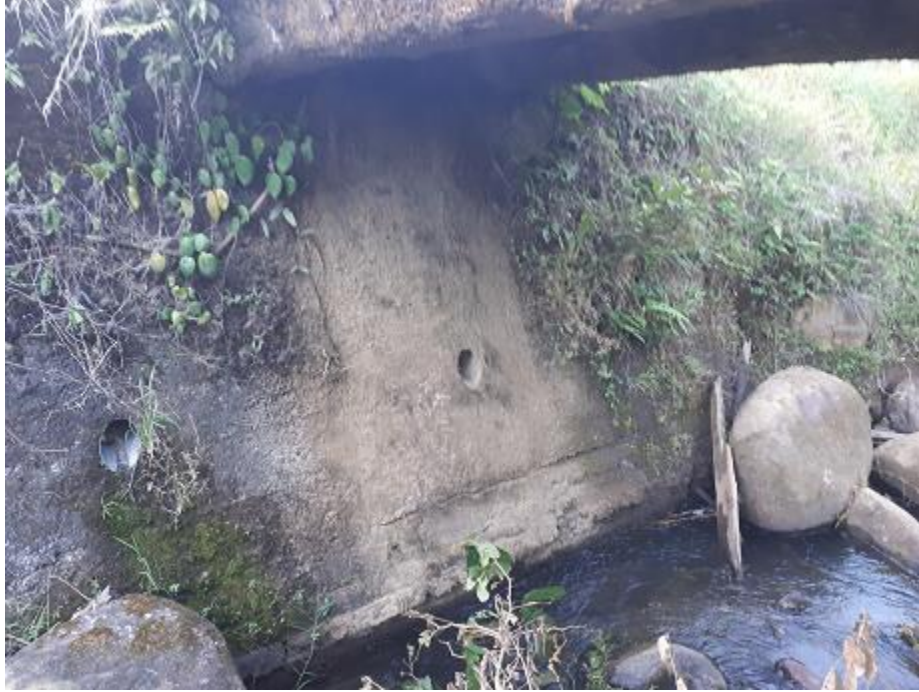
Figura 10. Cuerpo del bastión con humedad, musgo y plantas.
