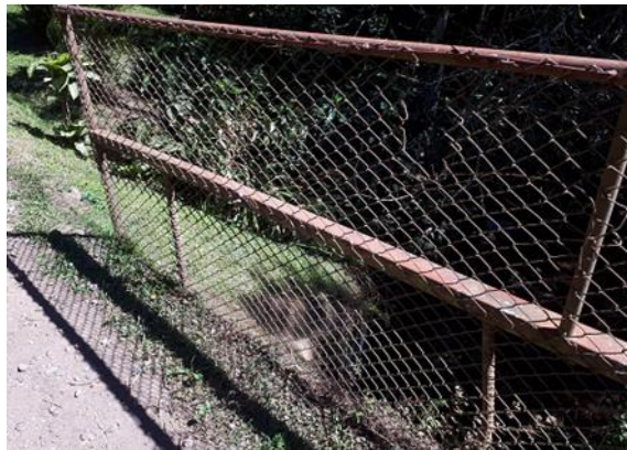
Figura 75. Baranda dañada, deformada, falta de limpieza y pintura. Fuente: Elaboración propia.
