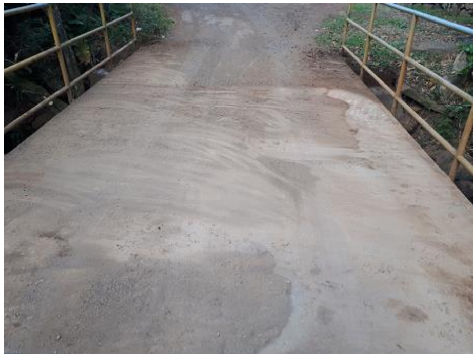
Figura 9. Losa de concreto con acumulación de material.
