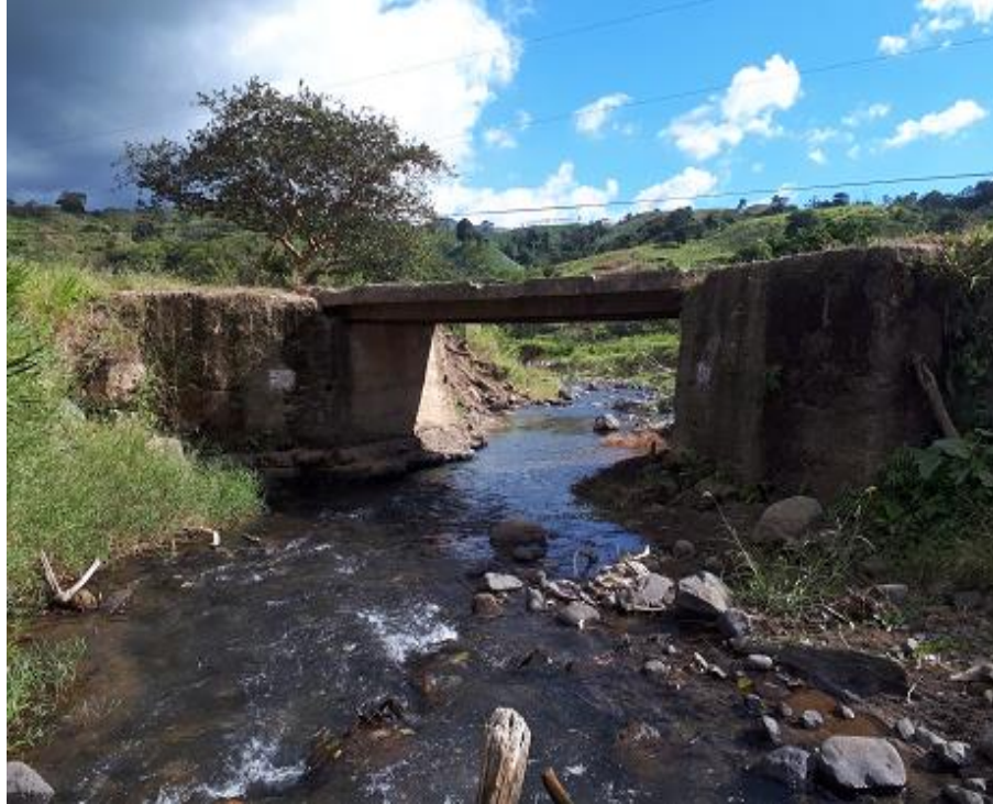
Figura 4. Barandas inexistentes en el puente Las Minas.
