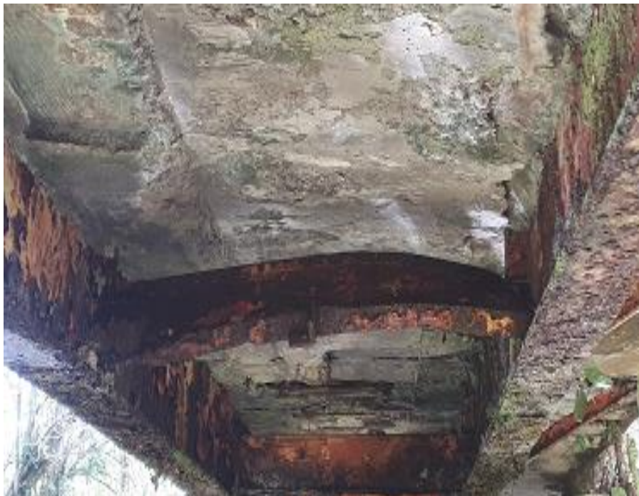
Figura 11. Elemento del sistema de arriostamiento deformado, oxidado y con corrosión.
