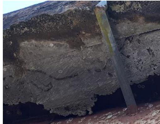
Figura 134. Losa de concreto con nidos de piedra, acero expuesto, eflorescencia y humedad.
