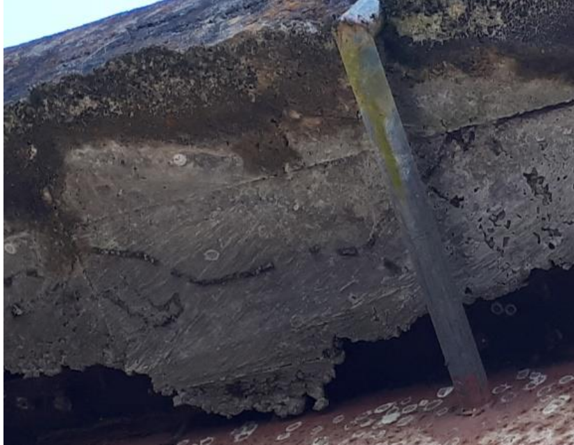
Figura 8. Losa de concreto con nidos de piedra, eflorescencia, musgo y húmedad.
