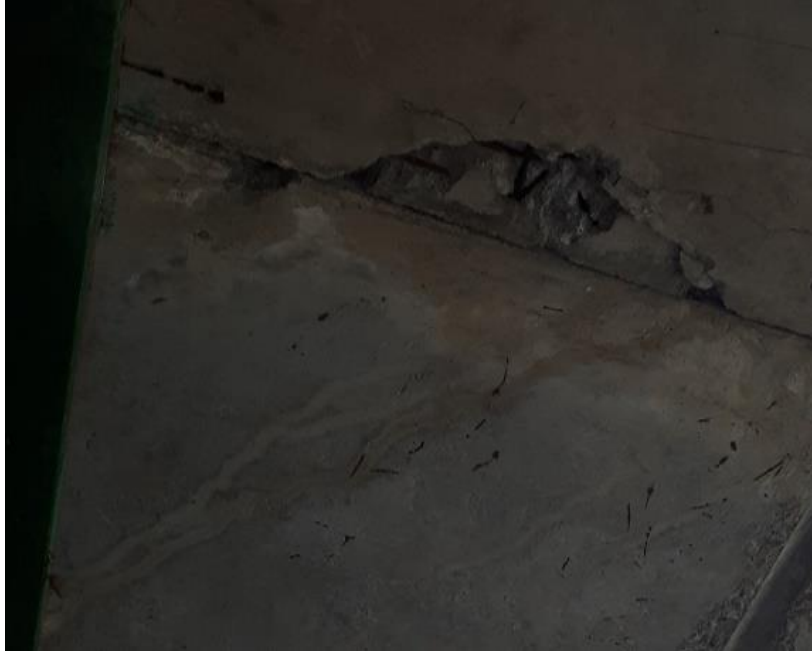
Figura 8. Acero expuesto a la oxidación y corrosión en baldosas de concreto prefabricado de piso en el puente.
