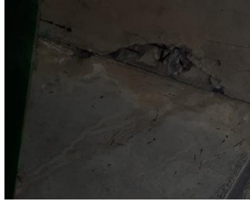
Figura 112. Se observan algunos daños en baldosas prefabricadas de concreto que exponen su refuerzo de acero a la oxidación y corrosión. Fuente: Elaboración propia.
