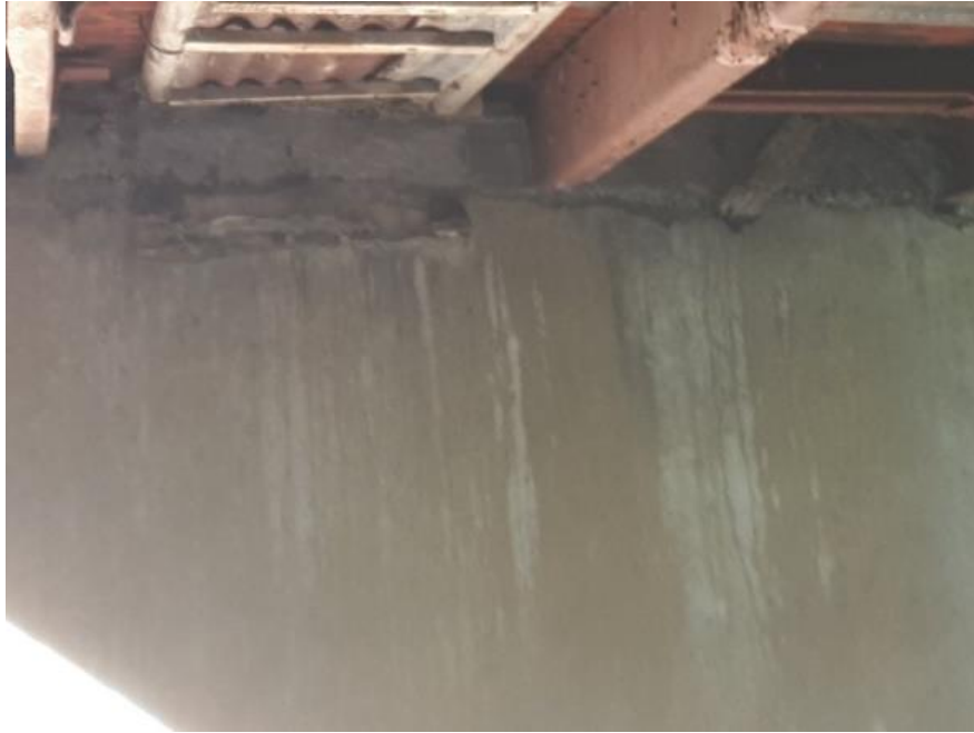
Figura 10. Filtración de agua por junta de expansión.
