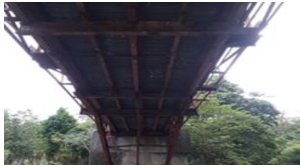
Figura 149. Superestructura de acero con distintas secciones y un alto porcentaje de corrosión. Fuente: Elaboración propia.
