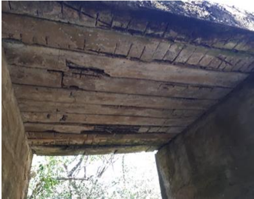
Figura 100. Superestructura de concreto muy dañada. Fuente: Elaboración propia.
