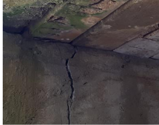
Figura 103. Filtración de agua, eflorescencia, humedad, acero de refuerzo expuesto y grieta en bastión. Fuente: Elaboración propia.
