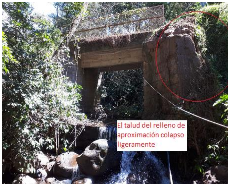
Figura 7. Ligeró colapso en relleno de aproximación.
