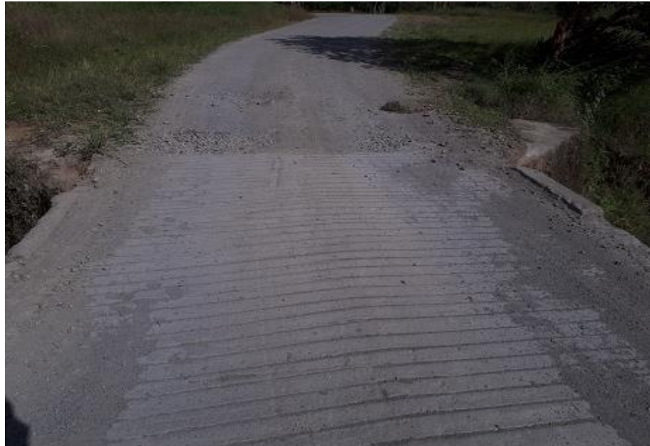
Figura 6. Ausencia de sistemas de drenaje o cunetas.
