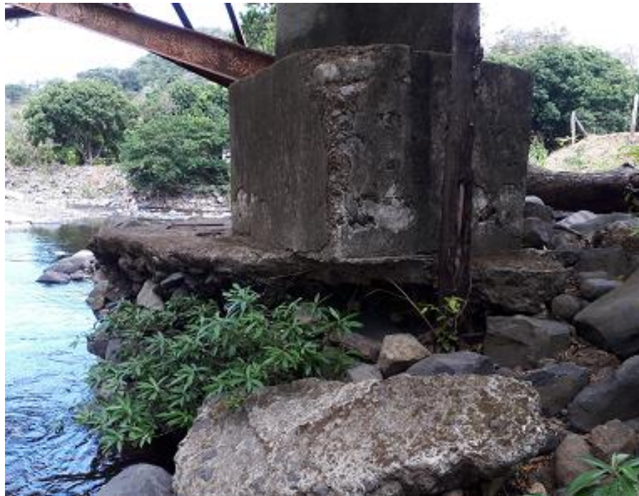
Figura 9. Socavación en pila P1 que pone en riesgo la estabilidad global de la estructura.
