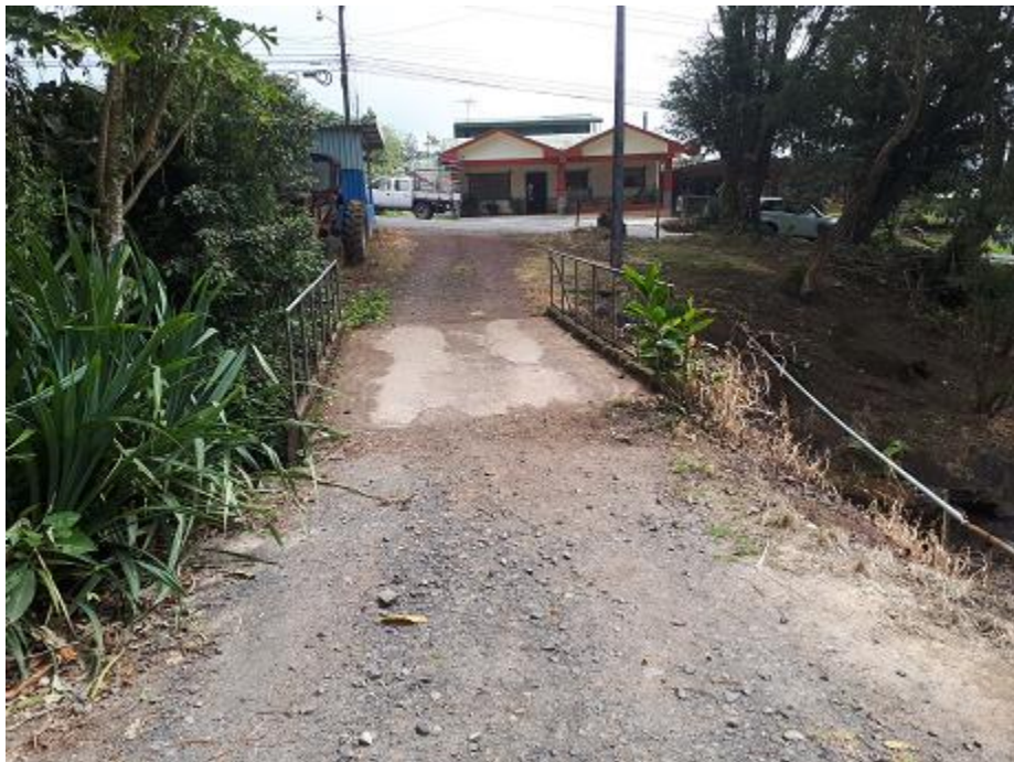
Figura 5. Señalización vertical, guardavías inexistentes.
