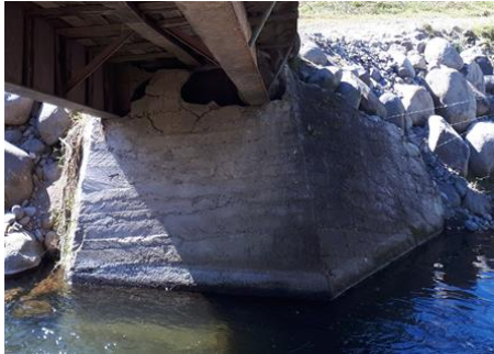
Figura 1931 Se visualizan el bastión 1 con problemas de inclinación, socavación y un grado de daño alto en la estructura.
