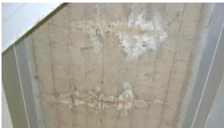
Figura 45. Eflorescencia en losa de concreto. Fuente: (MOPT, 2007).
