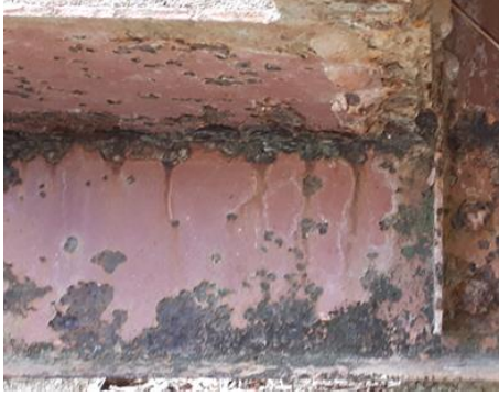
Figura 127. Vigas principales de la superestructura con oxidación e inicios de corrosión en sus elementos. Fuente: Elaboración propia.
