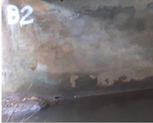
Figura 70. Se observa humedad en las paredes de los bastiones.
