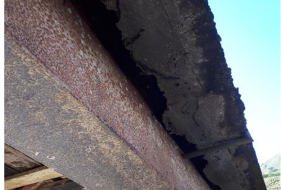
Figura 133. Se observan viga de acero principal con un alto porcentaje de oxidación y principios de corrosión.
