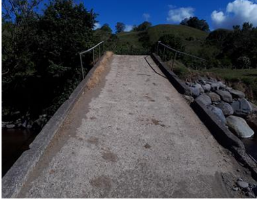
Figura 136. Faltante y deformación de baranda en puente San Pedro. Fuente: Elaboración propia.
