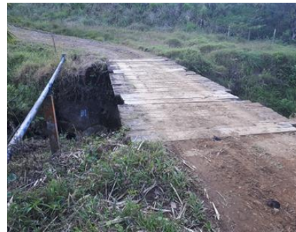
Figura 59. Puente de madera sin rótulo, barandas, iluminación y señalización. Fuente: Elaboración propia.
