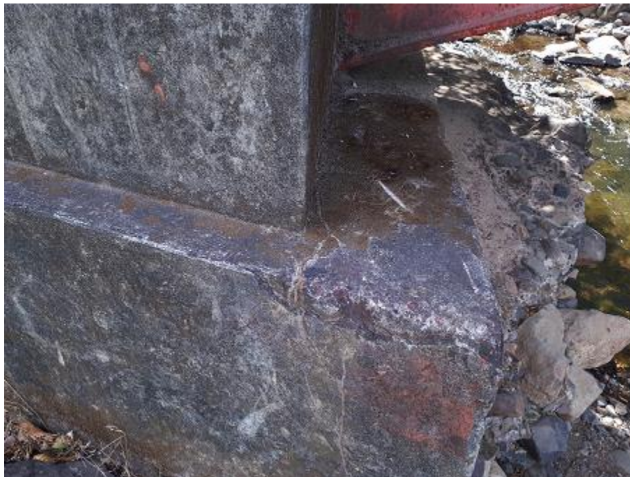
Figura 11. Grietas en bloque A de la pila P1.
