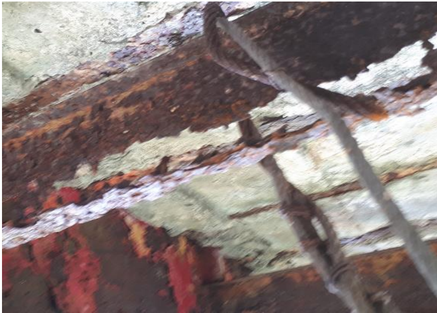
Figura 9. Pérdida de elementos por corrosión excesiva.
