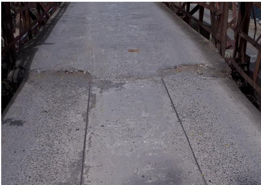
Figura 5. Diferencia de elevación de losa de concreto del Tramo I y II, 8 cm aproximadamente.
