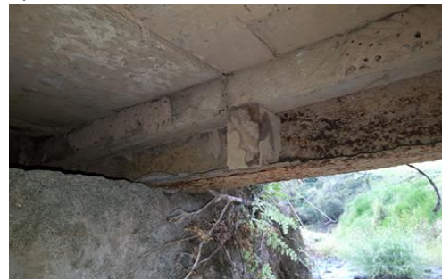
Figura 86. Oxidación y corrosión de la superestructura puente Las Minas. Fuente: Elaboración propia.
