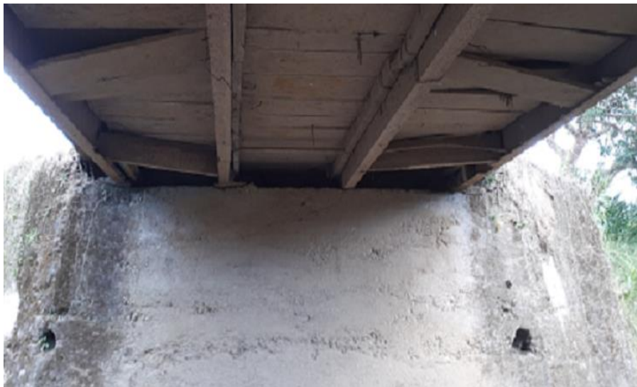
Figura 11. Sistema de arriostre oxidado y nidos de piedra en bastión.
