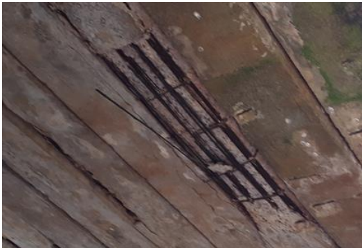
Figura 101. Acero de vigas principales expuesto con avanzada corrosión Fuente: Elaboración propia.
