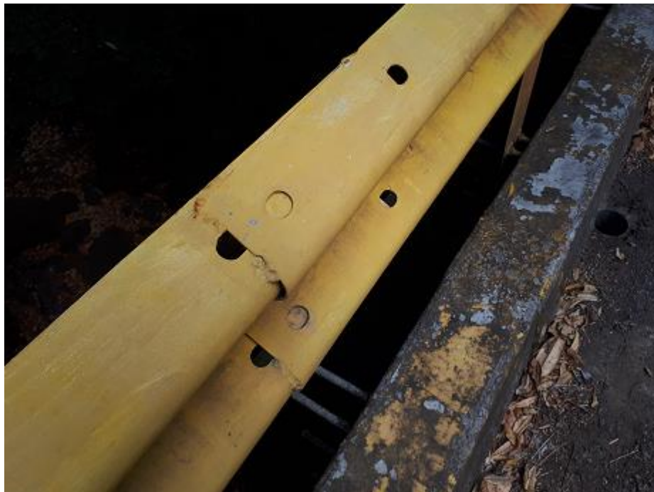
Figura 11. Pintura de baranda con un grado de decoloración.
