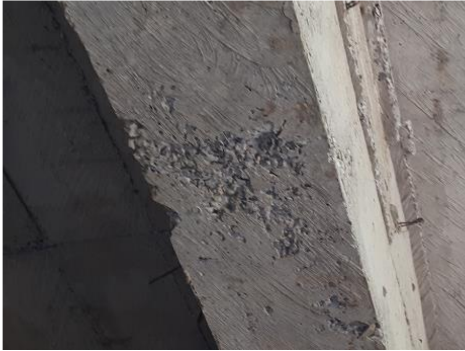
Figura 8. Nidos de piedra en viga principal.
