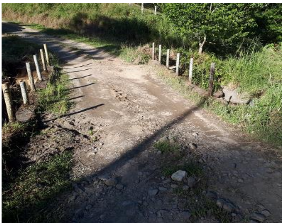
Figura 5. Señalización vertical, guardavías inexistentes.
