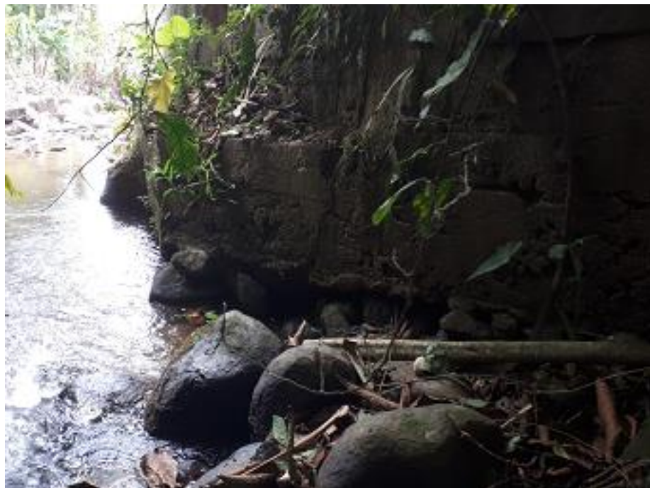
Figura 7. Socavación en bastión 2.
