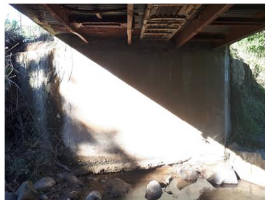
Figura 95. Bastión con principios de socavación de puente Las Pavas. Fuente: Elaboración propia.
