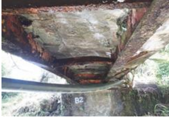
Figura 154. Superestructura de acero con alta corrosión. Fuente: Elaboración propia.
