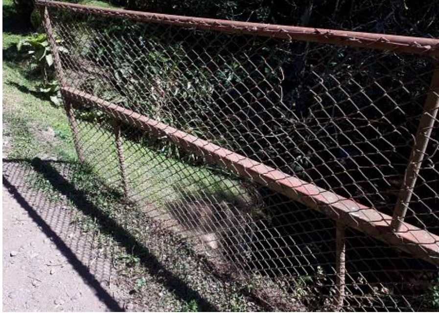
Figura 4. Barandas existentes en el puente Cañitas no cumplen con la especificación para resistir un impacto vehicular.
