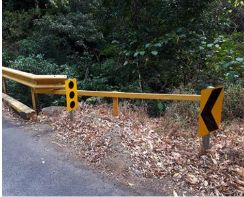
Figura 109. Los guarda vías colocados, no cumplen con la especificación para resistir el impacto vehicular. Fuente: Elaboración propia.
