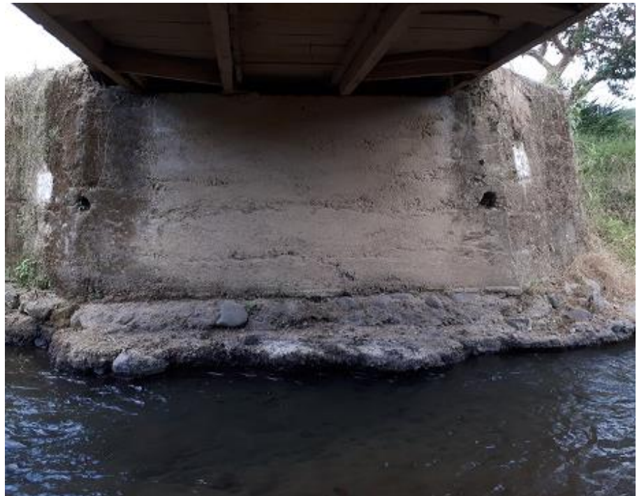
Figura 7. Socavación en bastión 2.
