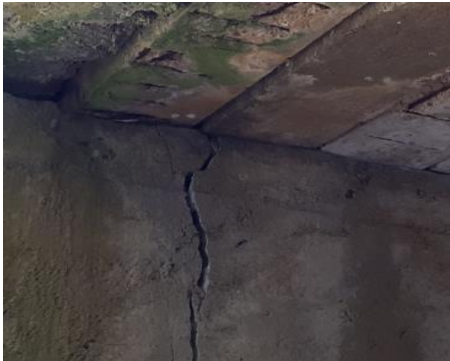
Figura 9. Nidos de piedra, filtración de agua, grietas, humedad en losa de concreto y bastión.
