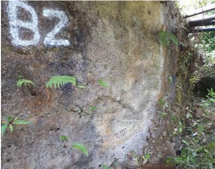
Figura 10. Filtración de agua por junta de expansión, eflorescencia y nidos de piedra en bastión.
