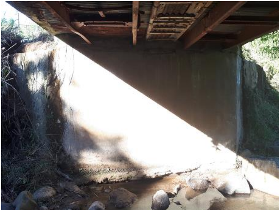
Figura 7. Principio de socavación en bastión.
