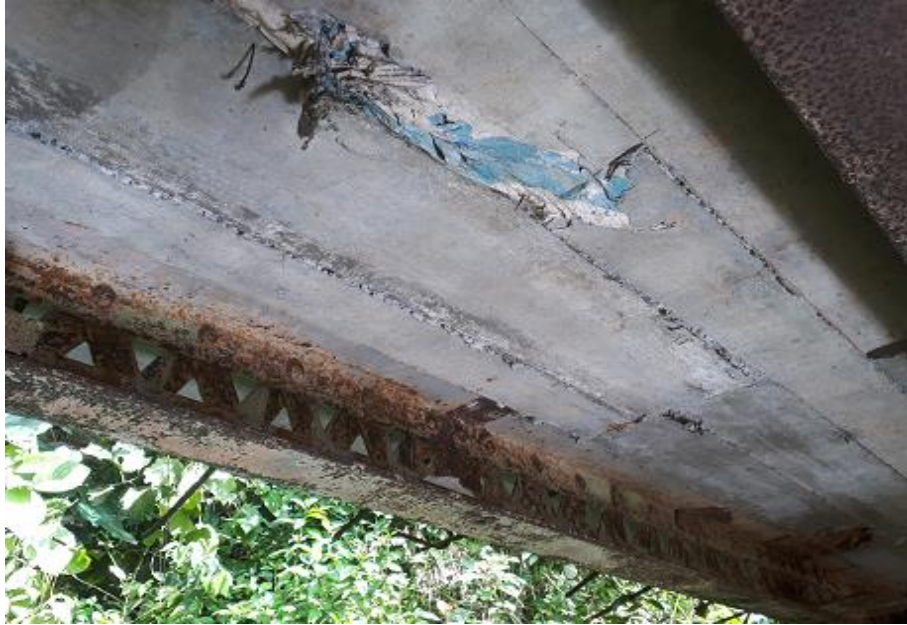
Figura 10. Losa de concreto con nidos de piedra y eflorescencia.
