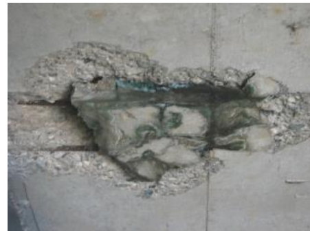
Figura 44. Nidos de piedra en el concreto. Fuente: (MOPT, 2007).
