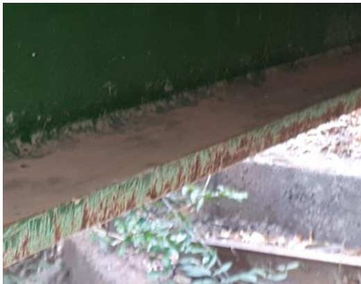
Figura 110. Vigas principales de acero con inicios de oxidación. Fuente: Elaboración propia.
