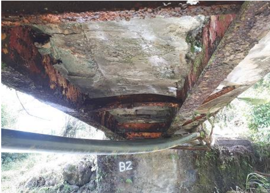
Figura 6. Losa de concreto con eflorescencia, nidos de piedra y húmedad.
