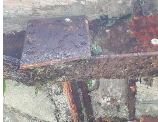
Figura 115. Vigas principales de acero con oxidación y corrosión.
