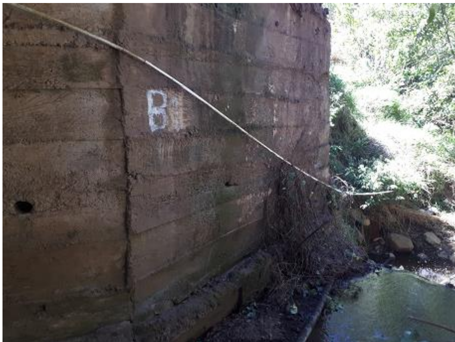
Figura 11. Aletón observado con nidos de piedra y filtraciones de agua.
