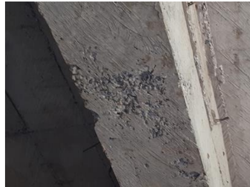
Figura 72. Nido de piedra en viga principal de concreto.
