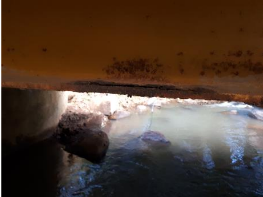
Figura 8. Corrosión con pérdida de sección en vigas principales.
