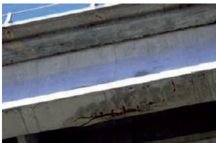
Figura 46. Acero de refuerzo expuesto. Fuente: (Ministerio de Fomento, 2012).
