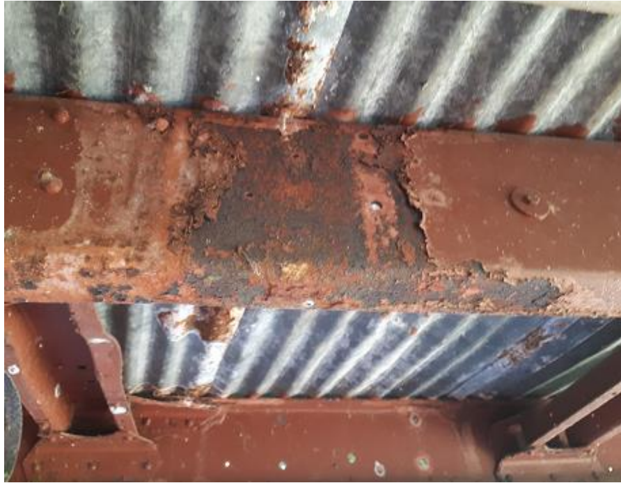
Figura 8. Oxidación en viga tipo chasis.
