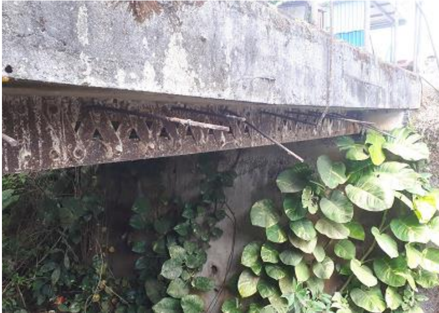
Figura 8. Oxidación en viga tipo cercha.
