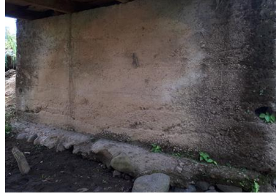
Figura 90. Eflorescencia y filtración de agua por la junta hacia el cuerpo del bastión. Fuente: Elaboración propia.
