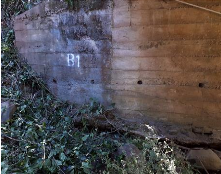
Figura 10. Cuerpo del bastión con nidos de piedra y juntas de construcción.
