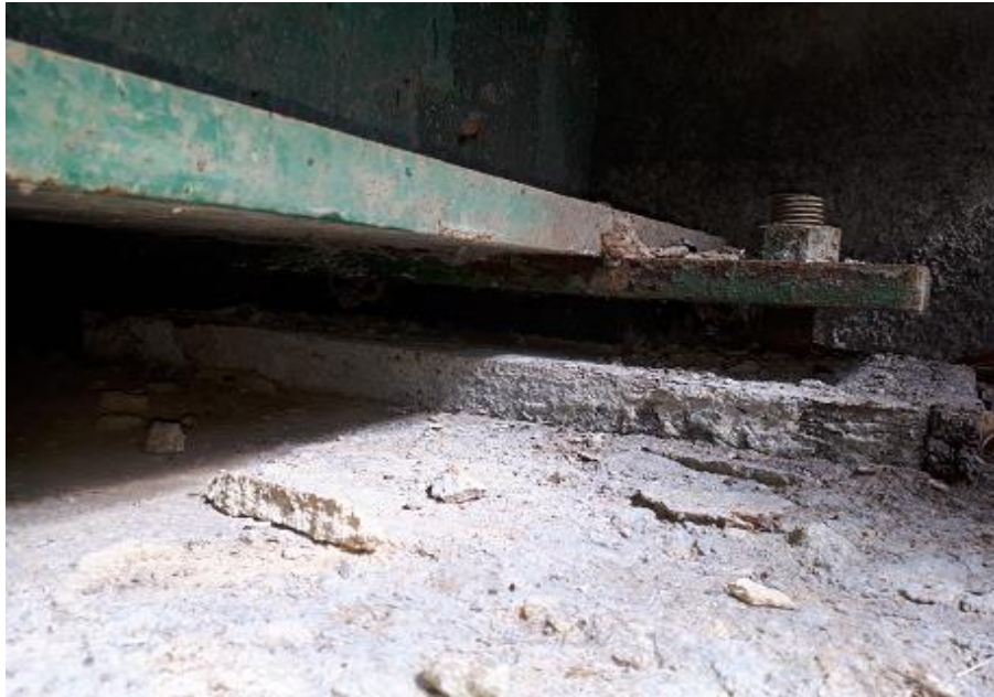
Figura 10. Placa de asiento en los apoyos con principios de corrosión.
