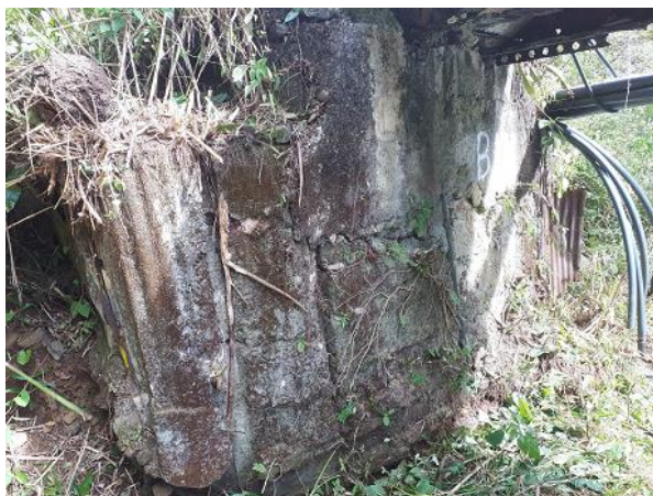
Figura 156. Bastión 1 dañado y con una configuración irregular. Fuente: Elaboración propia.
