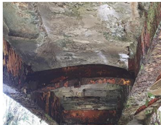
Figura 117. Elementos de arriostramiento con deformaciones notables.
