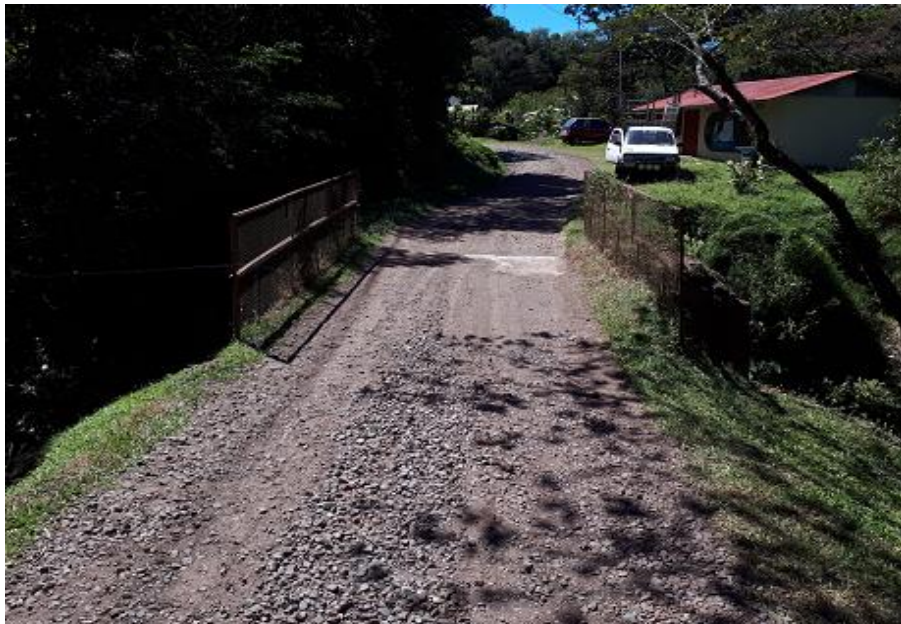
Figura 5. Señalización vertical, guardavías inexistentes.
