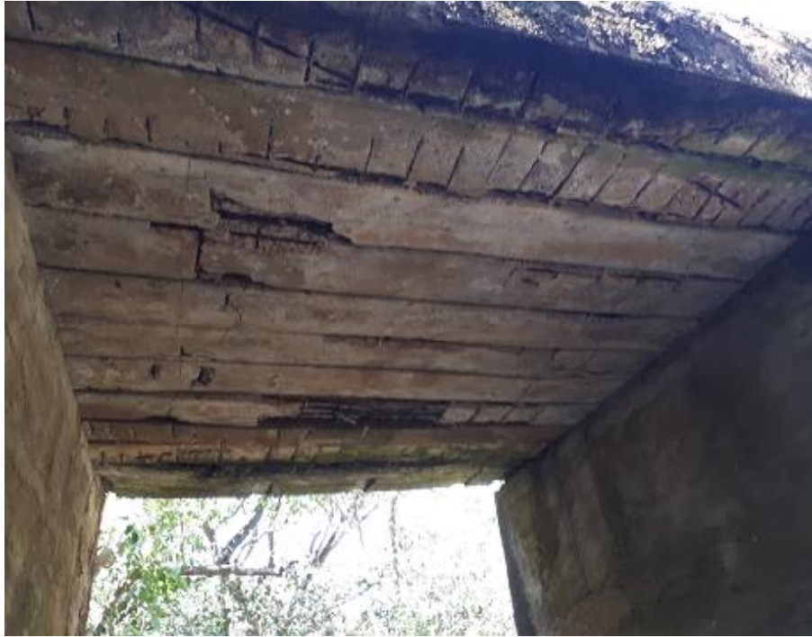
Figura 6. Sección inferior de puente Las Vueltas en mal estado.
