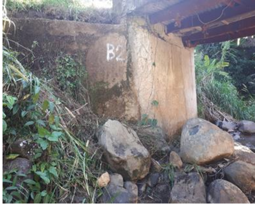
Figura 96. Piedras de gran tamaño obstruyendo el cauce aguas arriba. Fuente: Elaboración propia.
