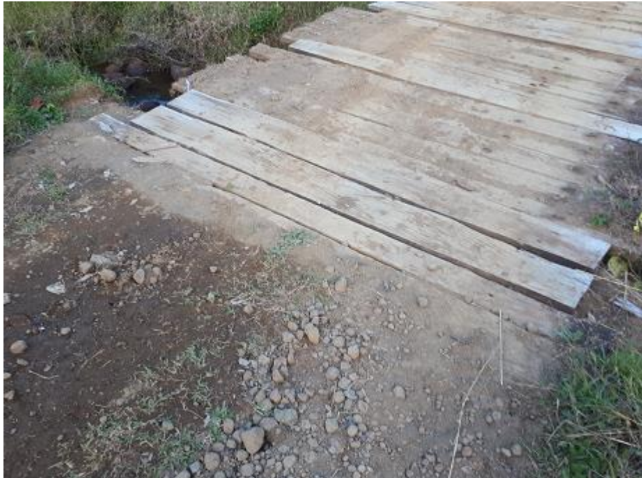
Figura 7. No hay juntas de expansión sobre los bastiones.
