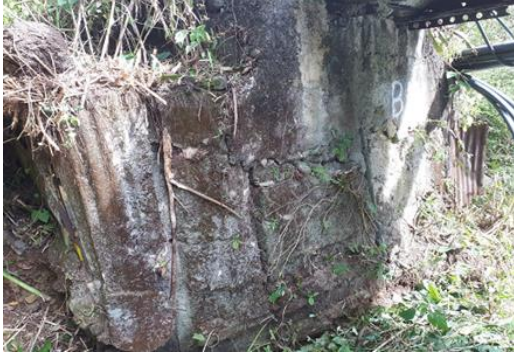
Figura 118. Se observan juntas de construcción en los bastiones y colado de concreto con figuras irregulares. Fuente: Elaboración propia.
