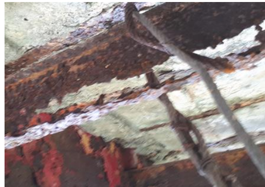
Figura 116. Se observan elementos que se han perdido por la corrosión.
