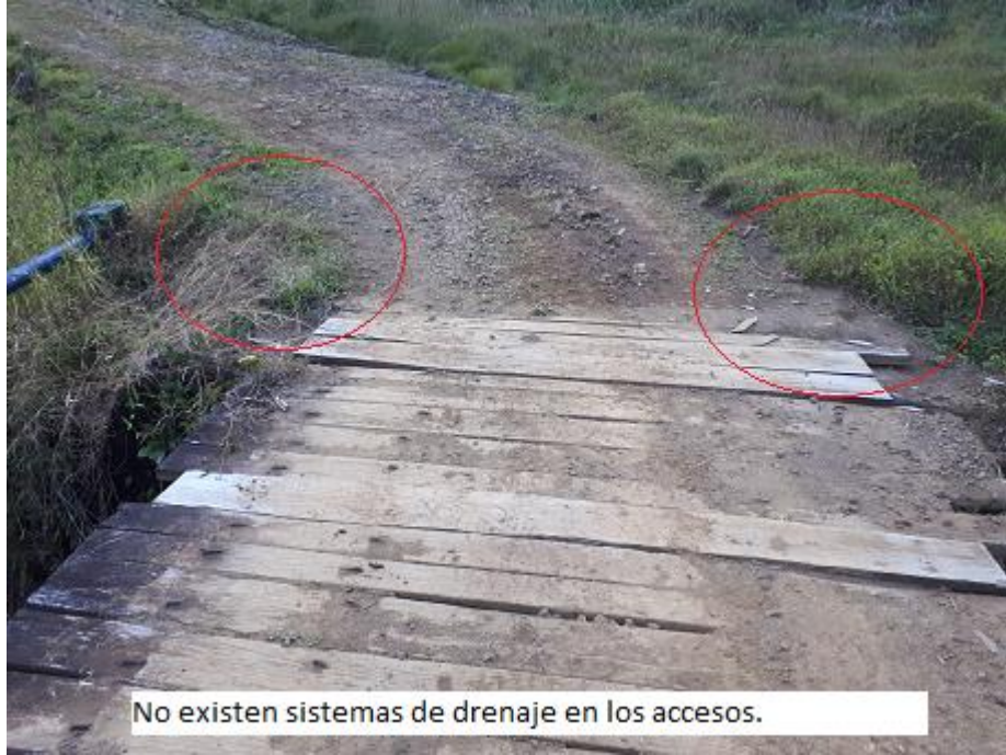
Figura 6. Ausencia de sistemas de drenaje o cunetas.
