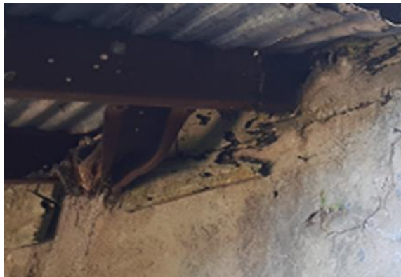
Figura 97. Arriostre de viga principal de acero deformado. Fuente: Elaboración propia.
