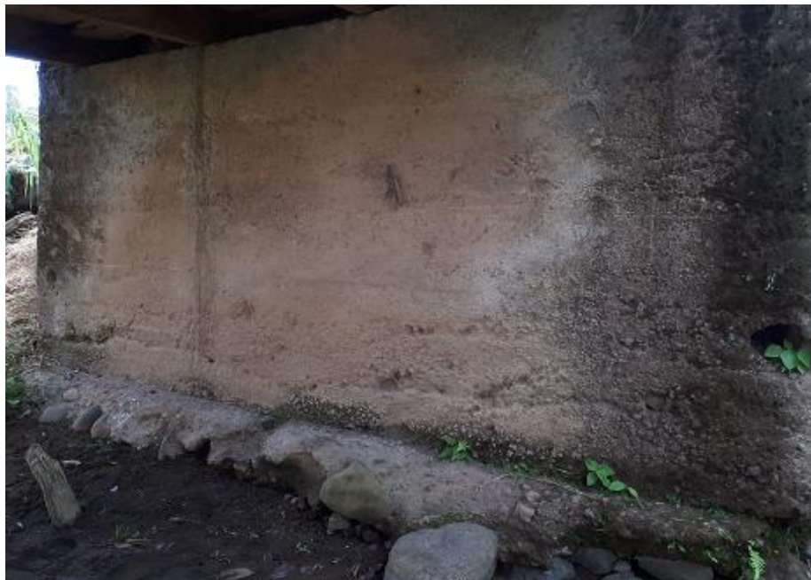
Figura 9. Nidos de piedra, filtración de agua y junta de construcción en cuerpo del bastión.
