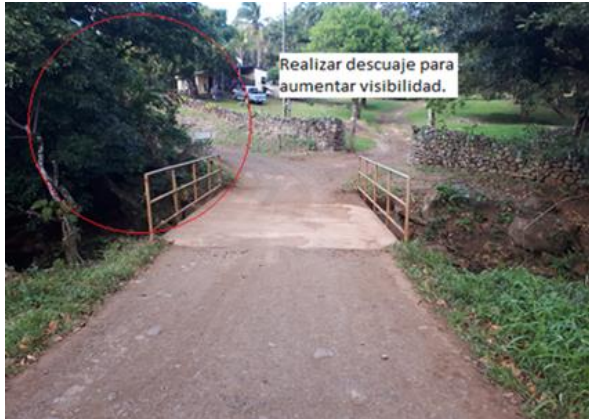
Figura 65. Se requiere descuaje para mejorar la visibilidad. Fuente: Elaboración propia.
