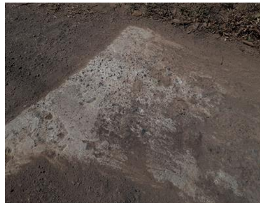
Figura 73. Desgaste en superficie de losa de concreto.
