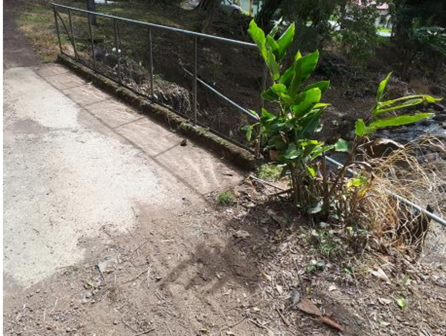
Figura 6. Ausencia de sistemas de drenaje o cunetas.
