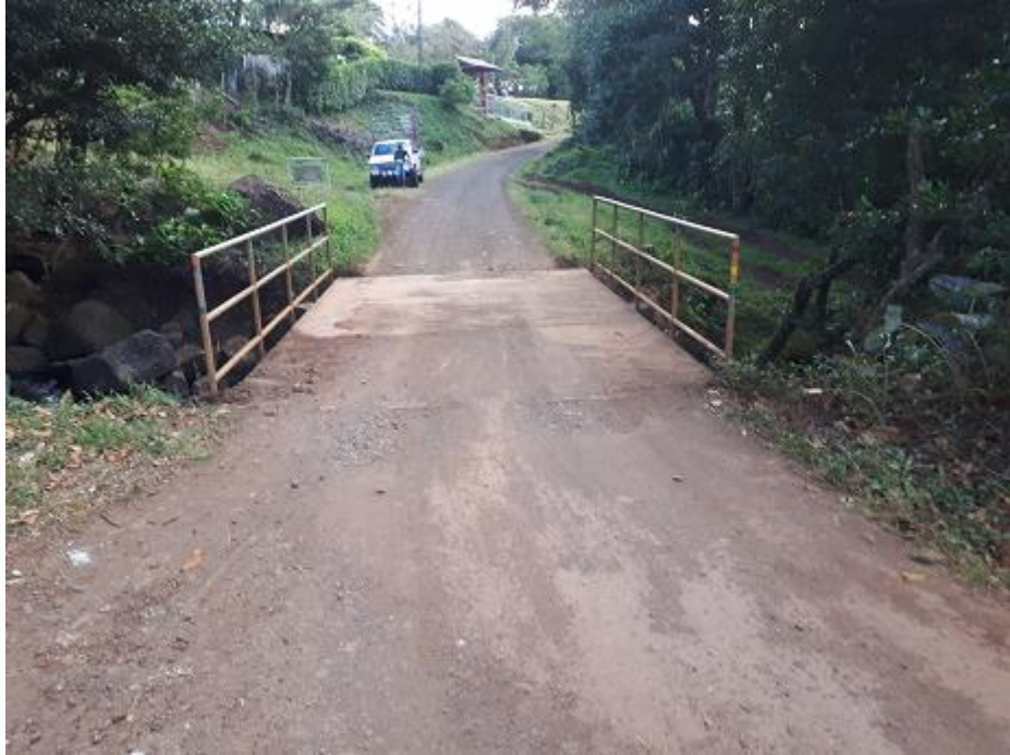
Figura 6. Ausencia de sistemas de drenaje o cunetas.
