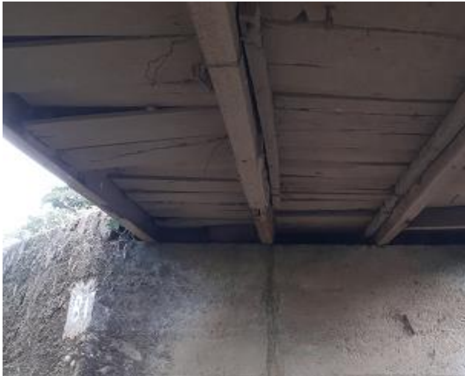
Figura 10. Formaleta sin remover en losa de concreto.
