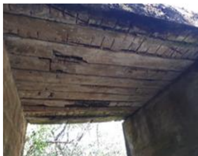
Figura 151. Superestructura de vigas de concreto reforzado con acero expuesto y con corrosión, algunas se encuentran fracturadas.
