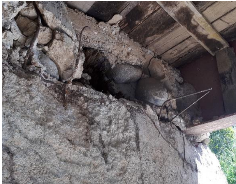
Figura 7. Viga cabezal destruida con acero de refuerzo expuesto y desprendimiento de agregado.
