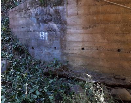
Figura 74. Bastión con socavación. Fuente: Elaboración propia.
