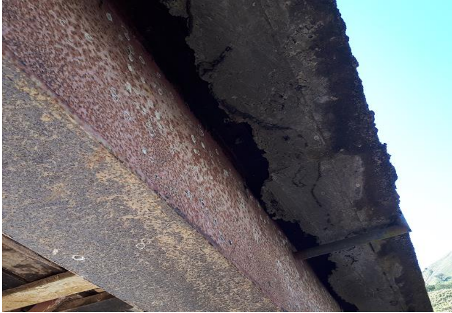
Figura 10. Vigas de acero principal con oxidación de más de 50% de su área y principios de corrosión.
