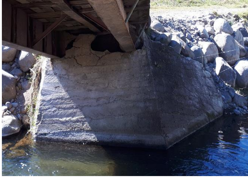
Figura 6. Bastión 1 con daños de grietas, nidos de piedra, inclinación, socavación y removido de su ubicación original.
