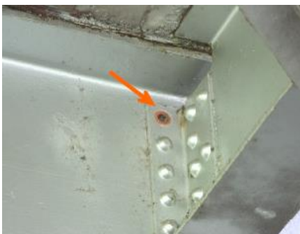
Figura 49. Pérdida de pernos en unión. Fuente: (MOPT, 2007).
