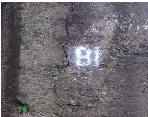
Figura 89. Aletón con nidos de piedra, grietas en una y dos direcciones, con socavación en su base. Fuente: Elaboración propia.
