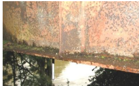
Figura 47. Oxidación en viga principal. Fuente: (MOPT, 2007).
