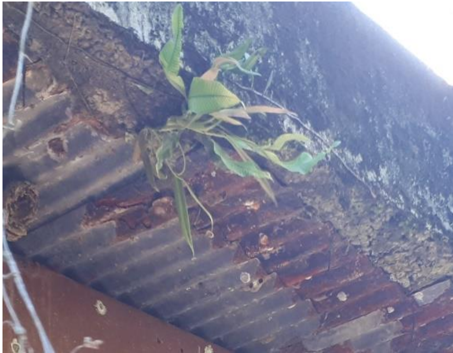
Figura 9. Nidos de piedra, filtración de agua y humedad en losa de concreto.
