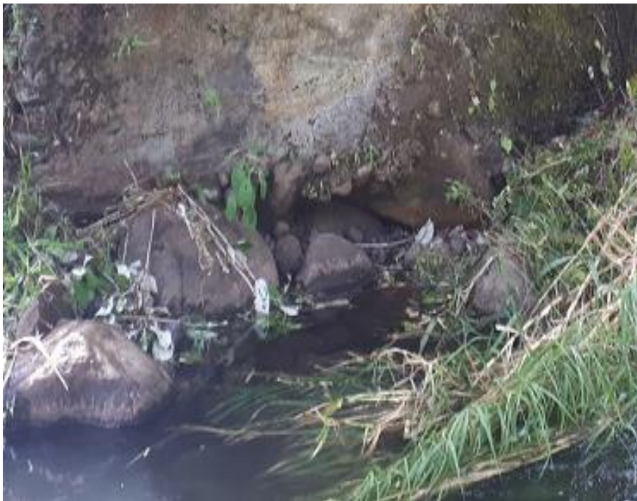
Figura 7. Principio de socavación en bastión.
