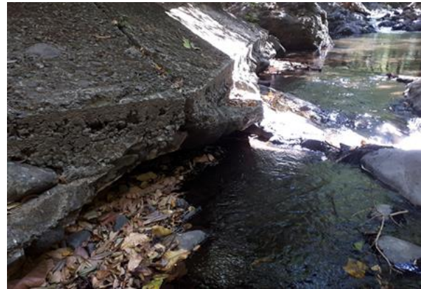
Figura 107. Se observa socavación de bastión y nidos de piedra. Fuente: Elaboración propia.
