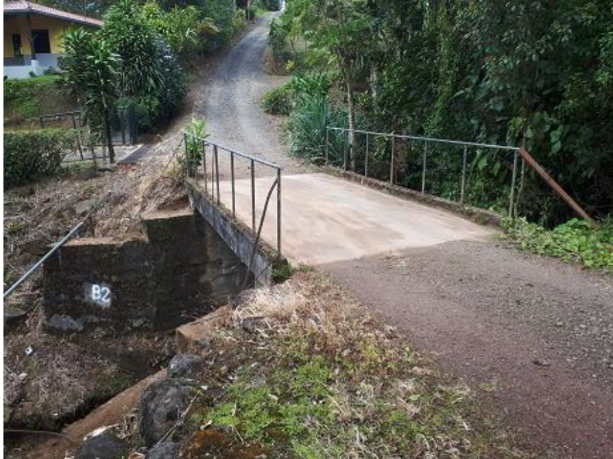
Figura 4. Barandas existentes en el puente La Palma no cumplen con la especificación para resistir un impacto vehicular.
