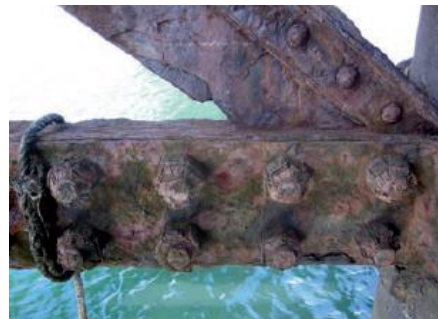
Figura 48. Corrosión en uniones. Fuente: (Ministerio de Fomento, 2012).
