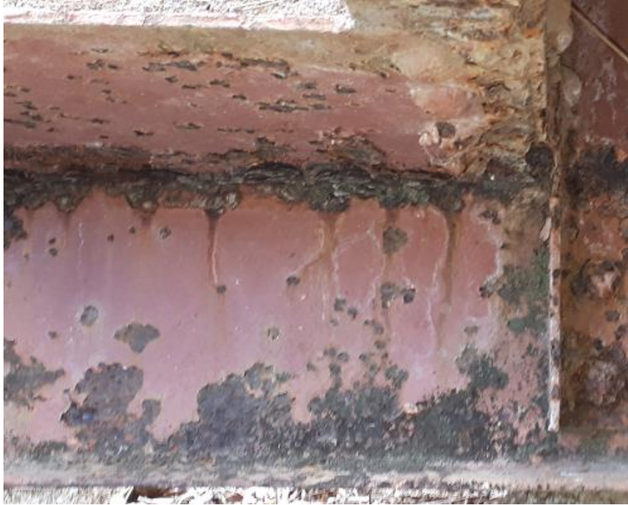
Figura 8. Oxidación y corrosión de vigas principales del puente San José.
