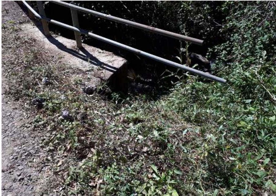
Figura 10. Pérdida de relleno en Aletón y faltante en baranda.
