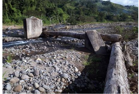
Figura 143. Bastiones y vigas de madera del puente anterior que fue dañado por un aumento de caudal del río Chiquito. Fuente: Elaboración propia.
