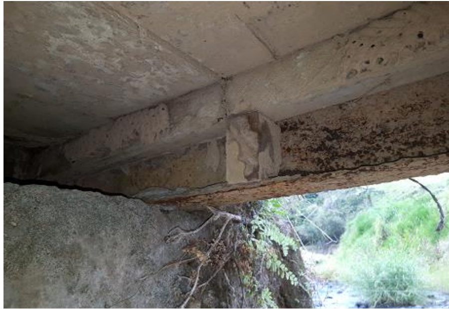
Figura 8. Oxidación en viga tipo chasis.
