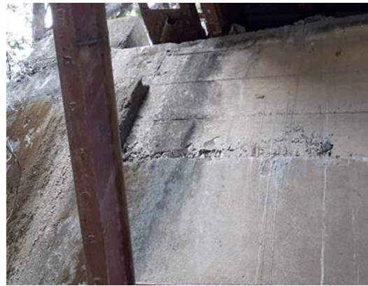
Figura 125. Se observa viga cabezal con nidos de piedra y filtración de aguas desde la junta expansiva abierta. Fuente: Elaboración propia.
