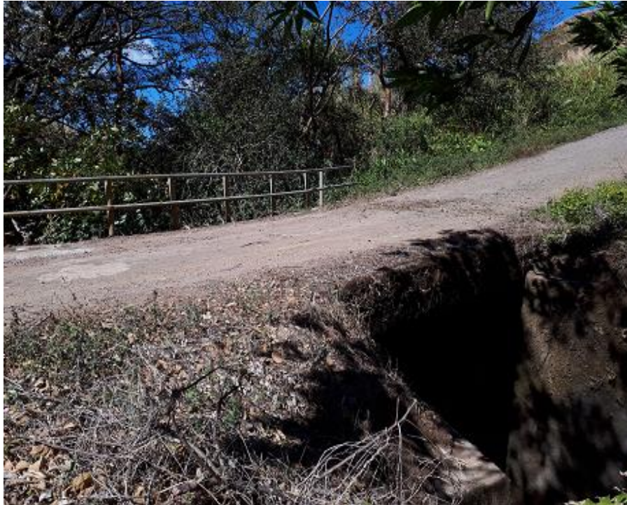
Figura 4. Faltante de barandas en puente Las Vueltas.
