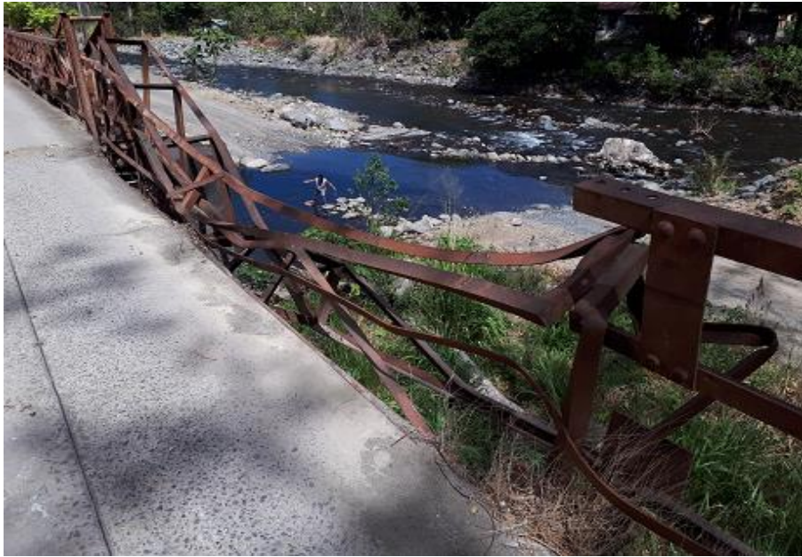
Figura 4. Barandas afectadas por la caída de un árbol en puente San José.
