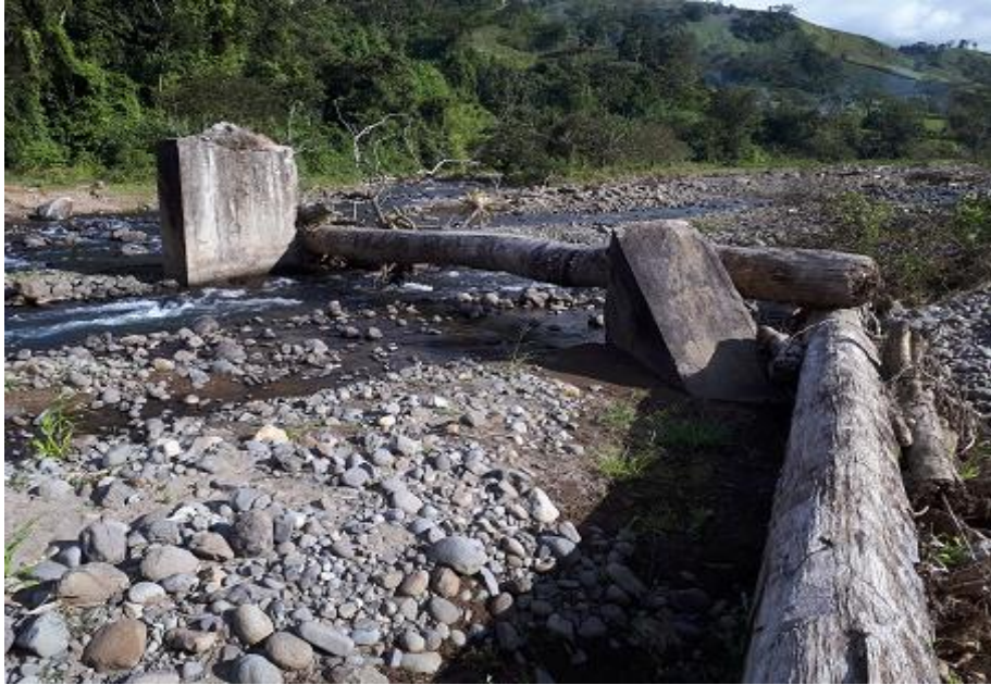
Figura 10. Bastiones de concreto y vigas de madera del puente anterior que se encuentran aguas arriba y pueden ser objeto de un potencial de bloqueo.
