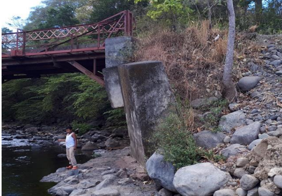
Figura 10. Notable inclinación del bastión 2 y su Aletón aguas abajo.
