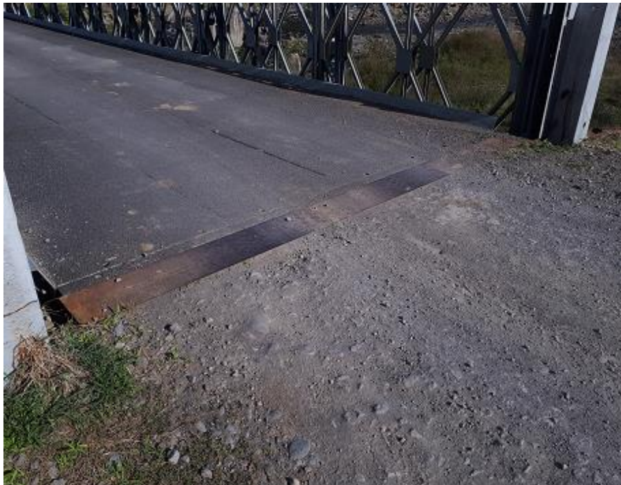
Figura 7. Se observa junta de expansión abierta construida con placa de acero.
