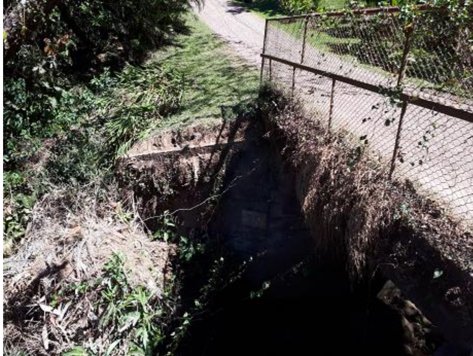
Figura 6. Ausencia de sistemas de drenaje o cunetas.
