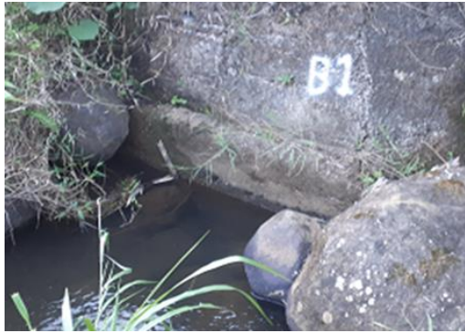
Figura 61. Se observan principios de socavación en el aletón de aguas arriba. Fuente: Elaboración propia.
