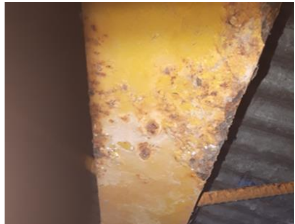
Figura 69. Vigas principales de acero con corrosión avanzada. Fuente: Elaboración propia.
