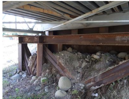
Figura 139. Material depositado en el sistema de pilotes que no fue removido. Fuente: Elaboración propia.
