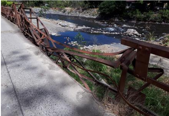
Figura 122. Baranda deformada por caída de árbol sobre el costado del puente. Fuente: Elaboración propia.
