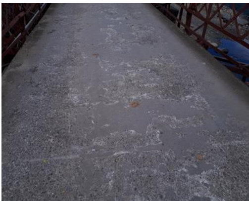
Figura 123. Descascaramiento de losa de concreto considerable en el tramo II. Fuente: Elaboración propia.
