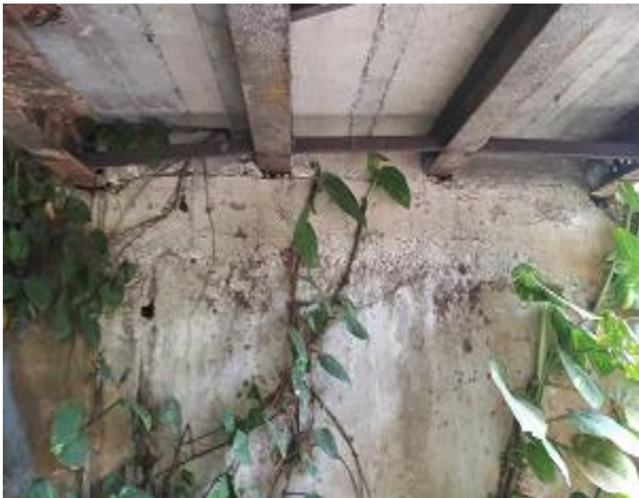
Figura 9. Nidos de piedra, filtración de agua y junta de construcción en cuerpo del bastión.
