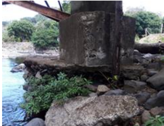
Figura 148. Socavación de pila donde se observa la fundación. Fuente: Elaboración propia.
