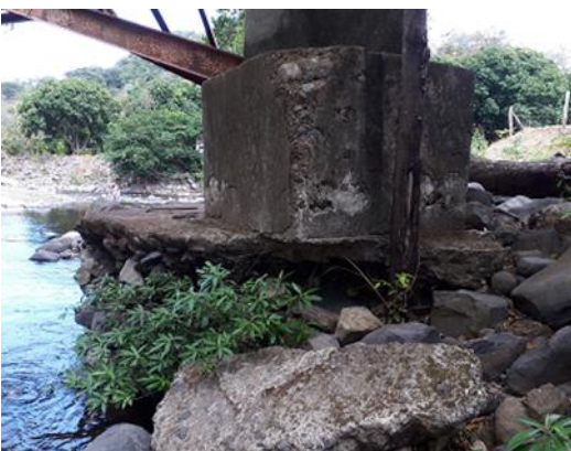
Figura 129. Se observa socavación de la cimentación de la pila P1, daño severo que compromete la seguridad estructural. Fuente: Elaboración propia.
