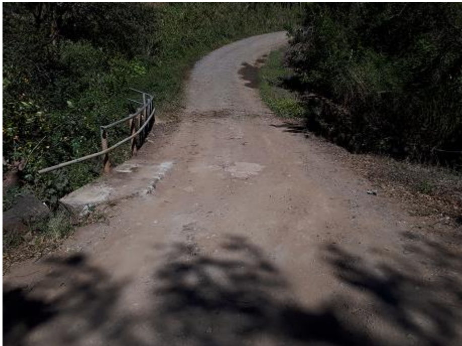
Figura 5. Señalización vertical, guardavías inexistentes.
