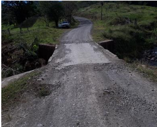
Figura 88. Falta de señalización y guarda vías. Fuente: Elaboración propia.
