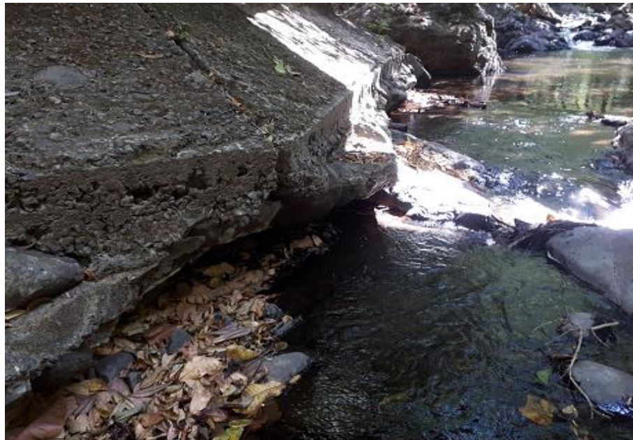
Figura 5. Se observa socavación en el bastión del puente Maravilla.
