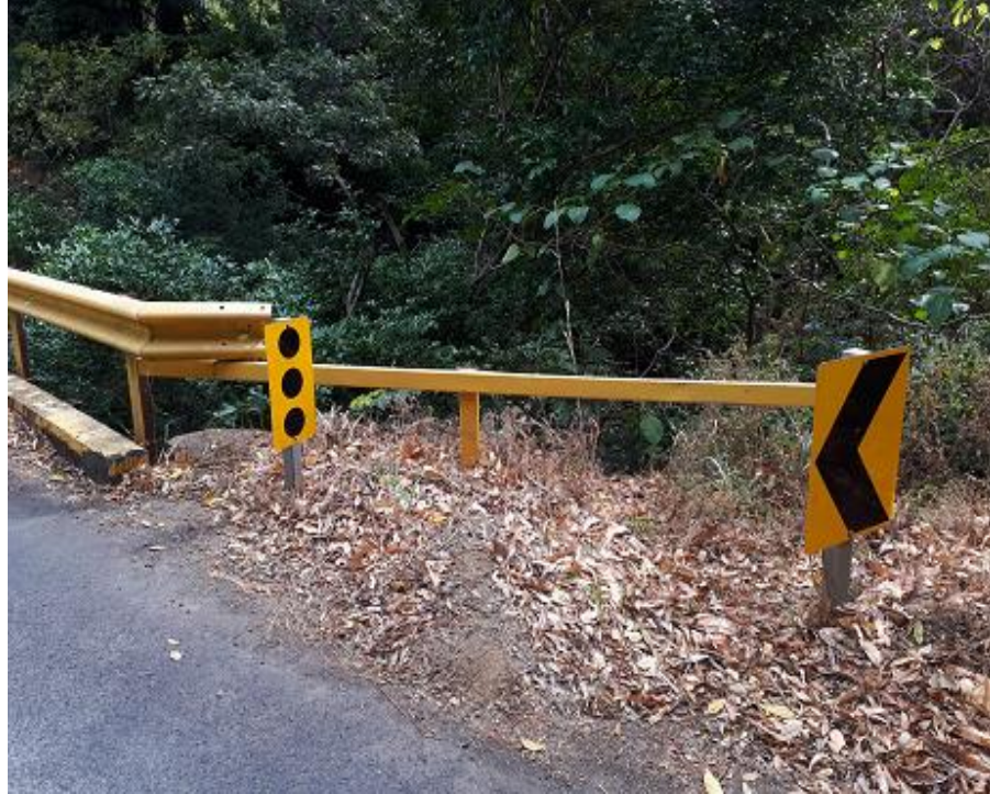
Figura 4. Los guarda vías no cumplen los requerimientos de seguridad vial para retención de impacto de vehículos en el puente Maravilla.
