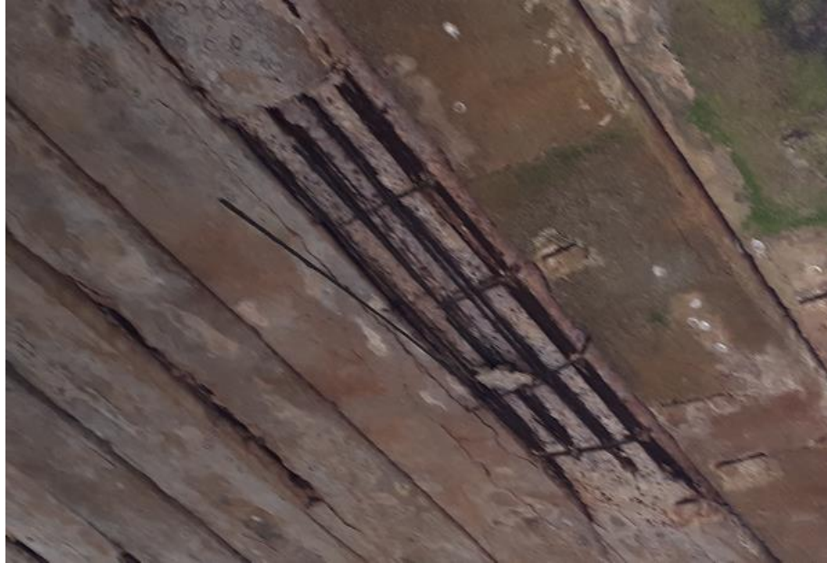
Figura 8. Corrosión en acero de refuerzo de vigas principales.
