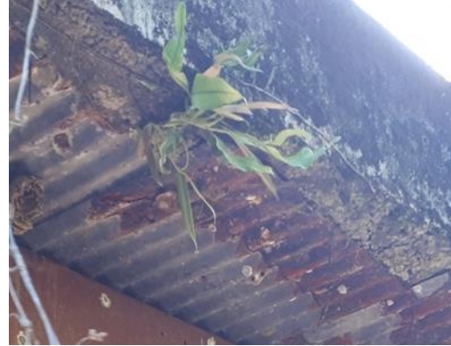
Figura 99. Nidos de piedra, eflorescencia y humedad en los extremos de la losa de concreto. Fuente: Elaboración propia.
