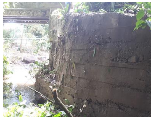
Figura 82 Aletón con nidos de piedra y juntas de construcción. Fuente: Elaboración propia.
