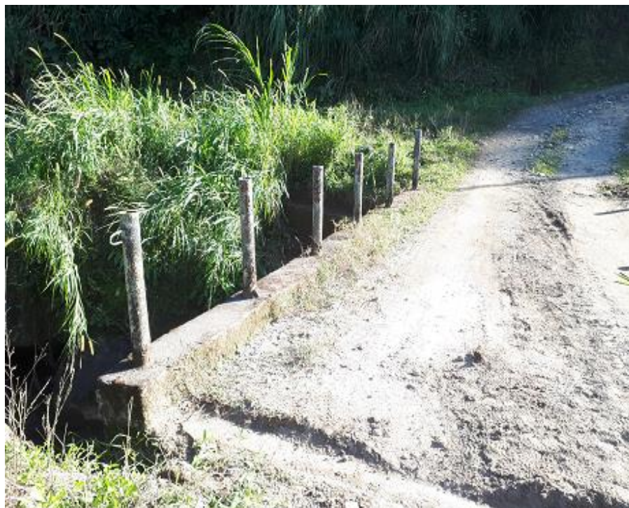
Figura 4. Barandas inexistentes en el puente Las Pavas.
