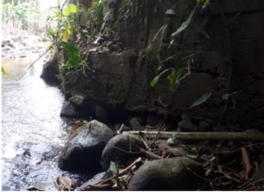
Figura 83. Cimentación con socavación y nidos de piedra. Fuente: Elaboración propia.
