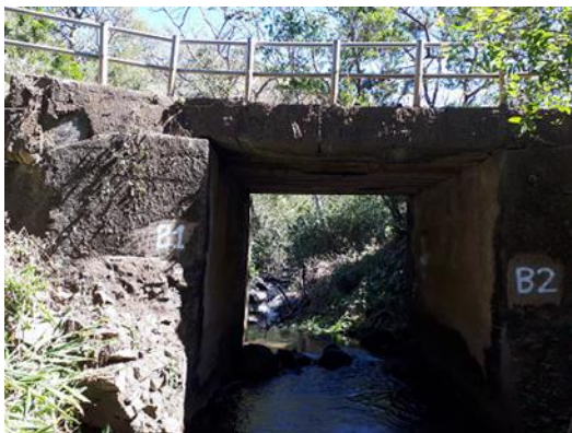
Figura 102. Bastión 1 con inclinación notable. Fuente: Elaboración propia.
