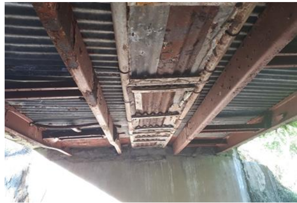
Figura 94. Existencia de formaleta en la sección inferior de la losa. Fuente: Elaboración propia.
