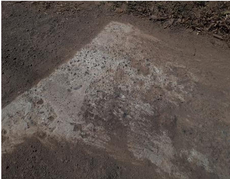
Figura 9. Losa de concreto con desgaste.
