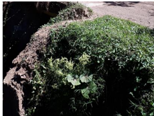
Figura 78. Drenaje de desvío de aguas sobre el aletón provoca el colapso parcial del relleno detrás del mismo. Fuente: Elaboración propia.
