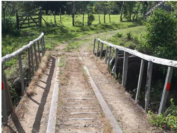
Figura 114. Barandas de madera que no cumplen con la resistencia para retener el impacto de un vehículo con seguridad.
