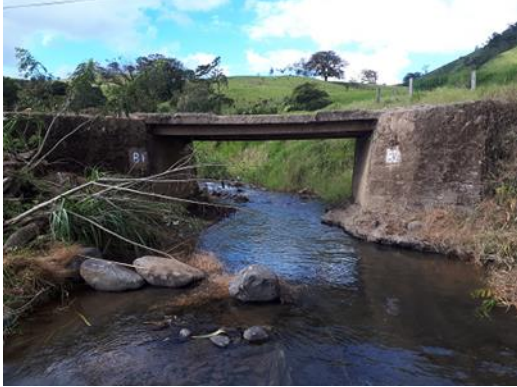
Figura 87. Puente sin barandas para evitar la caída de vehículos al cauce. Fuente: Elaboración propia.
