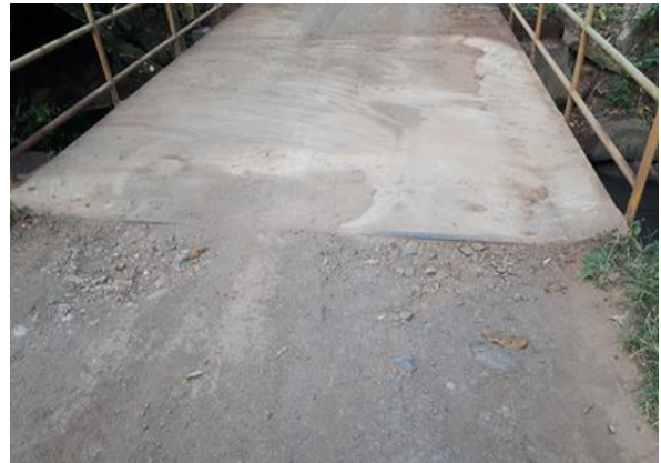
Figura 68. Existen deformaciones en los accesos que permiten el empozamiento de agua que filtran por la junta abierta. Fuente: Elaboración propia.
