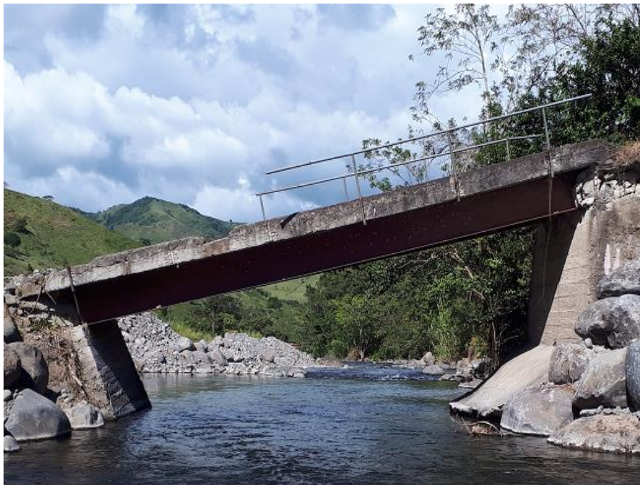
Figura 5. Se visualiza la pronunciada pendiente longitudinal en el puente San Pedro.
