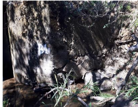
Figura 104. Aletón con nidos de piedra, socavación y grietas en ambas direcciones. Fuente: Elaboración propia.
