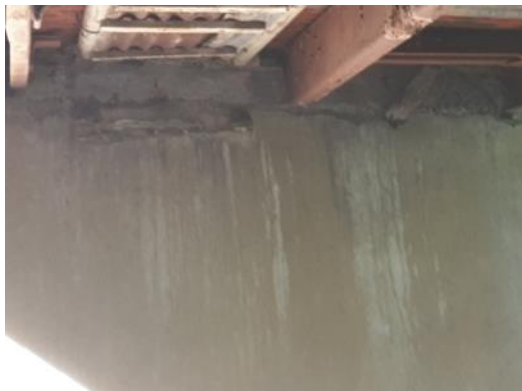
Figura 98. Eflorescencia y filtración de aguas en viga cabezal por junta abierta. Fuente: Elaboración propia.
