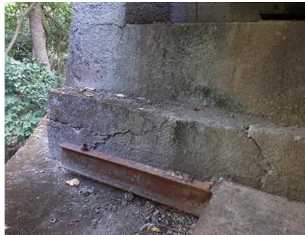
Figura 108. Viga cabezal que sirve de base a los asientos de la superestructura nueva con agrietamiento notable. Fuente: Elaboración propia.
