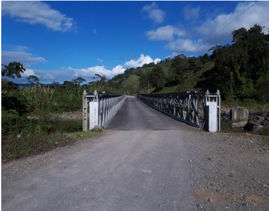
Figura 4. No existen guarda vías en los accesos, rótulos de prevención o restricción de carga.
