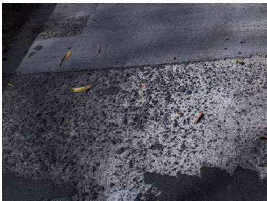
Figura 111. Desgaste en losa de concreto con exposición de agregado. Fuente: Elaboración propia.
