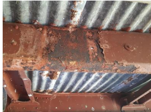
Figura 93. Estado de superestructura de puente Las Pavas. Fuente: Elaboración propia.
