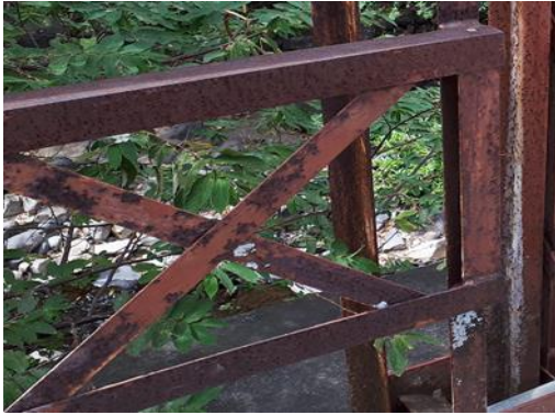
Figura 121. Oxidación en baranda y principios de corrosión. Fuente: Elaboración propia.
