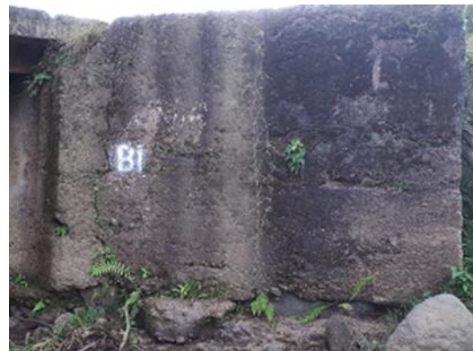
Figura 92. Aletón fracturado con una grieta considerable. Fuente: Elaboración propia.
