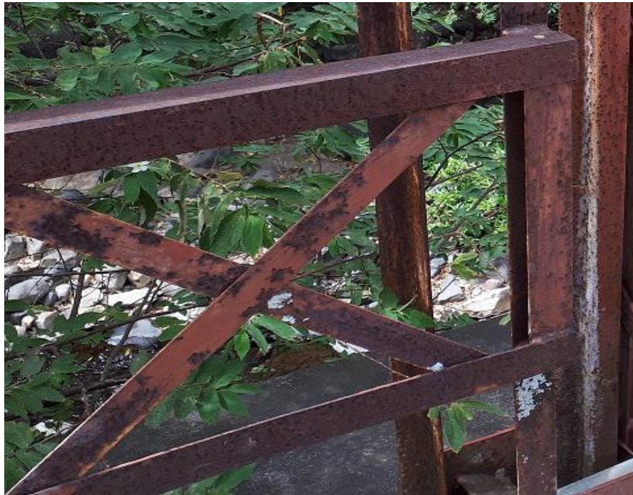
Figura 7. Oxidación avanzada en barandas de puente San José.
