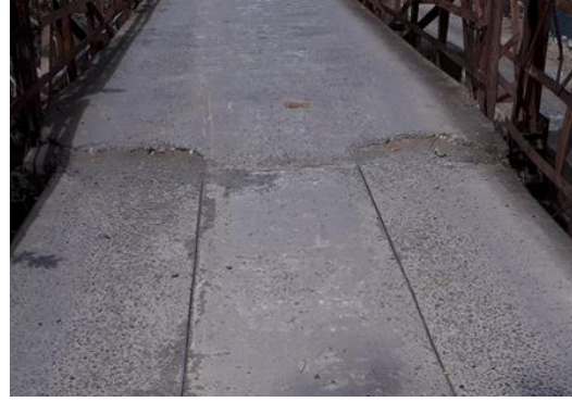
Figura 124. Se observa una diferencia de espesores entre el Tramo I y el Tramo II en la losa de concreto de 8 cm (tope). Fuente: Elaboración propia.
