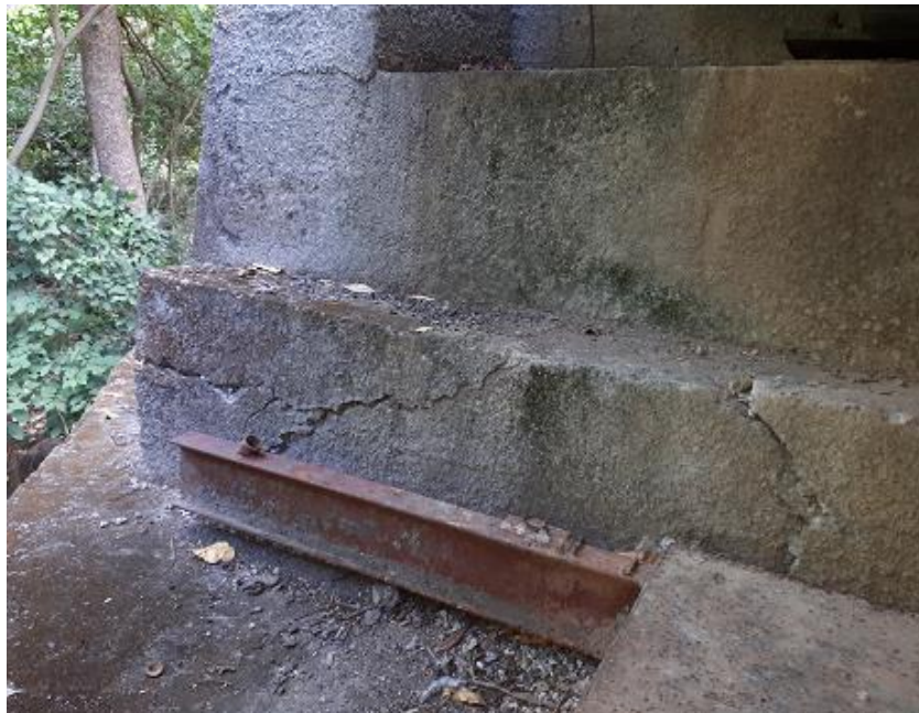
Figura 9. Viga cabezal del puente anterior que sirve de soporte a la estructura nueva, esta agrietada.
