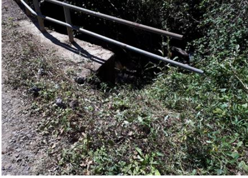
Figura 106. Pérdida de talud en aletón, faltante de baranda. Fuente: Elaboración propia.
