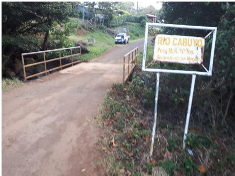
Figura 5. Señalización vertical, guardavías inexistentes y rótulo de identificación en mal estado.
