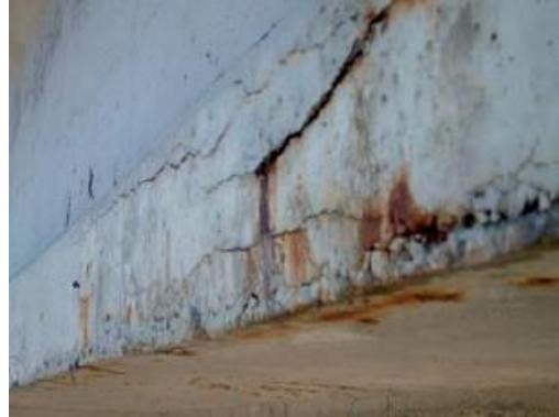
Figura 43. Efecto del descascaramiento. Fuente: (Ministerio de Fomento, 2012).
