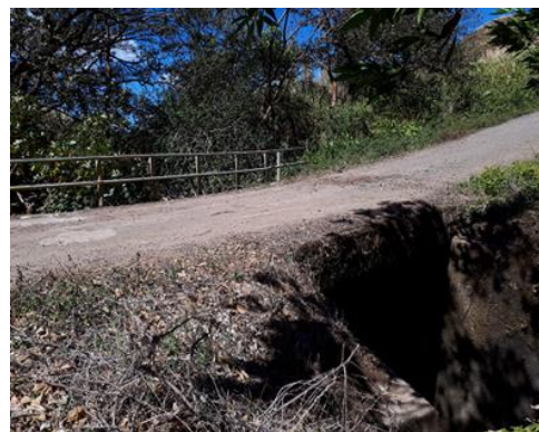
Figura 105. Falta de barandas y guarda vías. Fuente: Elaboración propia.
