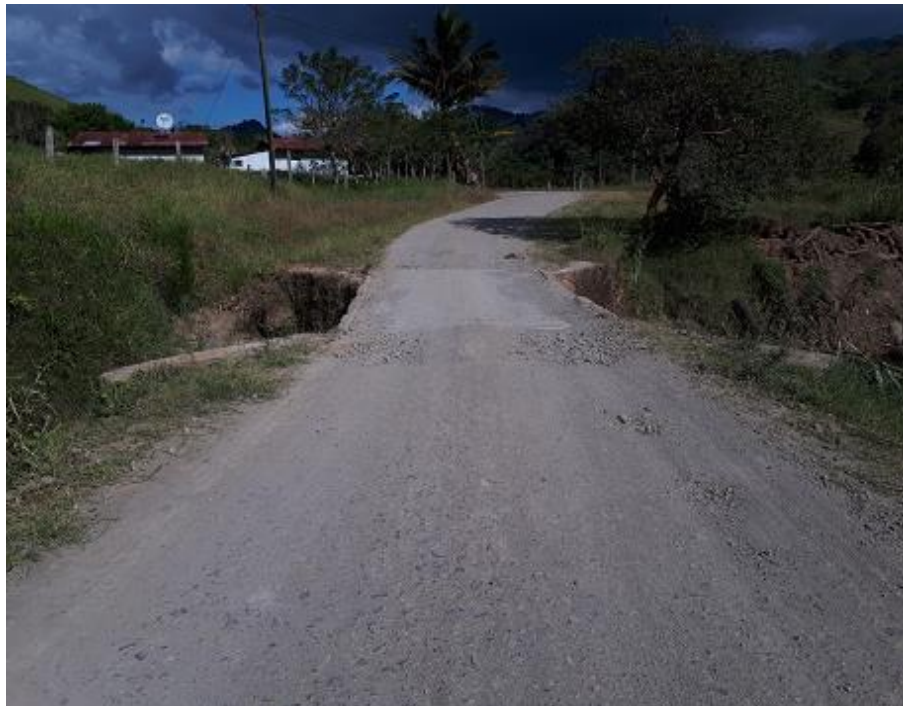
Figura 5. Señalización vertical, guardavías inexistentes.
