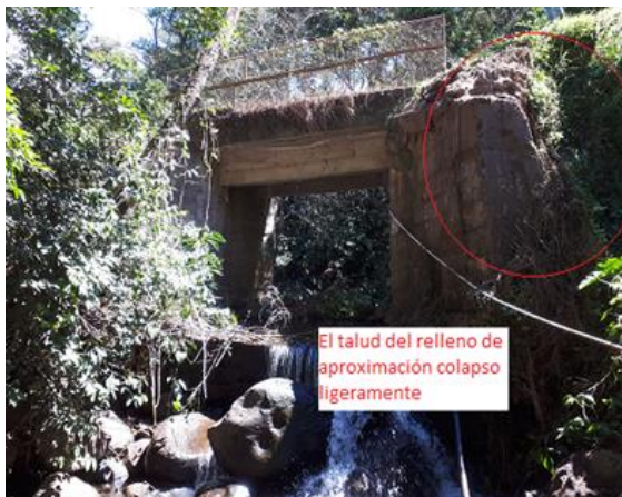
Figura 76. El relleno de aproximación colapso ligeramente. Fuente: Elaboración propia.
