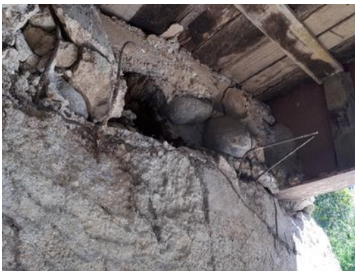
Figura 132. Viga cabezal con acero expuesto y destrucción de la estructura de concreto.
