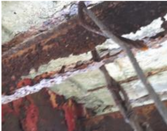
Figura 155. Arriostre de acero dañado por corrosión avanzada Fuente: Elaboración propia.
