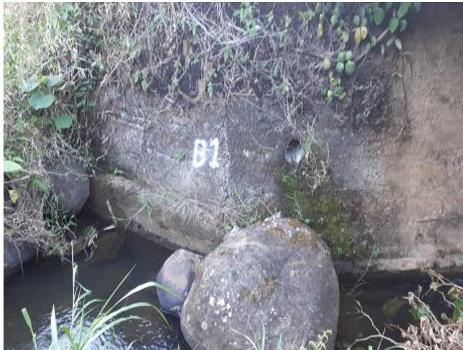
Figura 11. Aletón observado con principio de socavación.
