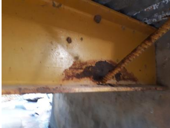
Figura 66. Oxidación de las conexiones soldadas y los arriostres. Fuente: Elaboración propia.
