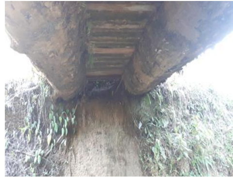
Figura 64. Falta de limpieza en los bastiones y los aletones. Fuente: Elaboración propia.
