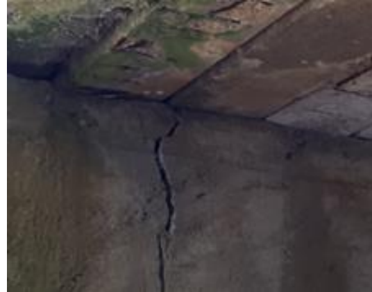
Figura 152. Bastión 1 con una grieta vertical de abertura mayor a 15 mm.
