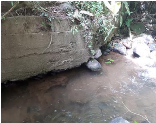
Figura 79. Socavación en los bastiones del puente. Fuente: Elaboración propia.
