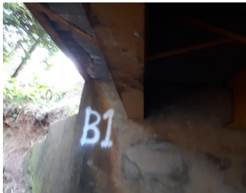
Figura 71. Se observa eflorescencia en la pared de los bastiones.
