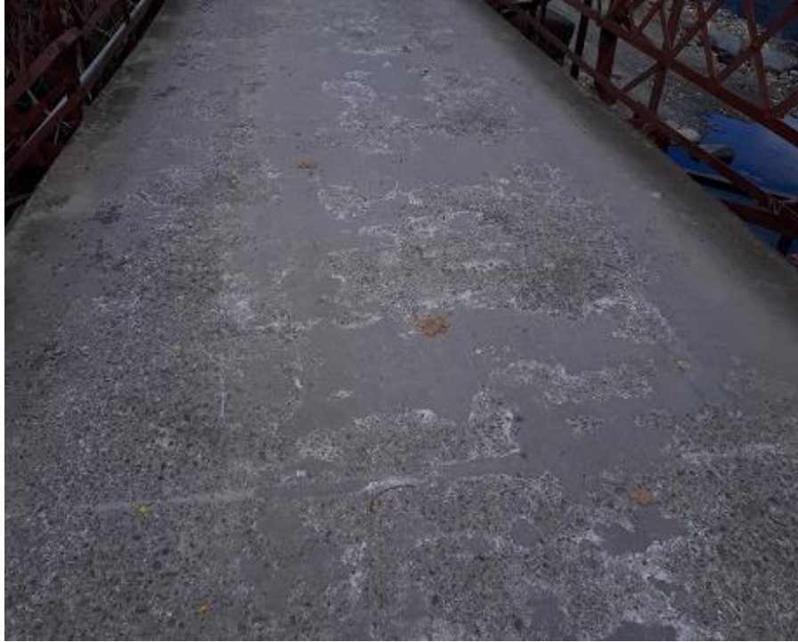
Figura 6. Losa de concreto del Tramo II con un considerable descascaramiento. .
