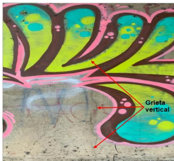
Figura 16 Grieta en la Subestructura, Bastión 2. Fuente:(Salazar, s.f.)
