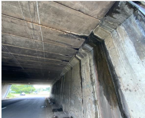
Figura 15. Eflorescencia en la pila y viga-losa. Fuente: (Salazar, s.f.)
