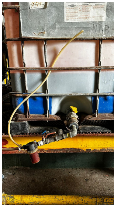
Figura 4.4: Posición de la válvula en la tanqueta de aditivo.
