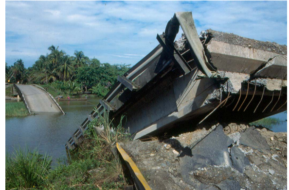
Figura 1.5. Efectos de licuefacción de suelos por el terremoto de Limón en 1991. Fuente: (Castro, 1991).
