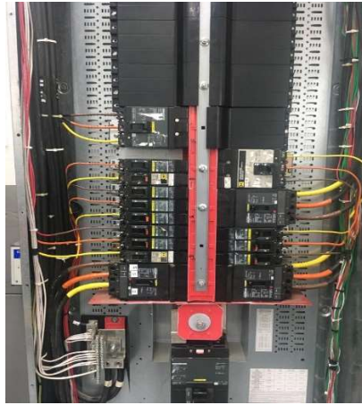
Ilustración 10. Tablero de carga identificado
