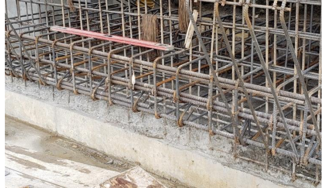
Fotografía 41. Traslapes longitudinales sin alternar.
