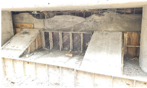
Fotografía 35. Problemas en colado de Bastión 1 (b).
