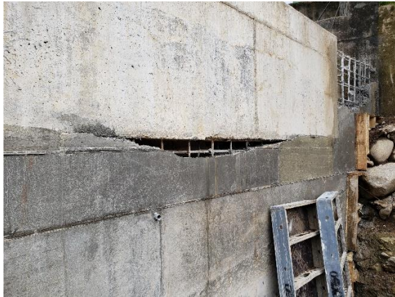
Fotografía 34. Problemas en colado de Bastión 1 (a).
