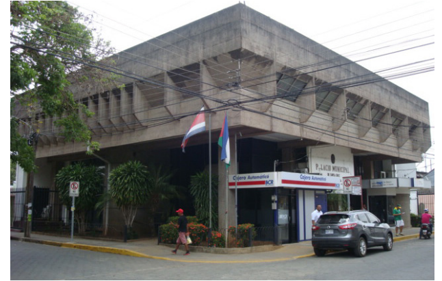
Fuente:Propia _Edificio Municipal (daños)
