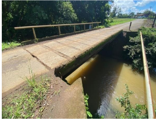
Figura 10. Deterioro en la junta de expansión de estructura de puente.
