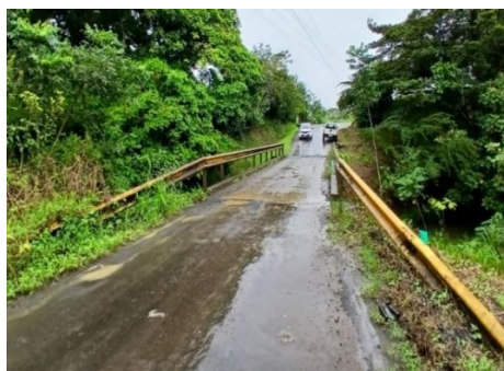
Figura 20. Huecos en la entrada de la estructura de Puente Quebrada Sahíno, estacionamiento (0+500).
