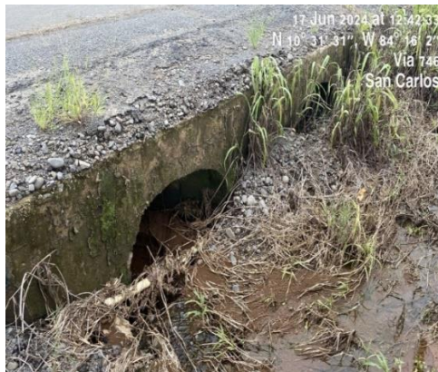
Figura 12. Tubería parcialmente obstruida (est 4+230).
