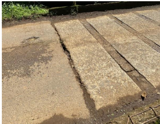
Figura 11. Detalle del deterioro en la junta de expansión del puente.
