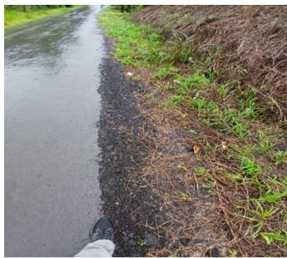
Figura 23. Agrietamiento de borde. Estacionamiento (0+145).
