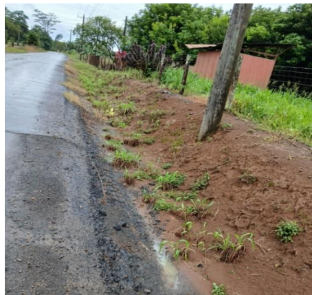
Figura 14. Ausencia de conformación de cunetas a lo largo de la ruta.
