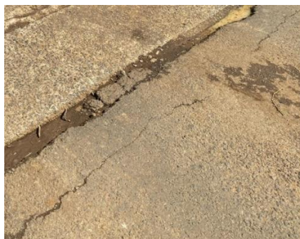
Figura 21. Agrietamiento transversal presente en la ruta, estacionamiento (4+800).
