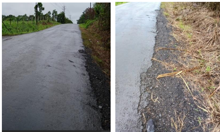
Figura 24 y 25. Agrietamiento de borde presente en la ruta, estacionamiento (0+800); y estacionamiento (1+250) respectivamente.
