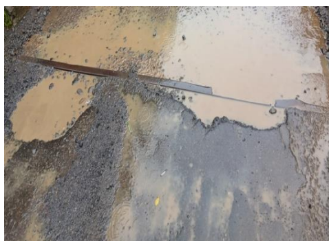
Figura 19. Huecos en la Ruta Nacional No. 746, estacionamiento (0+500).
