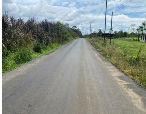
Figura 18. Ausencia de demarcación horizontal o límites de velocidad.
