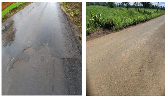
Figura 27 y 28. Desprendimiento en la ruta, estacionamiento (3+360); y estacionamiento (3+900) respectivamente.
