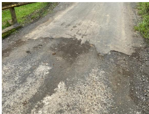
Figura 9. Desprendimiento en aproximación de estructura de puente.
