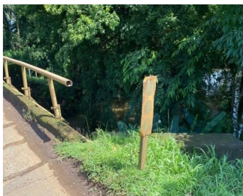
Figura 15. Ausencia de elementos de barandas y visibilidad en los accesos de aproximación al puente. (est 4+800).
