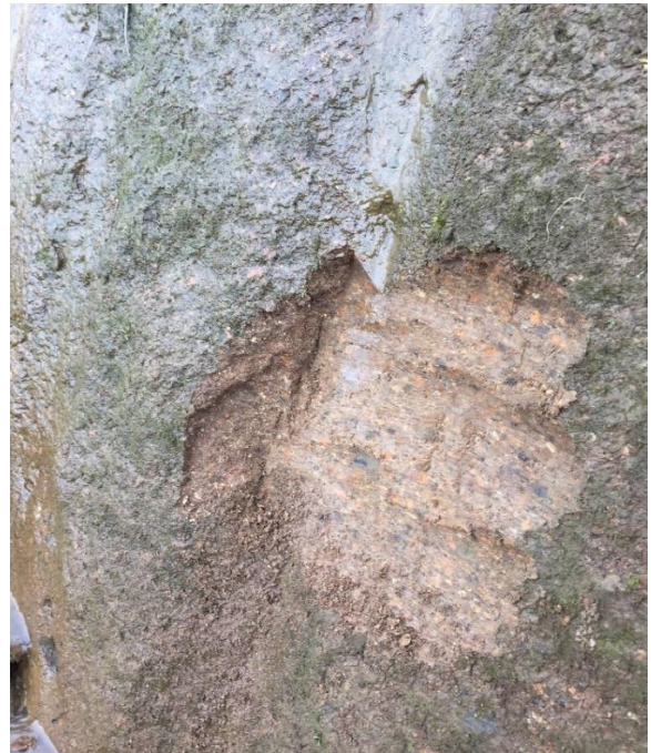
Figura 33. Condiciones de humedad y evidencia de flujos de agua en km 36+136. Visita a sitio (2018).
