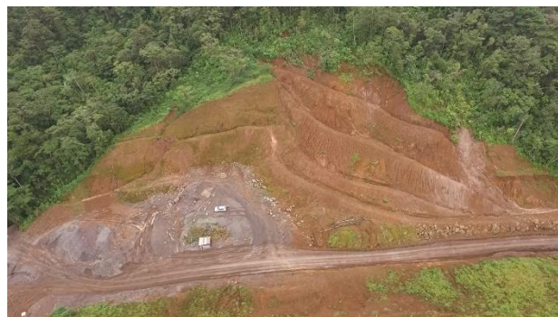
Figura 20. Imagen aérea, inestabilidad en estación km 30+700. Asesorías Geotec S.A. 2017.
