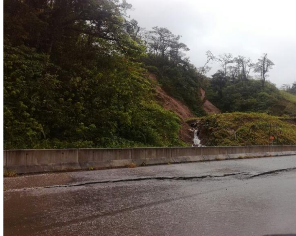
Figura 2. Grietas en vía. Fuente: Visita sitio 17 de enero, 2018.
