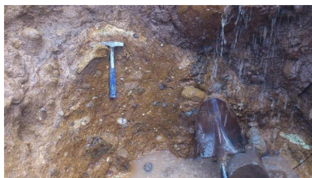
Figura 21. Evidencia de flujos de agua. Asesorías Geotec S.A. 2017.
