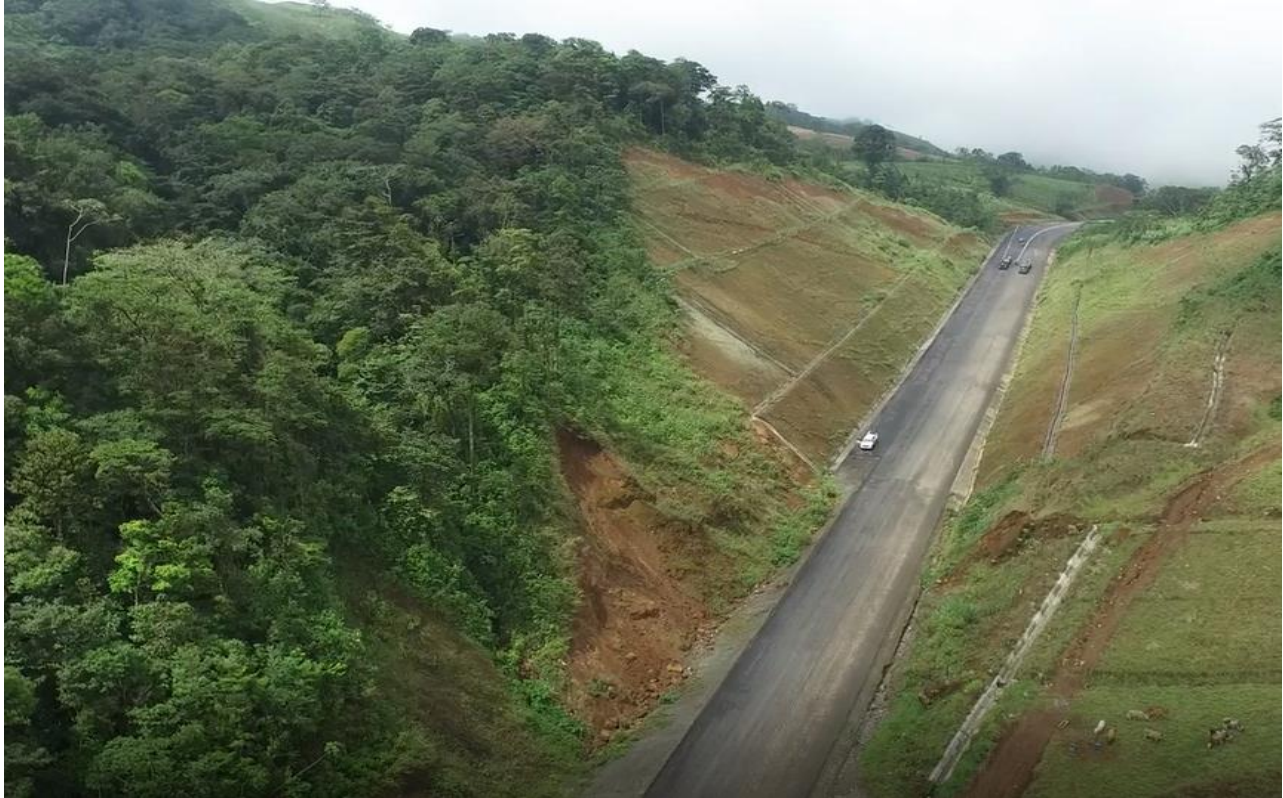
Figura 56. Zona crítica, estación 36+130 Fuente: Asesorías GEOTEC.
