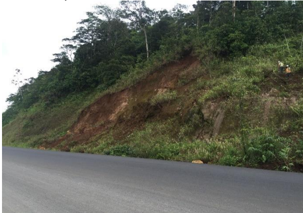
Figura 31. Deslizamiento estacionamiento 36+130. Asesorías Geotec (2017).
