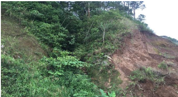
Figura 32. Condiciones de inestabilidad en km 36+136. Asesorías Geotec S.A. (2017).
