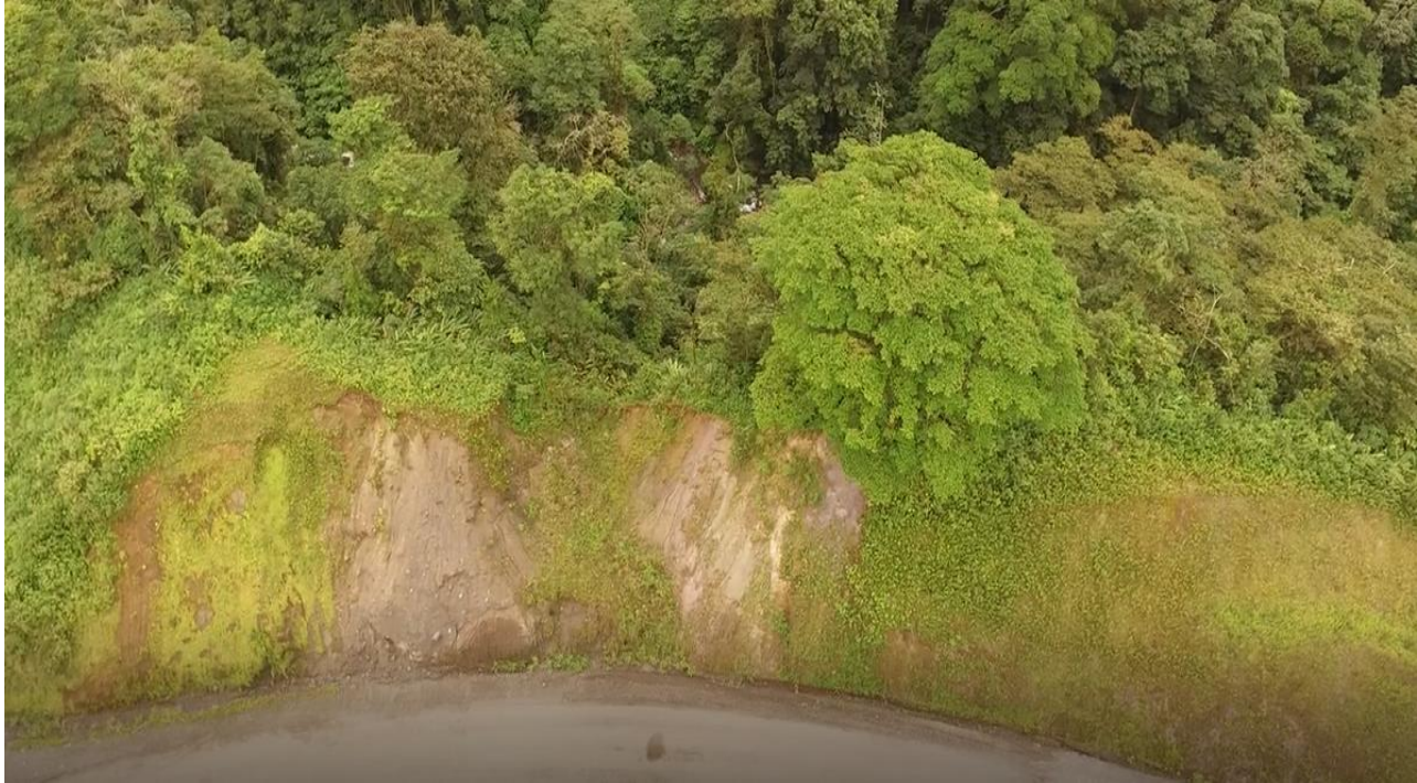
Figura 50. Zona crítica, estación 21+640 Fuente: Asesorías GEOTEC.
