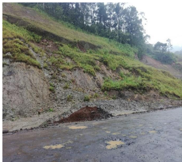
Figura 22. Deslizamiento estacionamiento 30+700 km. Asesorías Geotec S.A. 2018.
