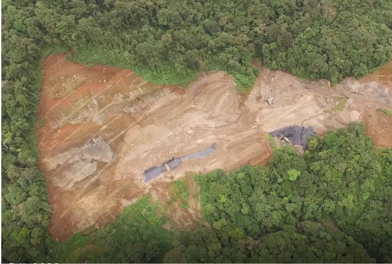
Figura 53. Zona crítica, estación 31+100 Fuente: Asesorías GEOTEC.
