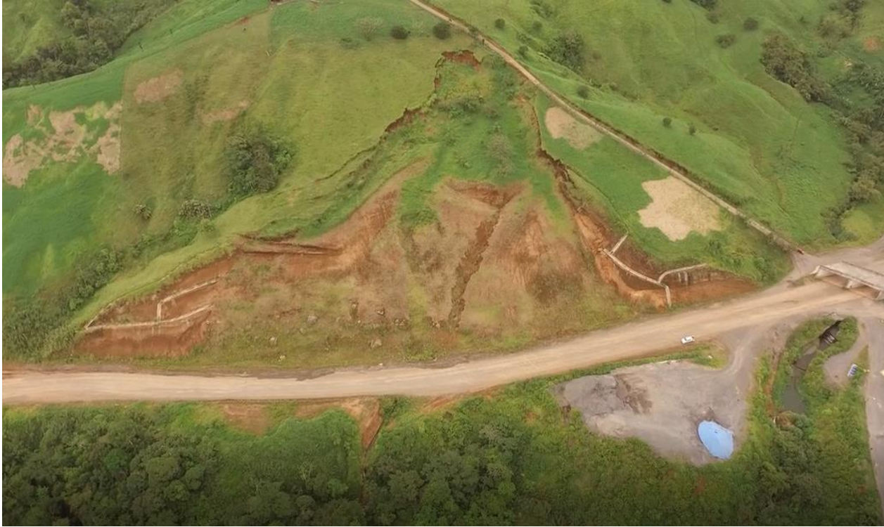
Figura 51. Zona crítica, estación 29+100 Fuente: Asesorías GEOTEC.
