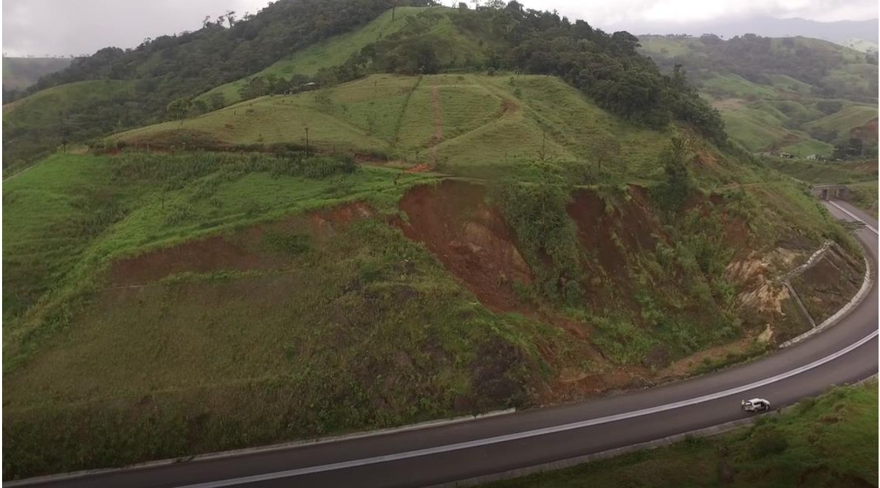
Figura 54 . Zona crítica, estación 33+800 Fuente: Asesorías GEOTEC.
