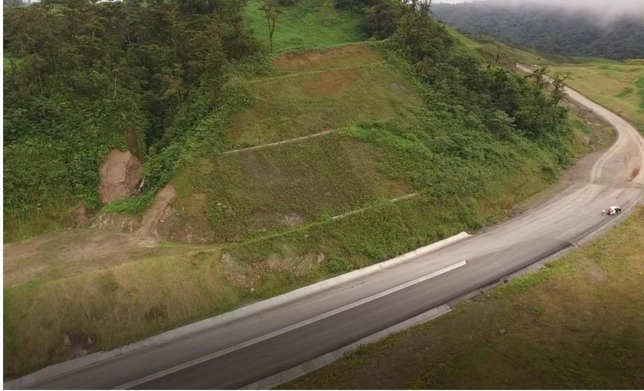
Figura 49. Zona crítica, estación 21+050 Fuente: Asesorías GEOTEC.
