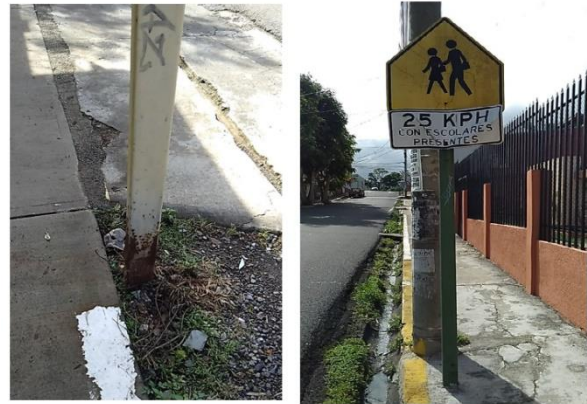
Figura 121. Señales con problemas físicos. Fuente. Elaboración propia.
