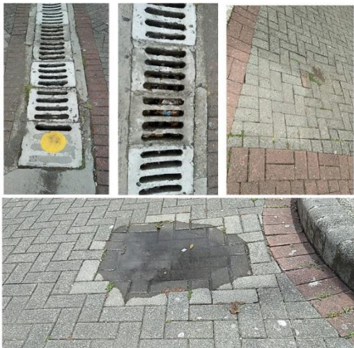
Figura 117. Depresiones y caños en mal estado. Fuente. Elaboración propia.
