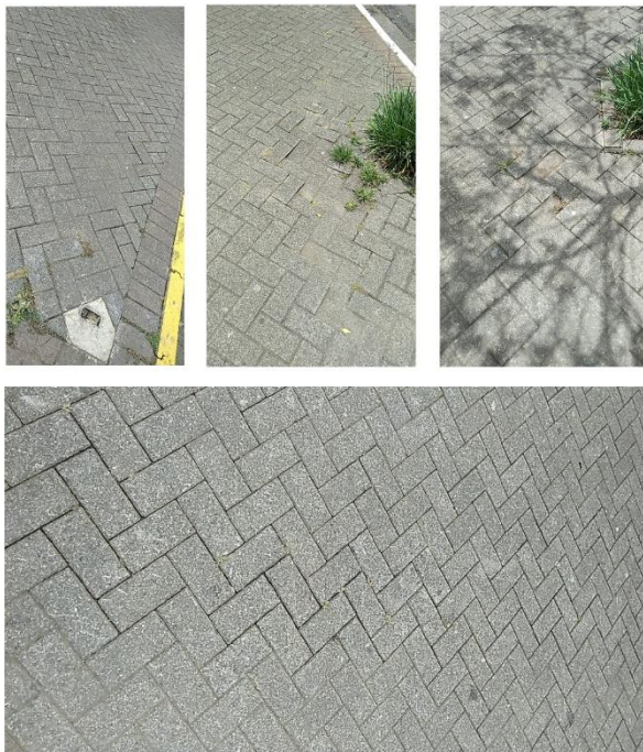
Figura 110. Depresiones y pérdida de arena. Fuente. Elaboración propia.
