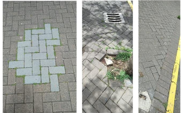
Figura 111. Bacheo, confinamiento y escalonamiento. Fuente. Elaboración propia.
