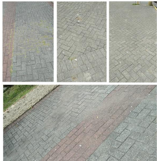
Figura 115. Pérdida de arena y depresiones. Fuente. Elaboración propia.
