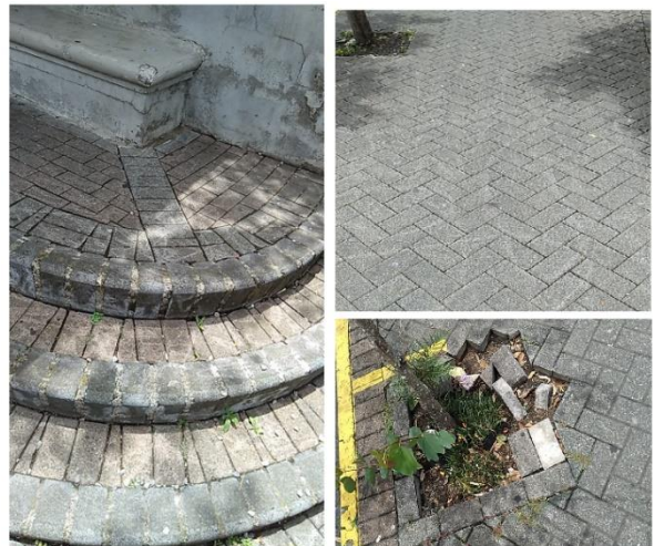
Figura 112. Pérdida de arena. Fuente. Elaboración propia.
