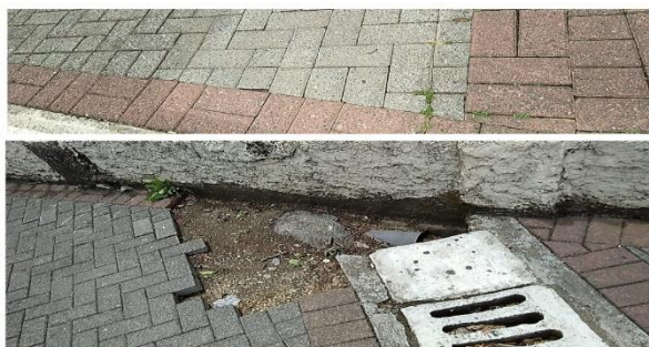
Figura 118. Pérdida de adoquines y arena. Fuente. Elaboración propia.
