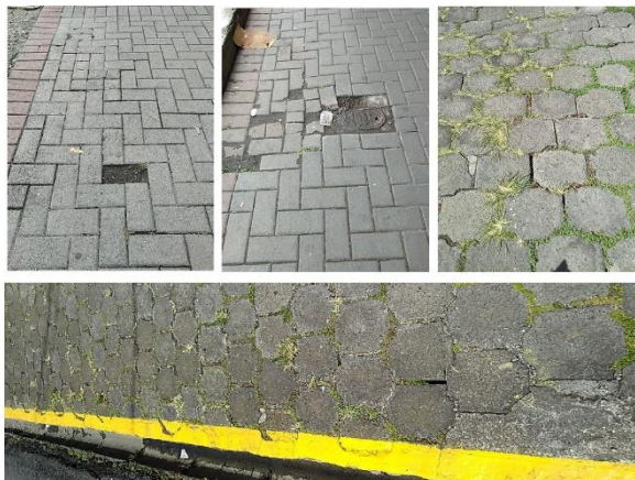
Figura 106. Depresiones y pérdida de adoquín. Fuente. Elaboración propia.
