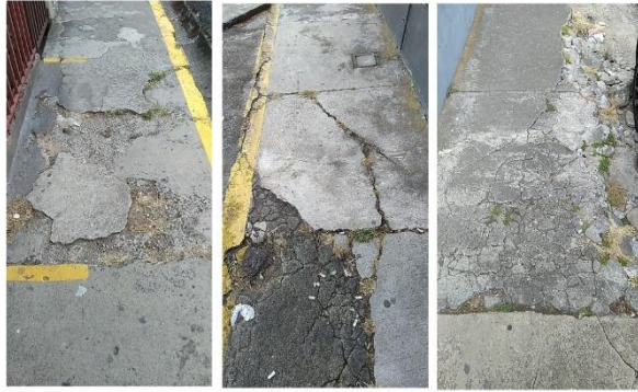
Figura 105. Desnudamiento, huecos y grietas. Fuente. Elaboración propia.
