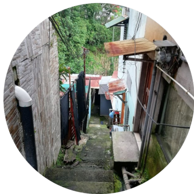
Viviendas en mal estado
