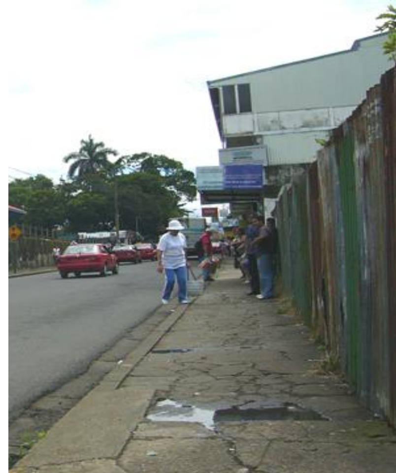
Figura N°25. Acera en mal estado.
